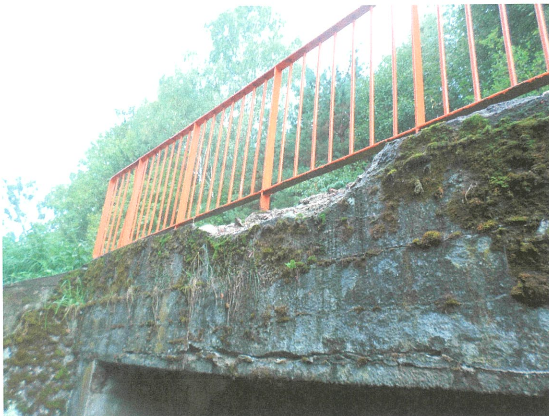
Fot. 4 . Pęknięcie płyty pomostowej, przecieki wody, wyługowania.
