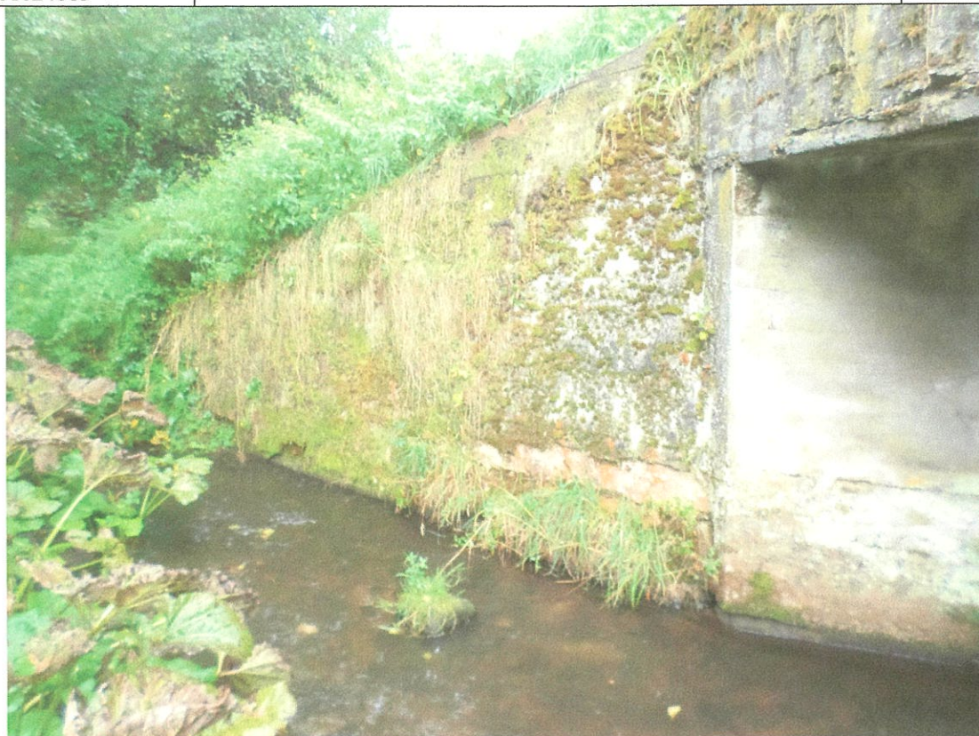
Fot. 3 . Erozja betonu skrzydła prawobrzeżnego, wegetacja roślin, wykwyty wody na ścianie przyczółka.
