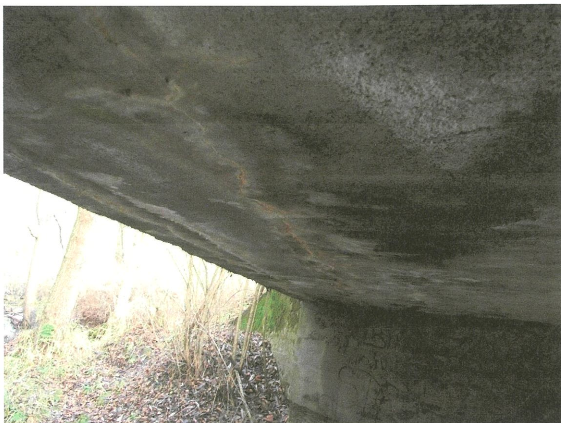
Fot. 1 . Płyta pomostowa, zarysowania, przecieki wody wyługowania.
