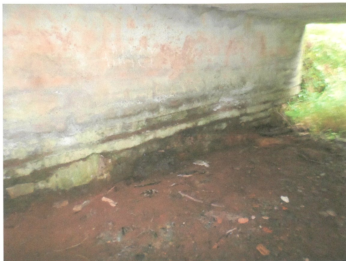
Fot. 2 . Erozja betonowego przyczółka lewobrzeżnego w linii wody, erozja i ubytki betonu.
