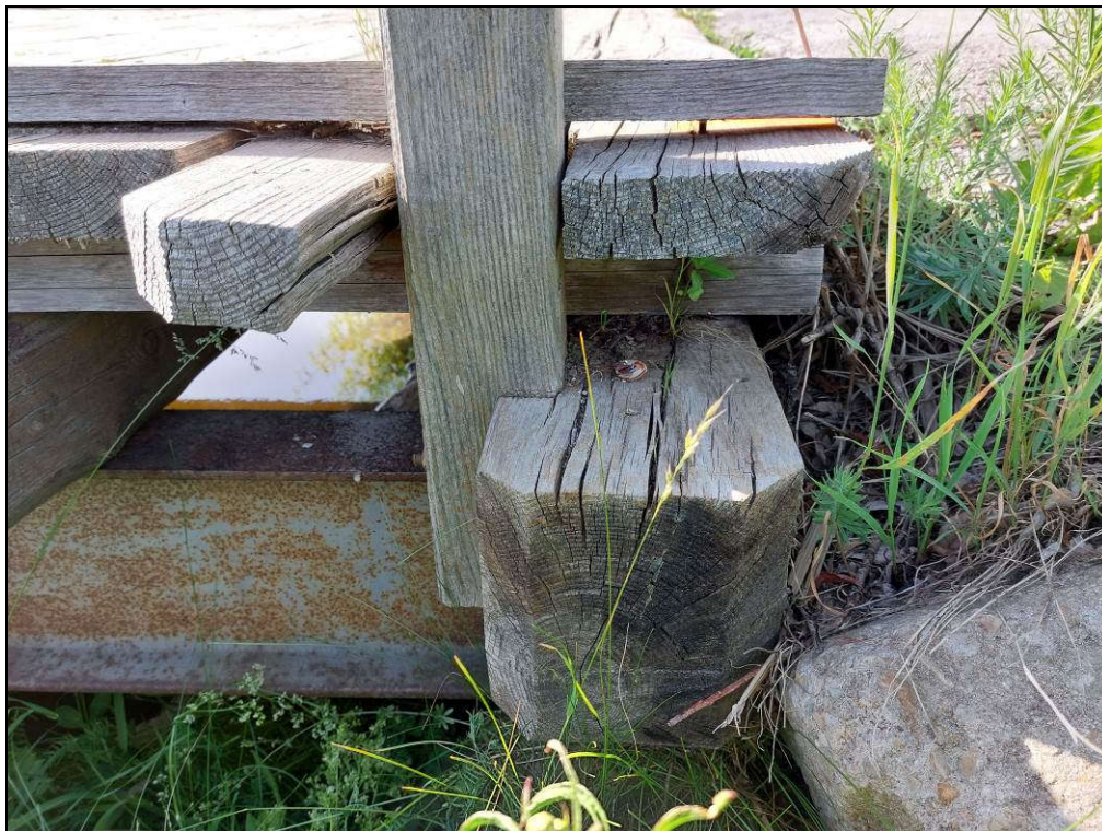
Fot. 15. Widok spodu ustroju nośnego. Brak powłoki malarskiej oraz widoczna postępująca korozja wżerowa. Poprzecznice drewniane ze spękaniem podłużnym.
