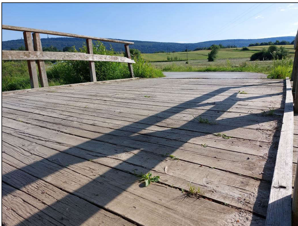
Fot. 18. Nawierzchnia jezdni na moście. Widoczne liczne uszkodzenia dyliny górnej – spękania, rozwarstwienia i deformacje. Około 10% bali dyliny górnej przemieszcza się podczas przejazdu samochodów, co świadczy o rozluźnieniu łączników.
