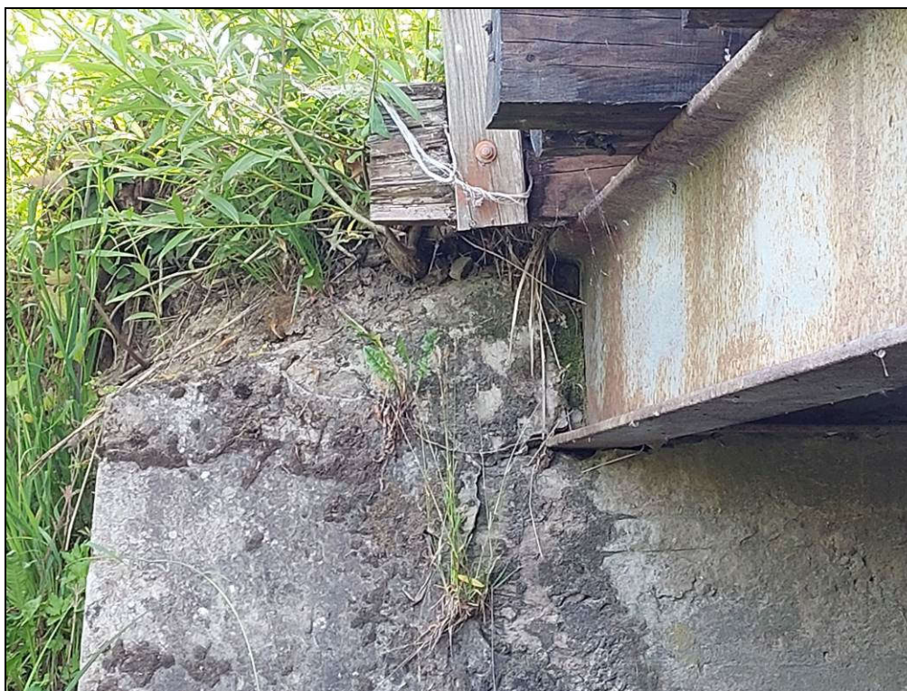
Fot. 9. Podpora lewobrzeżna od strony dolnej wody. Zanieczyszczenia i wegetacja roślinności na korpusie od strony dolnej wody. Zarysowania, złuszczenia i odspojenia przypowierzchniowej warstwy betonu. Zewnętrzny bok dźwigara skrajnego zabetonowany w obrębie podpory.
