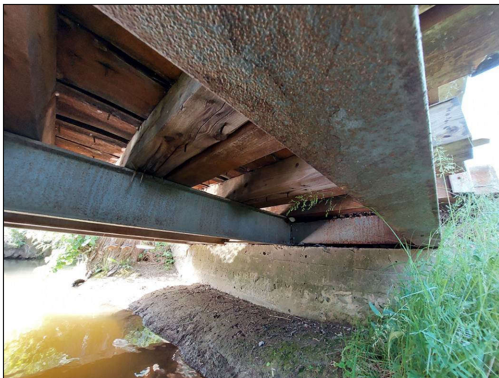
Fot. 14. Widok spodu ustroju nośnego. Brak powłoki malarskiej oraz widoczna postępująca korozja wzerowa. Poprzecznice drewniane ze spękaniem podłużnym.
