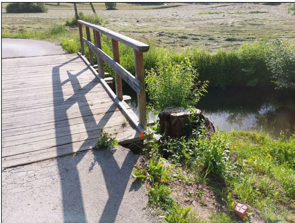
Fot. 20. Nawierzchnia jezdni na dojeździe od strony m. Trochowiny / górnej wody. Deformacje nawierzchni i spękania świadczące o braku prawidłowej podbudowy. Brak skrzydełek ograniczających nasyp oraz nawierzchnię drogi gminnej w bezpośrednim sąsiedztwie mostu.
