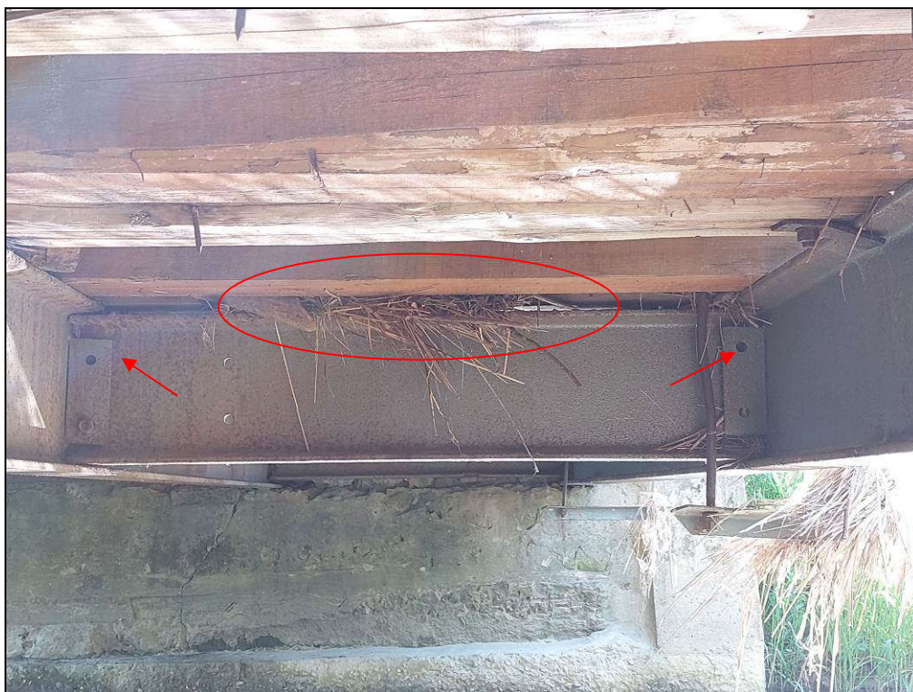
Fot. 13. Widok spodu ustroju nośnego. Brak powłoki malarskiej oraz widoczna postępująca korozja wzerowa. Dźwigary stanowiące ustrój nośny nie posiadają uszkodzeń (trwałych ugięć) świadczących o przeciążeniu konstrukcji. Brak łączników śrubowych łączących poprzecznice ceową z dźwigarami głównymi. Widoczna sucha trawa świadczy o wysokim (okresowym) poziomie wody w rzece. Wystające gwoździe stanowią zagrożenie dla osób wykonujących przegląd.
