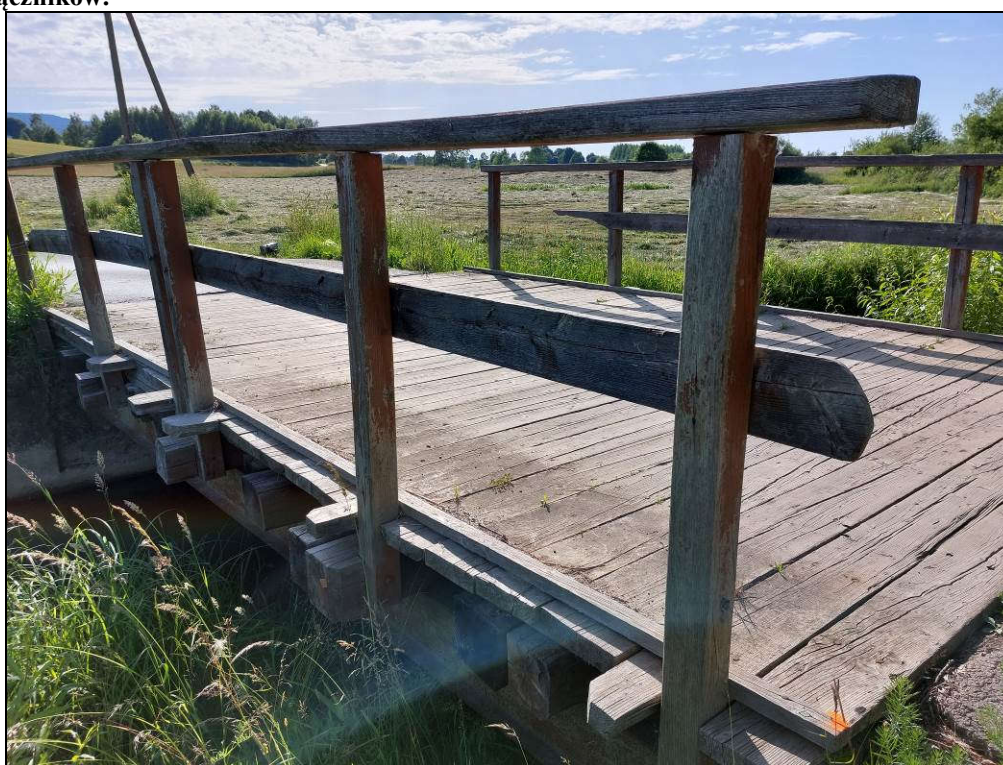
Fot. 19. Nawierzchnia jezdni na moście. Widoczne liczne uszkodzenia dyliny górnej – spękania, rozwarstwienia i deformacje. Około 10% bali dyliny górnej przemieszcza się podczas przejazdu samochodów, co świadczy o rozluźnieniu łączników.
