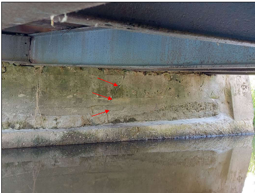
Fot. 8. Podpora prawobrzeżna. Rysa w środku podpory powstała najprawdopodobniej na skutek przejazdu pojazdu ponadnormatywnego.
