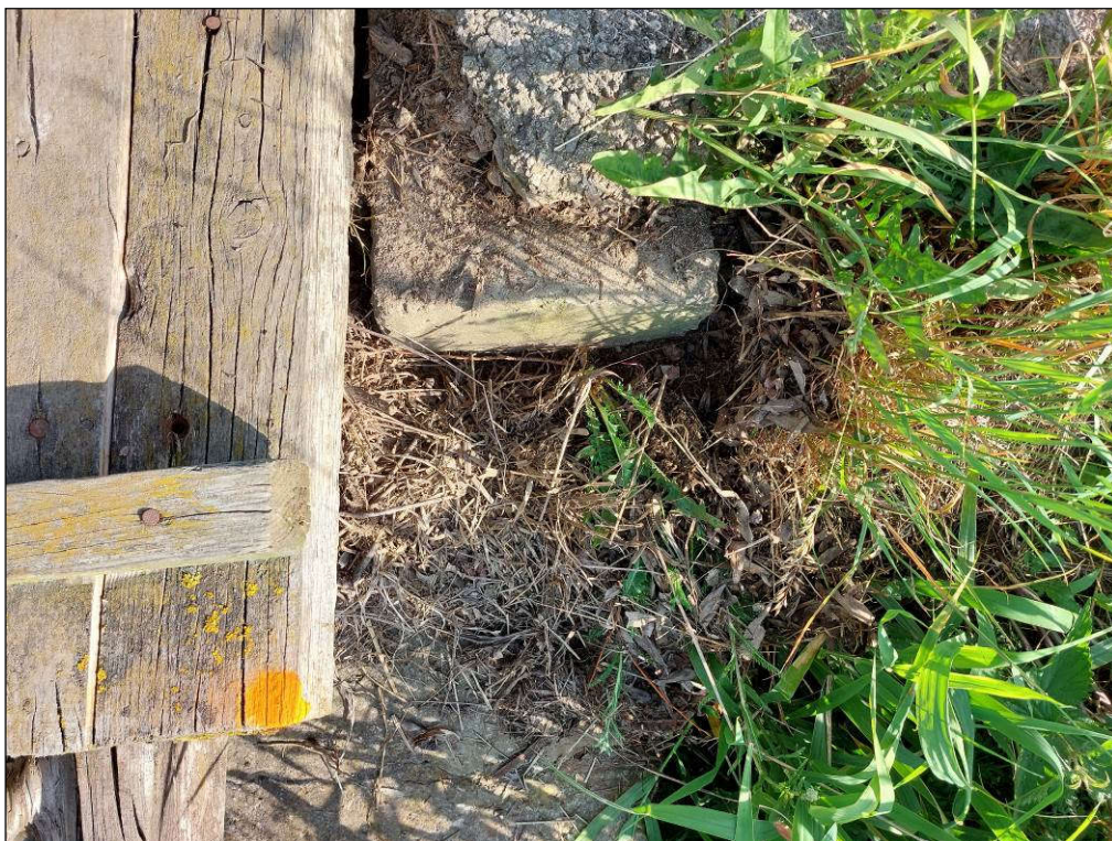
Fot. 21. Połączenie drogi z mostem. Widoczna podwalina betonowa o wymiarach 30x15cm, która z uwagi na znikome gabaryty i brak prawidłowego posadowienia nie stanowi prawidłowego oparcia dla bitumicznej nawierzchni jezdni.
