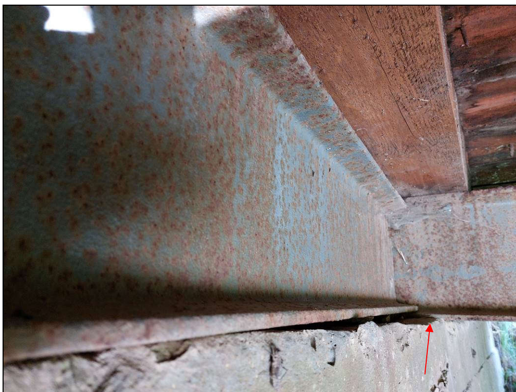
Fot. 16. Oparcie dźwigara głównego bezpośrednio na betonie podpory.
