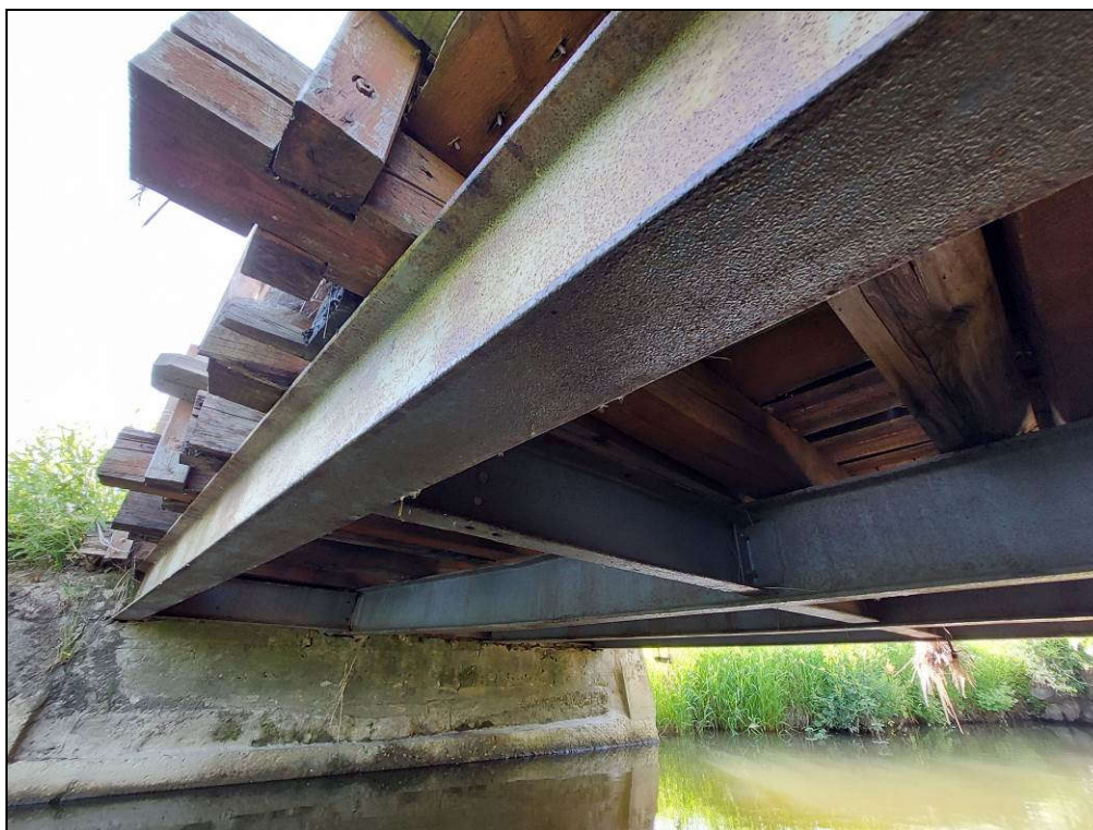
Fot. 12. Widok spodu ustroju nośnego. Brak powłoki malarskiej oraz widoczna postępująca korozja wżerowa. Dźwigary stanowiące ustrój nośny nie posiadają uszkodzeń (trwałych ugięć) świadczących o przeciążeniu konstrukcji.
