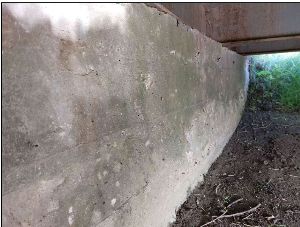
Fot. 10. Bok korpusu podpory lewobrzeżnej. Lokalne porowatości, ubytki, niedowibrowania oraz złączenia przypowierzchniowej warstwy betonu.
