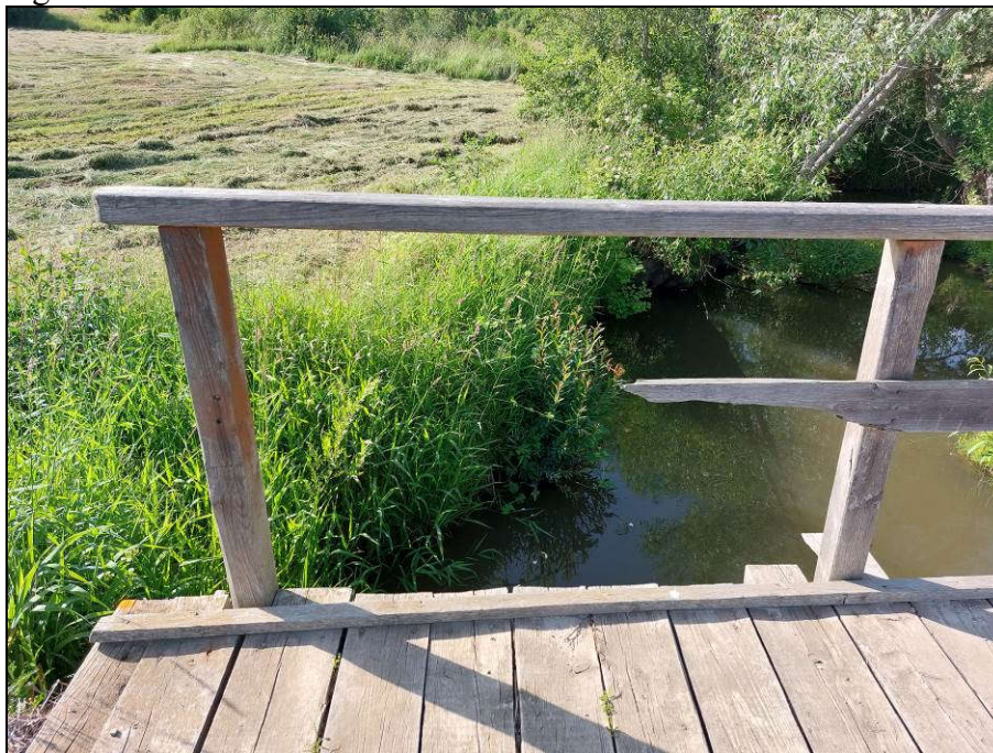
Fot. 22. Balustrada drewniana od strony m. Mirocice / górnej wody. Brak przeciagu oraz prawidłowego zakotwienia słupków balustrady w elementach ustroju nośnego mostu. Brak barier ochronnych na dojazdach.
