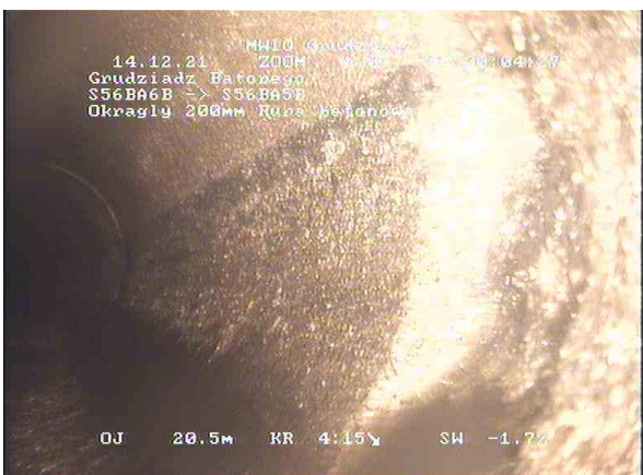
c32a94c6-3183-4c33-85a2-6aa7f4b80f0d_20211214_150324_714.jpg, 00:04:20, 20.69 Uszkodzenie powierzchniowe, brakująca ściana, działanie
