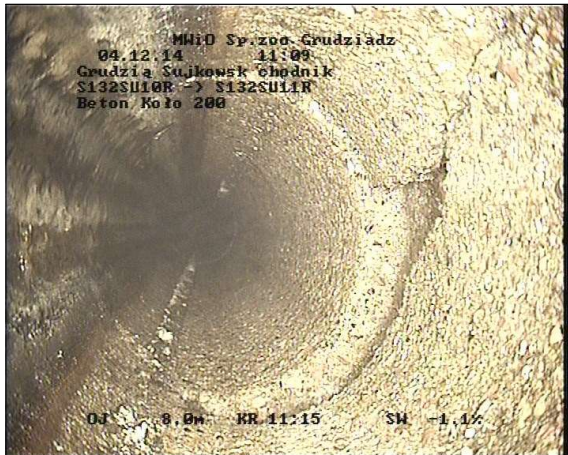
Zdjęcie: 16_3B 8,53m, Inne uszkodzenie powierzchni, od 10 do 12 godz.
