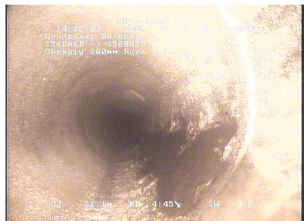
de441878-e83b-4448-86e1-d2008792a971_20211214_135613_654.jpg, 00:05:00, 21.45 Przerwanie, brakujące fragmenty ściany, Długość: 100mm od
