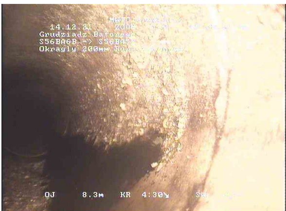
8cd6d251-6304-4072-bb7a-7577eb444fa9_20211214_150035_290.jpg, 00:01:54, 8.60 Przerwanie, brakujące fragmenty ściany, Długość: 50mm od 4
