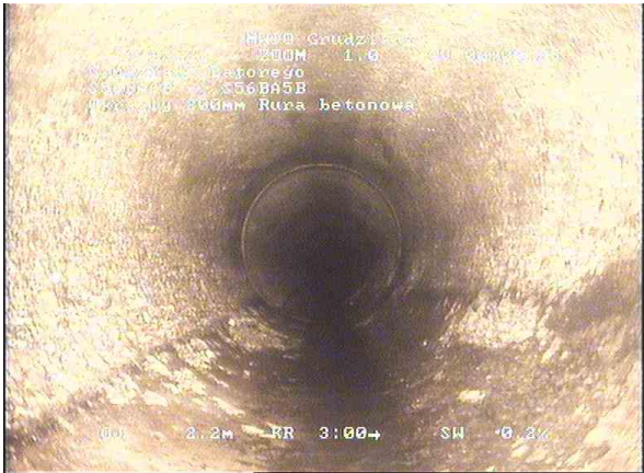
079d9cab-f713-4de6-96b3-b97074920bf9_20211214_145807_636.jpg, 00:00:20, 2.29 Uszkodzenie powierzchniowe, kruszywo wystające z
