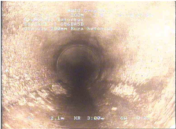
945e37ee-4a78-4797-bc3a-4042466e1fde_20211214_134944_581.jpg, 00:00:22, 2.10 Uszkodzenie powierzchniowe, widoczne zbrojenie, działanie
