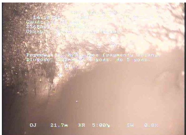
f49dbca4-a0f2-4b1e-b205-0531293fff74_20211214_135641_649.jpg, 00:05:30, 21.76 Przerwanie, brakujące fragmenty ścianki, Długość: 100mm od
