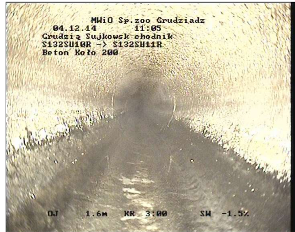
Zdjęcie: 16_1B 1,6m, Kruszywo wystające z powierzchni, od 12 do 12 godz.
