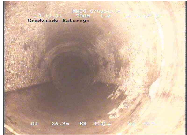
a7d58cc8-668c-4f85-b644-06fc97f2e944_20211214_154028_336.jpg, 00:03:34, 37.29 Uszkodzenie powierzchniowe, zwiększona chropowatość,
