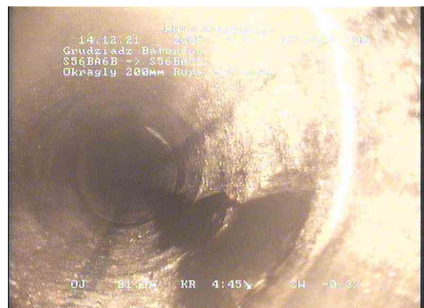
55416ca1-8211-4ddc-bf4b-5d005bfea3b9_20211214_150423_144.jpg, 00:04:54, 21.66 Uszkodzenie powierzchniowe, brakująca ściana, działanie
