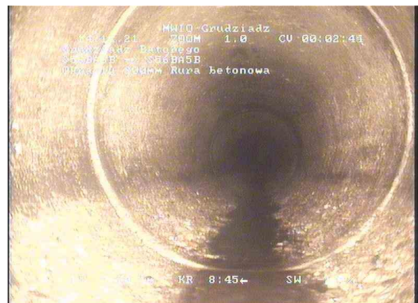
1c87e9ce-99a5-48d1-8724-076df35fe85b_20211214_150126_044.jpg, 00:02:40, 10.13 Uszkodzenie powierzchniowe, kruszywo wystające z
