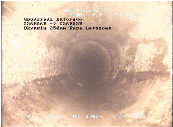
3b8f736c-53cd-4cc7-bbda-c379a72fa64f_20211214_153940_681.jpg, 00:02:57, 35.18 Uszkodzenie powierzchniowe, kruszywo wystające z
