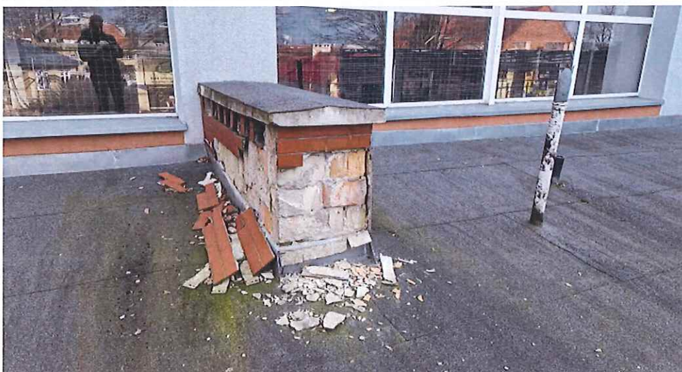
Fot. 37-38. Istniejące kominy.
