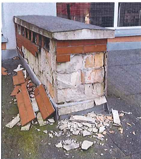
Fot. 54. Istniejące kominy do naprawy.
