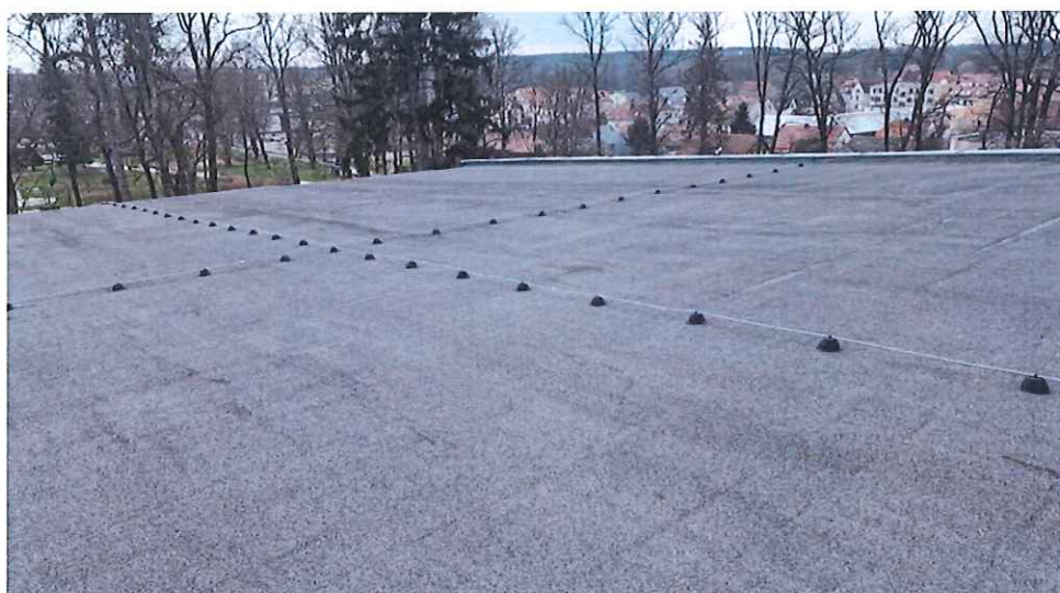
Fot. 39- 41. Stan techniczny dachu budynku hali sportowej.
