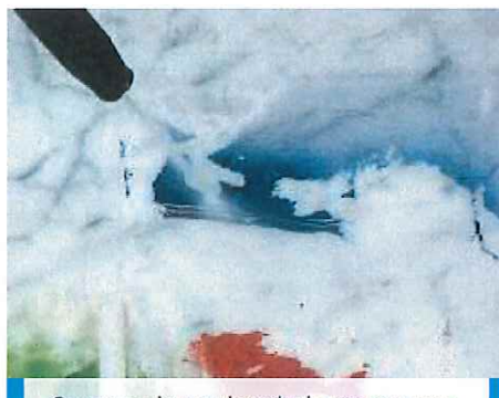
Czyszczenie powierzchni z marmuru z Carrary wodą pod wysokim ciśnieniem po użyciu WallGard Graffiti Barrier
