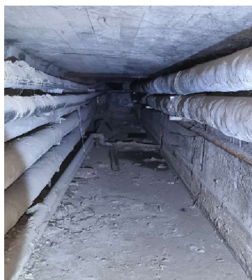
Zdjęcie 5 Istniejące instalacje w kanale technicznym
