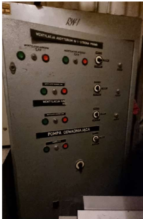
Zdjęcie 1 Jedna z szaf sterujących nieczynnymi elementami nawiewnymi
