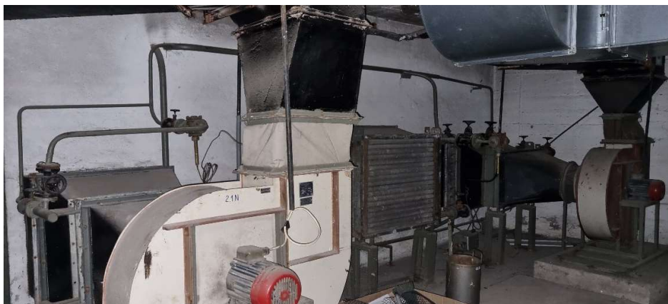
Zdjęcie 2 Urządzenia wentylacyjne niedziałającego systemu wentylacji do demontażu
