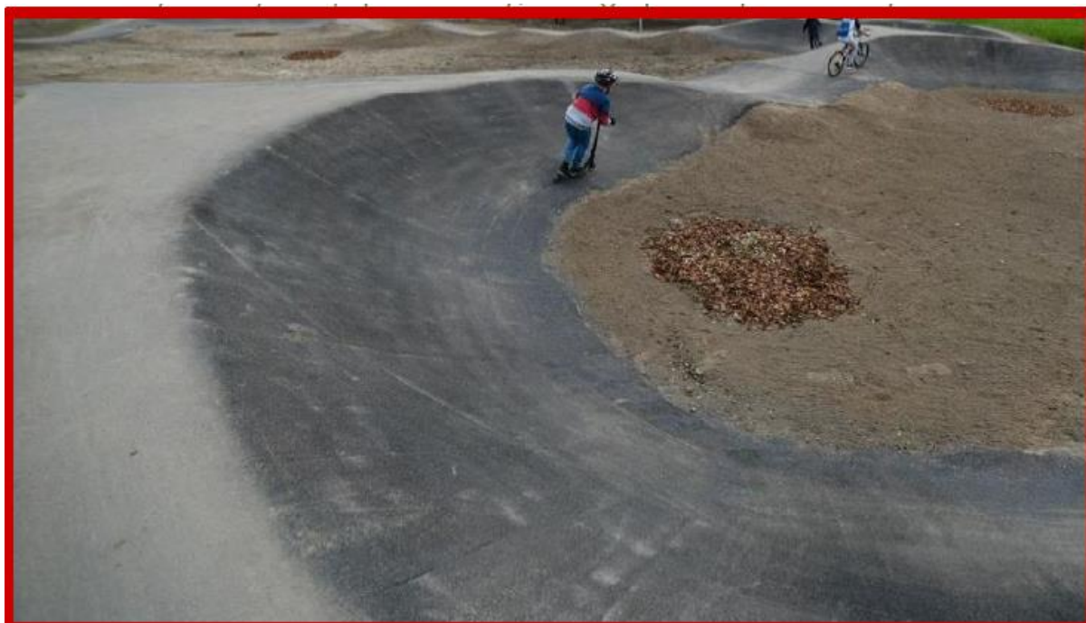
Nieprawidłowo wykonany zakręt o niejednostajnym promieniu, bez wypłaszczonej dolnej półki oraz niebędący w przekroju wycinkiem koła.
