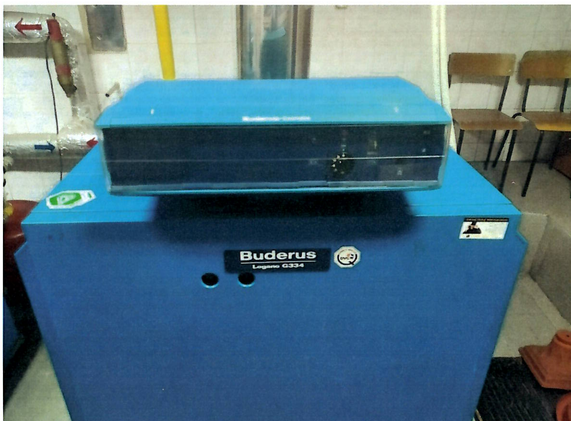
Rysunek 2. Kocioł gazowy wykorzystywany w rozpatrywanym budynku
