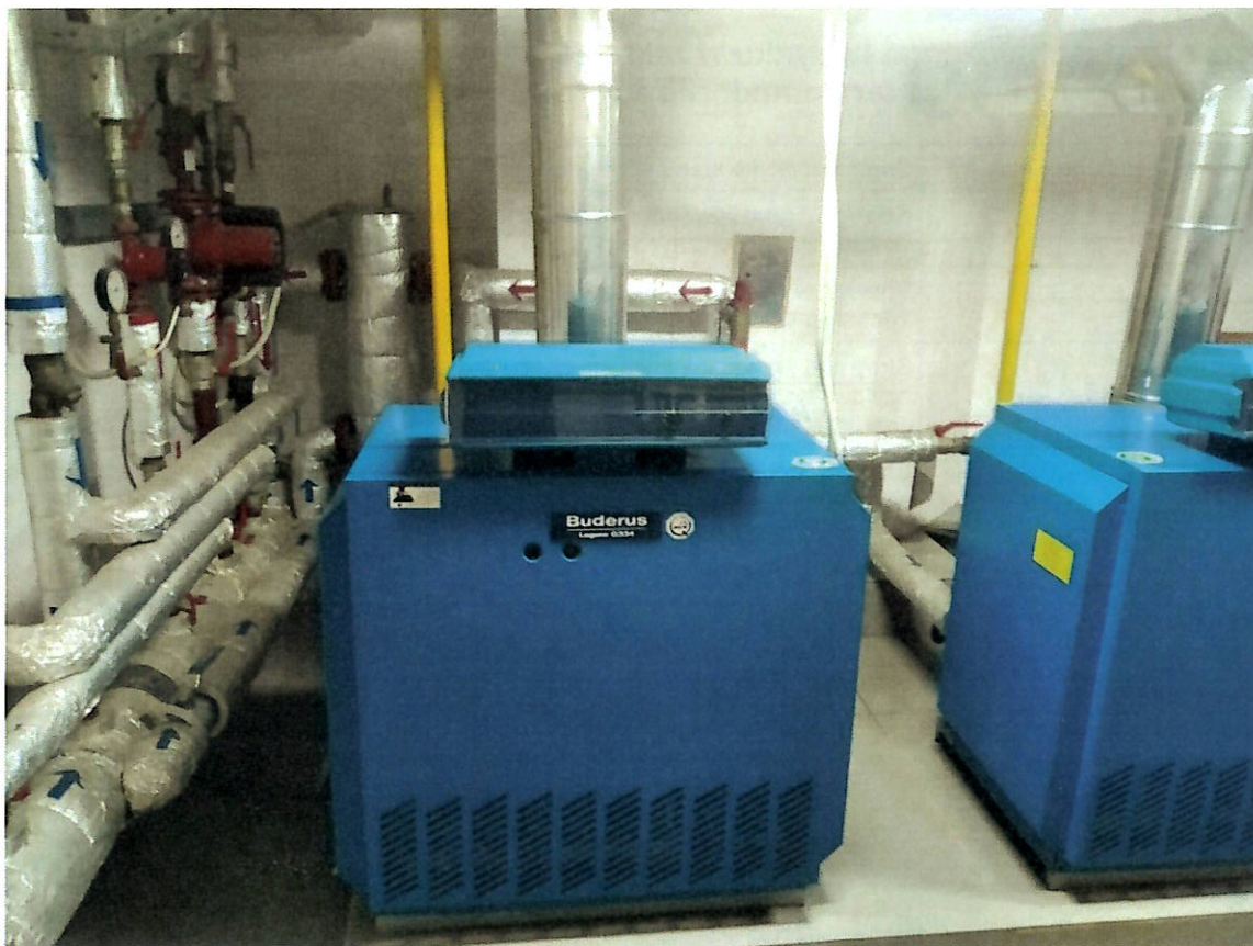
Rysunek 1. Kocioł gazowy wykorzystywany w rozpatrywanym budynku
