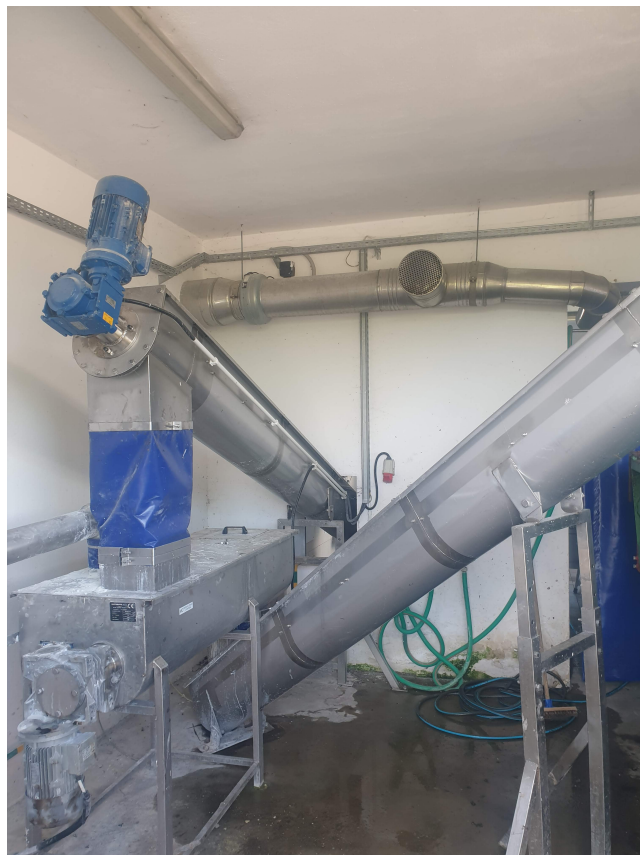
Fot. 6 Budynek socjalno-techniczny – pomieszczenie SHO
