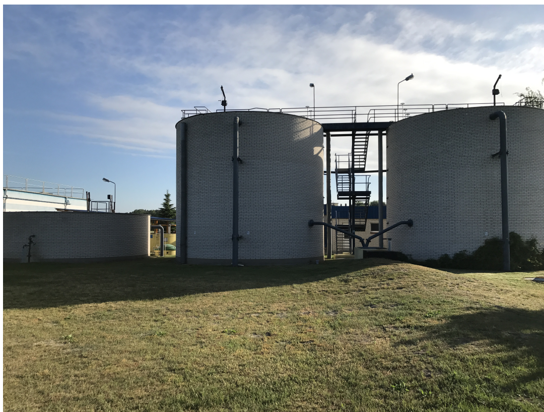
Fot. 9 Zbiorniki tlenowej stabilizacji osadu i zbiornik nadawy – widok od strony południowej
