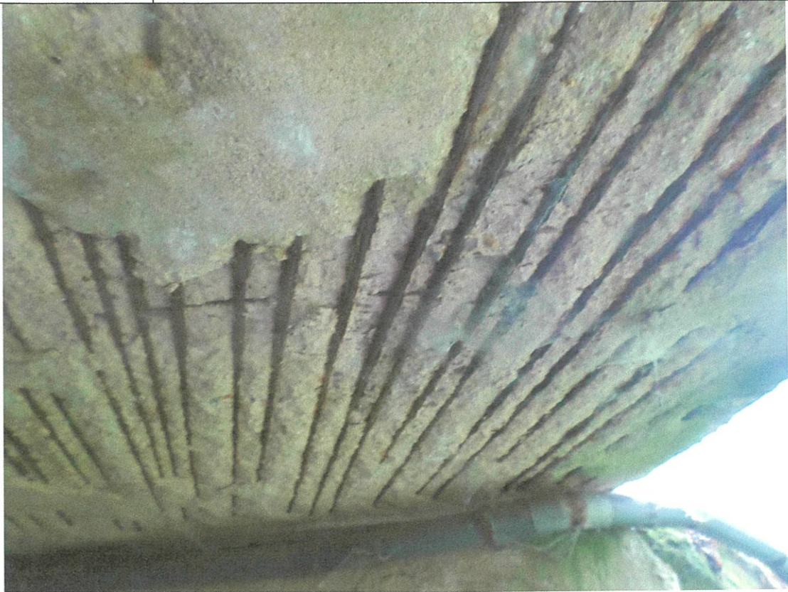
Fot. 1 . Uszkodzenia płyty pomostowej, zawansowane korozja betonu i stali zbrojeniowej, przecieki wody.
