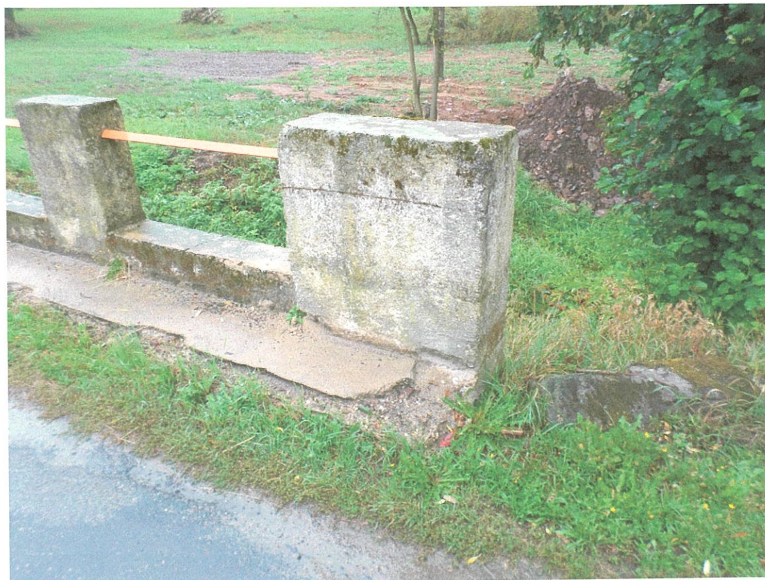
Fot. 4 . Zanieczyszczenia jezdni, wegetacja roślin. Uszkodzenia opaski betonowej erozja i wykruszenia. Pęknięcie i ubytki w betonowych elementach balustrad.
