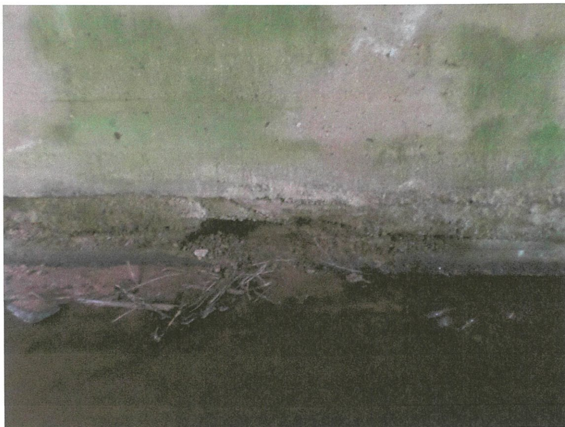
Fot. 3 . Erozja przyczółka betonowego.
