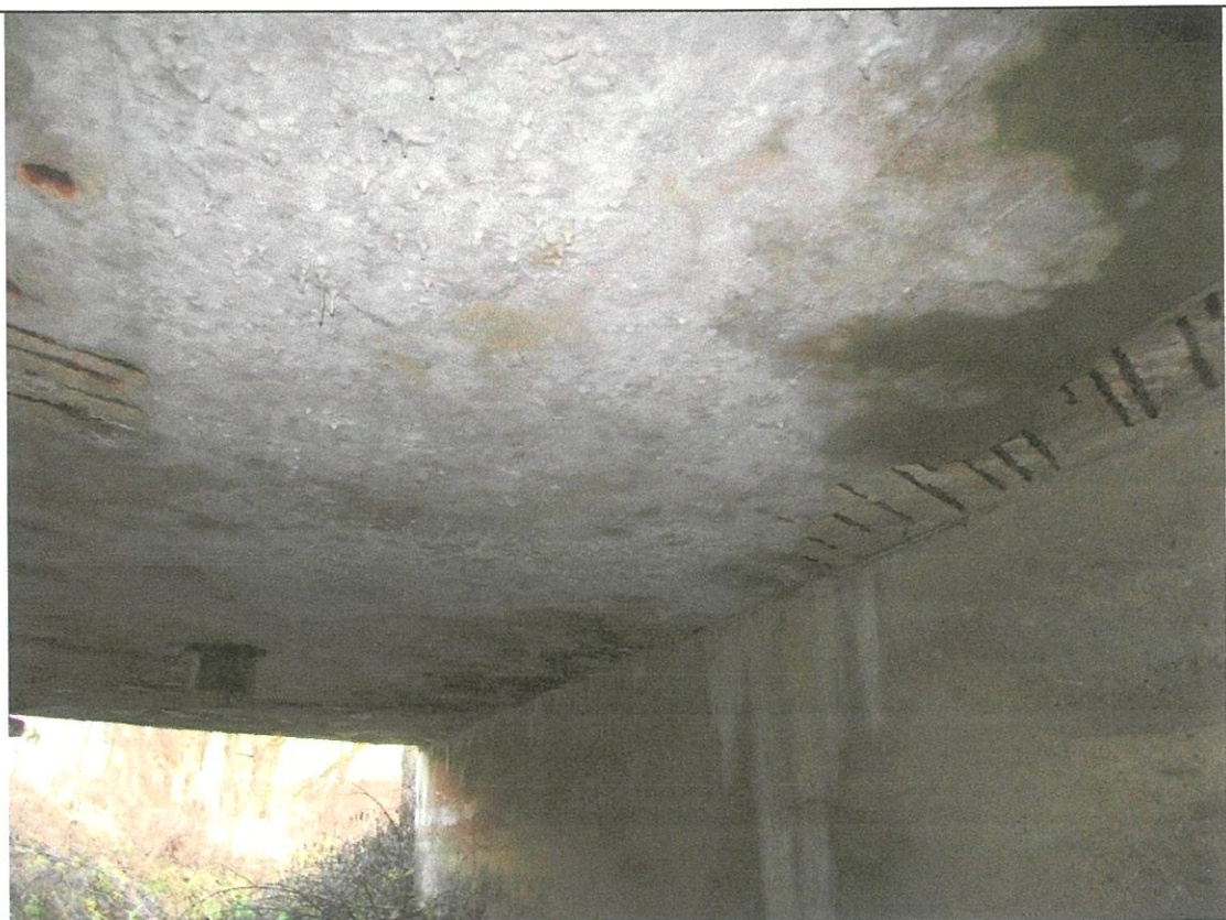
Fot. 2 . Wyługowania i przecieki wody na płycie pomostowej.
