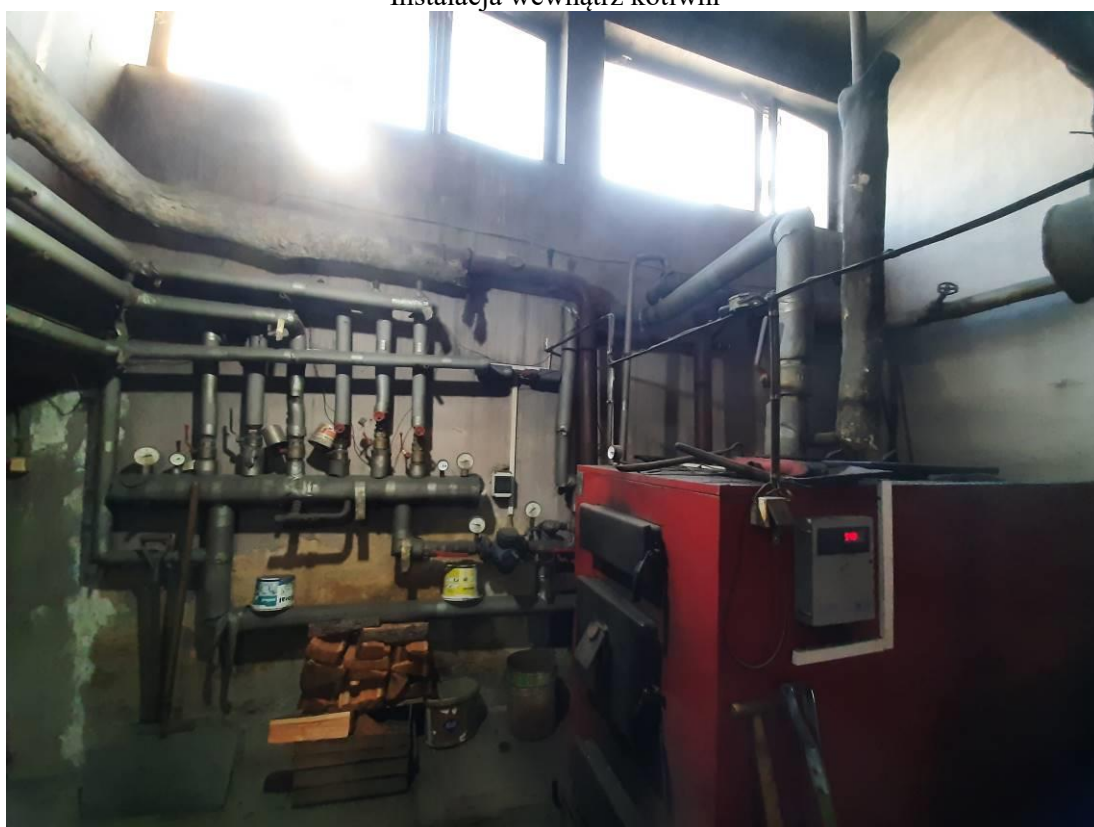
Instalacja wewnątrz kotłowni
