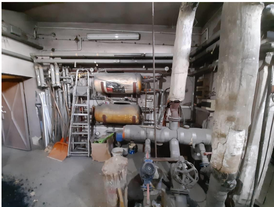
Instalacja wewnątrz kotłowni
