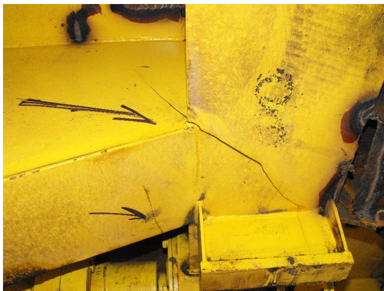
Rysunek 10. Pęknięcie ramy nośnej wciągarki suwnicy.
