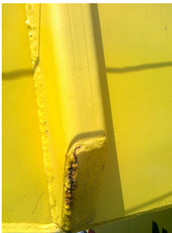
Rysunek 11. Pęknięcie członu wysięgnika.
