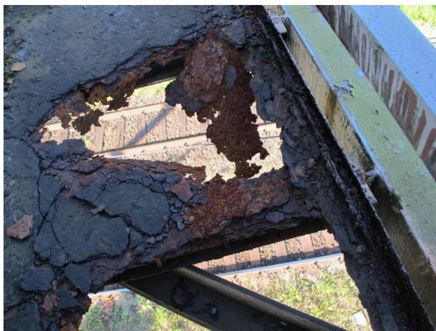
Rysunek 5. Korozja blach podestu suwnicy.
