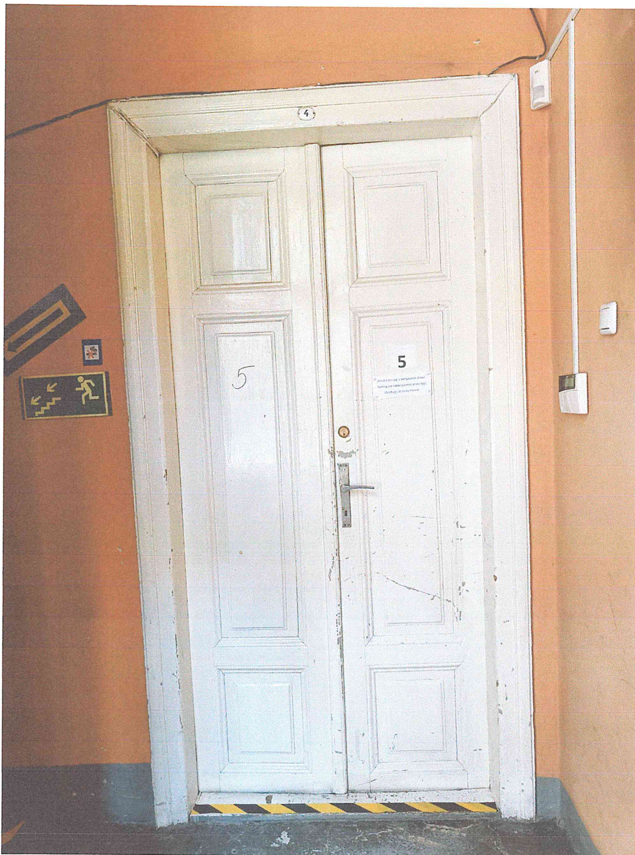
drzwi do sali nr5 w trakcie tylnym od zachodu - widok od strony wnętrza korytarza klatki schodowej tylnej – zadrapania farb, spękania w miejscach łączyli poszczególnych elementów składowych
