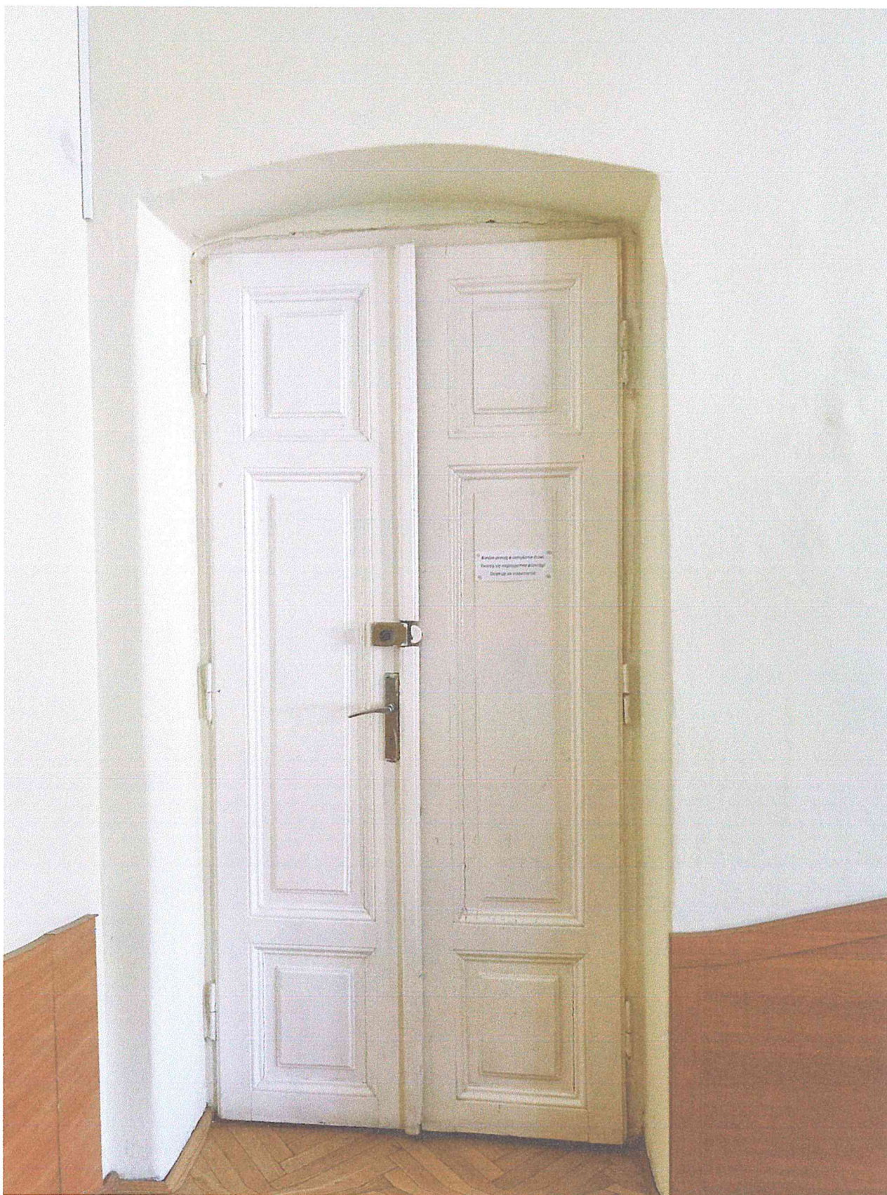
drzwi do sali nr5 w trakcie tylnym od zachodu - widok od strony wnętrza -- zadrapania farb , spękania w miejscach łączyli poszczególnych elementów składowych a stylowa klamki i szylt
