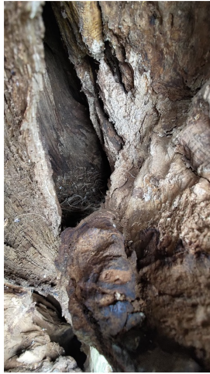
fot. 11 Gniazdo ptasie we wnętrzu ubytku
