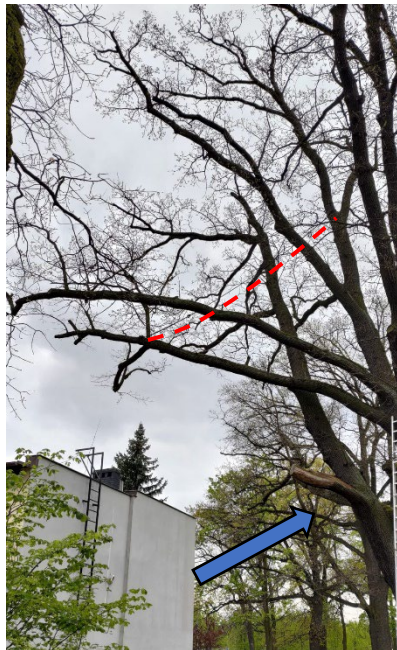
fot. 24 Martwy konar (niebieska strzałka) i wiązanie konaru nad budynkiem (przerywana czerwona linia)
