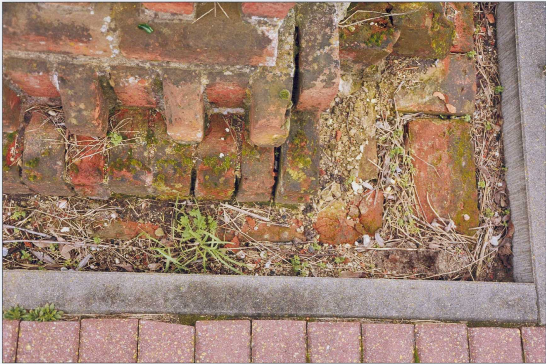
Fot.11. Cokół, zbyt blisko położony chodnik.
