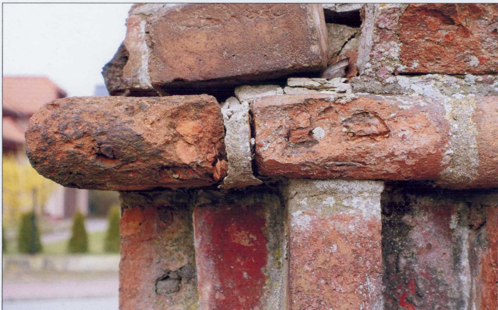
Fot.18. Cokół, górne partie, zniszczenia fug i zaburzona statyka gzymsu.
