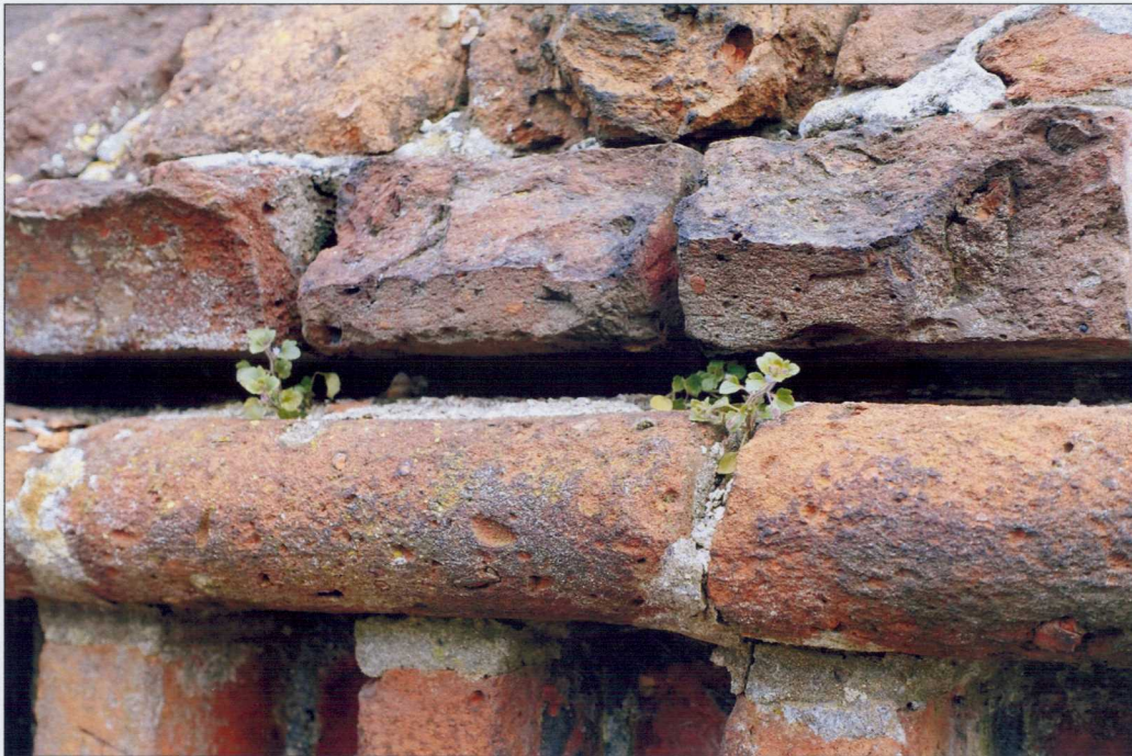
Fot.17. Cokół, zniszczenia w górnych partiach, braki fugi i obecność w tych miejscach samosiejek .
