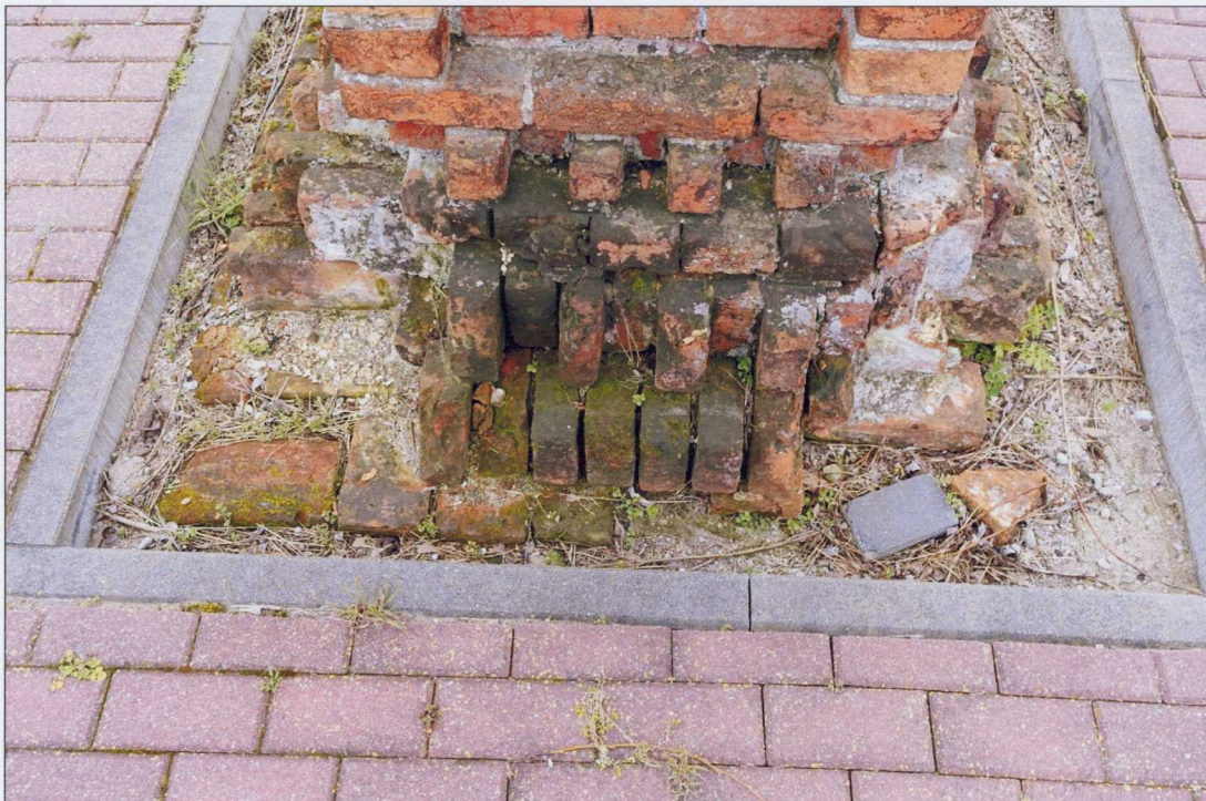
Fot.12. Cokół, zniszczenia wynikłe min. ze zbyt blisko położonego chodnika, czarne nawarstwienia powstałe z oddziaływania atmosferycznego w środowisku miejskim.
