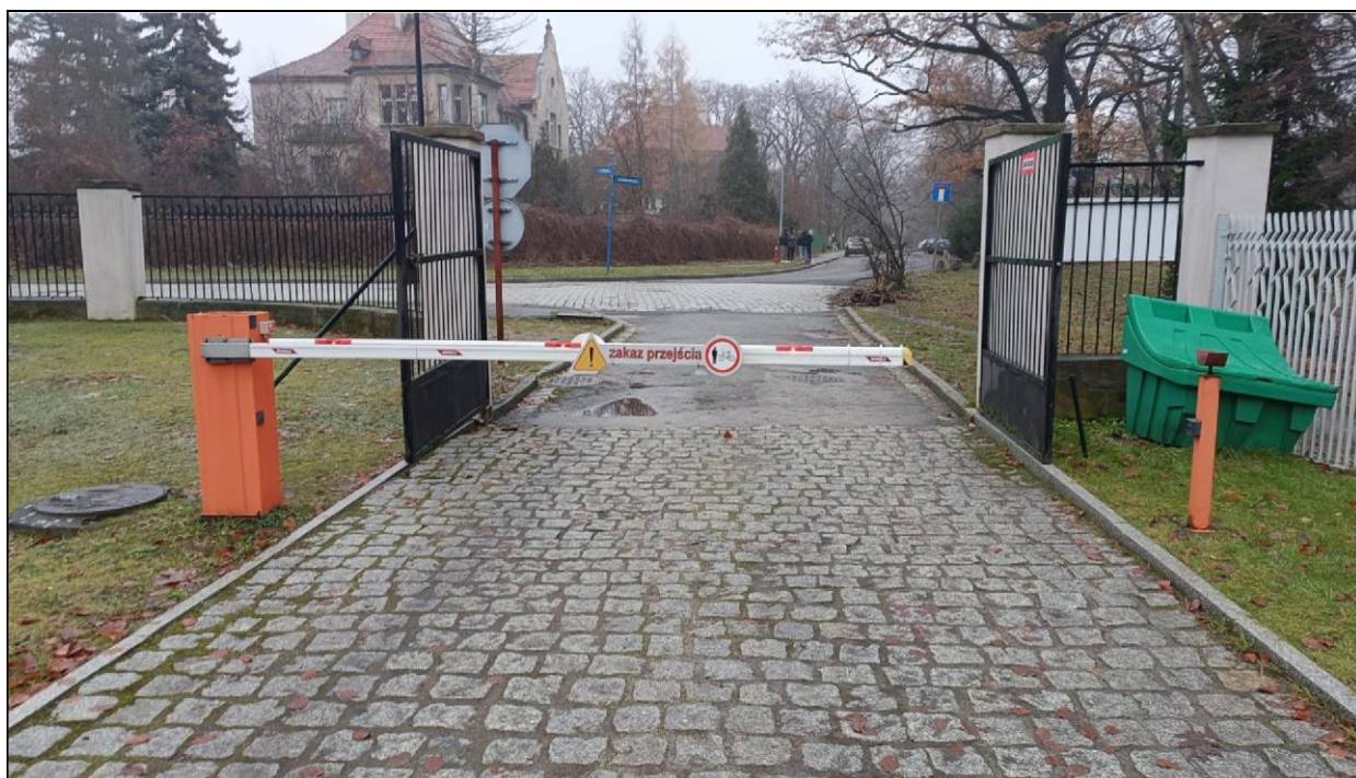
Zdjęcie nr 2 – Budynek przy ul. Witelona 25a. Montaż domofonu przy istniejącym szlabanie.
