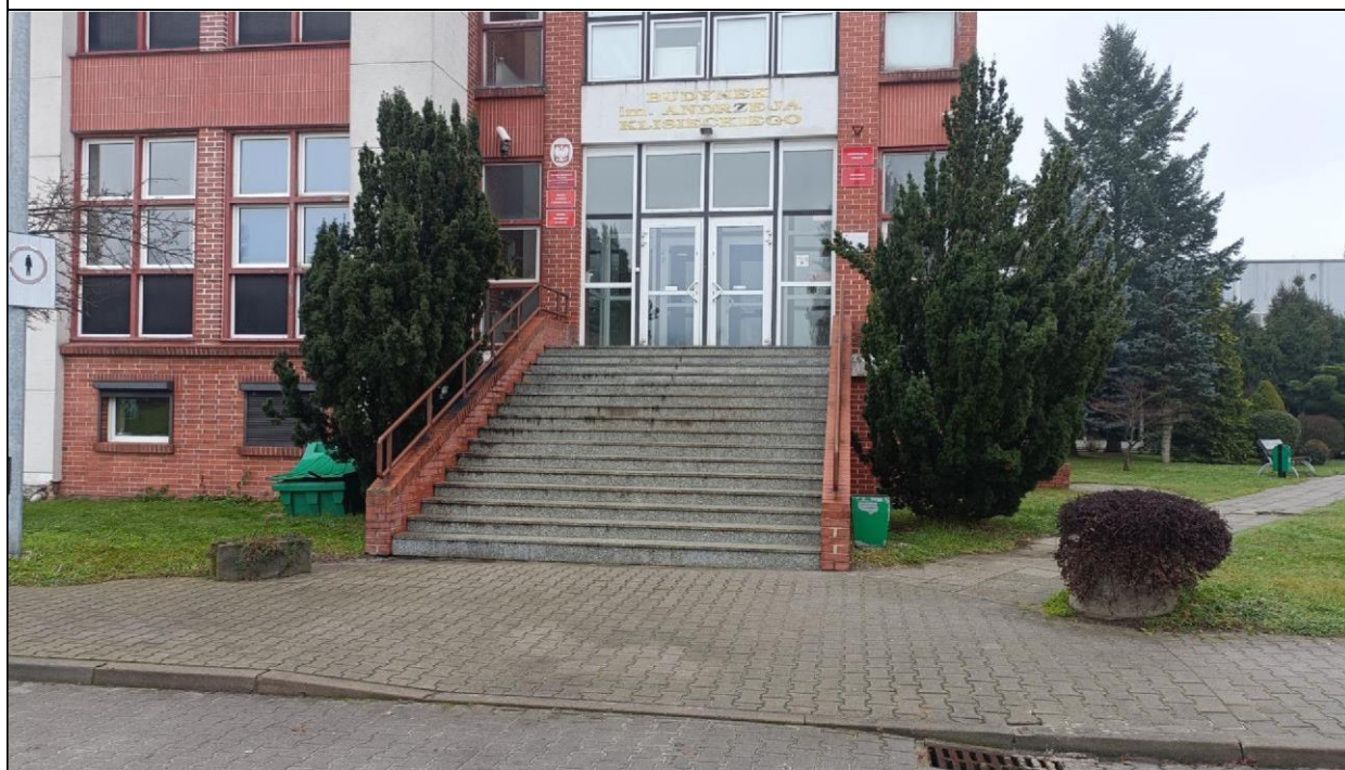
Zdjęcie nr 5 – Istniejące dojście do budynku P-3. Krawężnik do obniżenia / zlicowania z jezdnią.
