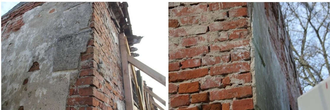
Fot. 64-66. Szczątkowe pozostałości boniowań na narożnikach ścian elewacji spichrza w 2021 r.
