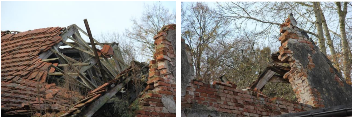
Fot. 38. Widoczne krokwie i płatwie uszkodzonej więźby dachowej. Dachówka spadła, mur się przechylił. Bardzo zły stan zachowania muru ceglanego.
