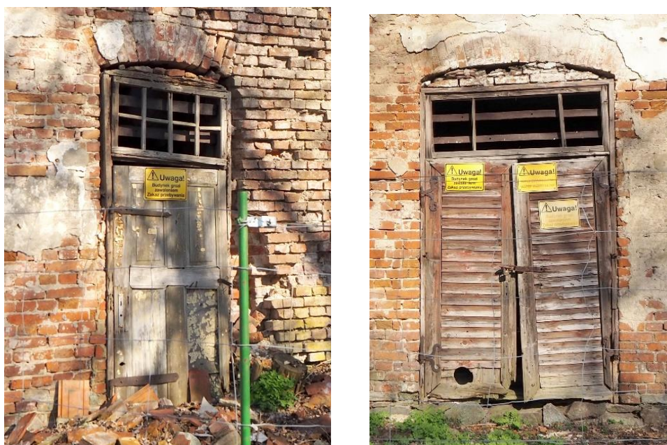
Fot. 17. Obecnie skrzydła drzwi po lewej stronie są wtórne. Po prawej stronie zachowały się oryginalne drzwi z żaluzjowym opierzeniem pływ oraz okuciami.
