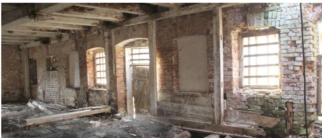
Fot. 19-20. Stan zachowania otworów okiennych w 2021 r.
