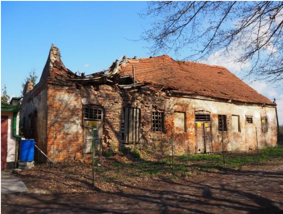
Fot. 15. Od strony elewacji zachodniej widoczny jest zawalony dach. Ściany poniżej zawalonego dachu w bardzo złej kondycji. Cegły sypią się i pudrują, pozbawione są oryginalnego spieku. Gzyms jest uszkodzony. Pomiędzy ceglami brak spoiny, ponieważ została wypłukana.
