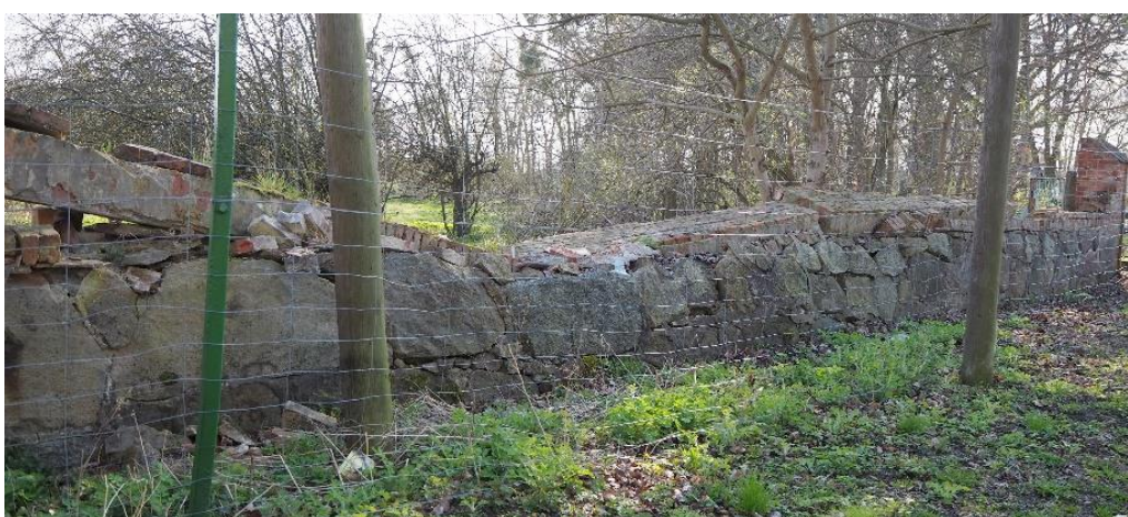
Fot. 52-53. Mur ceglany na fundamencie kamiennym (mur cyclopowy) oddziela drogę dojazdową do pałacu od sadu. Mur uległ zawaleniu, prawdopodobnie jest to spowodowane zastosowaniem zaprawy cementowej w poprzednich pracach remontowych. Zaprawa ta widoczna jest pomiędzy ceglami jak również pomiędzy kamieniami polnymi.
