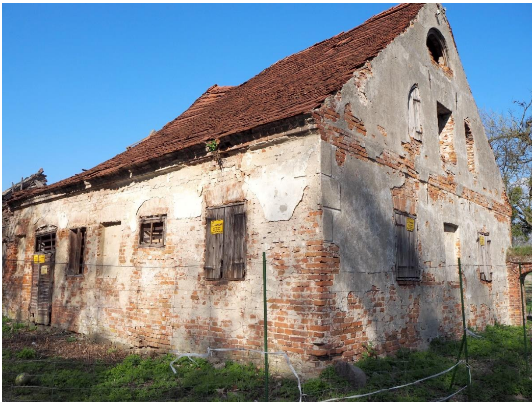
Fot. 30. Na elewacji zachodniej widoczne są pozostałości tynku wapiennego, a na narożnikach ślady po boniowaniu.
