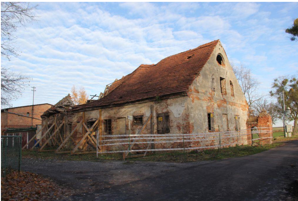
Fot. 16. Ze względu na zły stan zachowania postawiono konstrukcję z belek, aby zabezpieczyć spichlerz. Obiekt został ogrodzony siatką oraz umieszczone zostały na nim tablice ostrzegające przed niebezpieczeństwem
