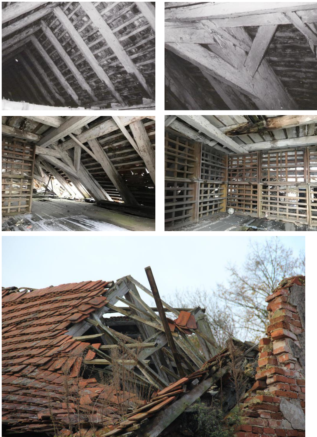
Fot. 40-44. Stan zachowania więźby dachowej spichrza w 2021 r.
