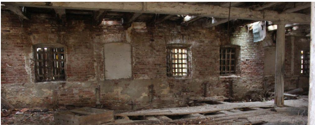
Fot. 22-23. Stan zachowania otworów okiennych w 2021 r..
