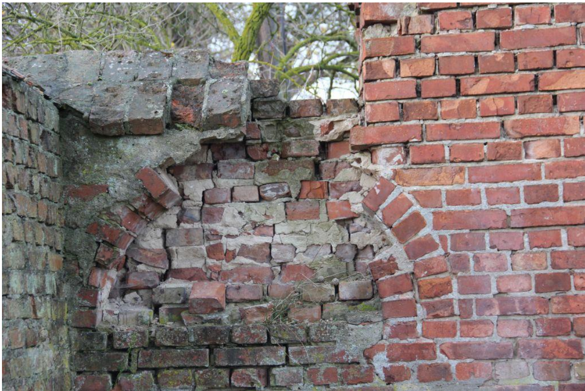
Fot. 45-47. Druga część bramy, słupek oraz pozostałości pierwotnego muru są w bardzo złym stanie zachowania. Widać liczne ubytki w cegle oraz spoinie. Widoczne są wtórne prace naprawcze z zastosowaniem cementowej spoiny, która niekorzystnie wpłynęła na bramę zabytkową. Na powierzchni cegieł widoczna jest zaprawa cementowa, która jest pokryta przez mchy i porosty. Łuk znajdujący się między słupkiem bramy a murem uległ destrukcji.
