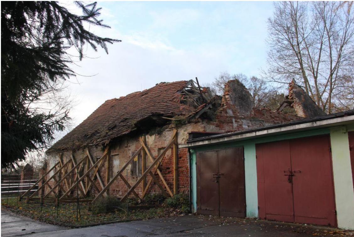
Fot. 37. Elewacja północna od strony garaży jest w najgorszym stanie. Konstrukcja elewacji uległa destrukcji za sprawą zawalenia się dachu. Szczyt spichrza w większości wpadł do środka. Mur jest przechylony i grozi zawaleniem.
