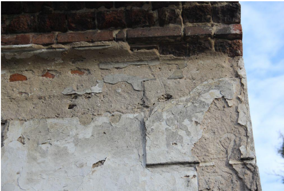
Fot. 66-67. Szczątkowe pozostałości gzymsu w 2021 r.
