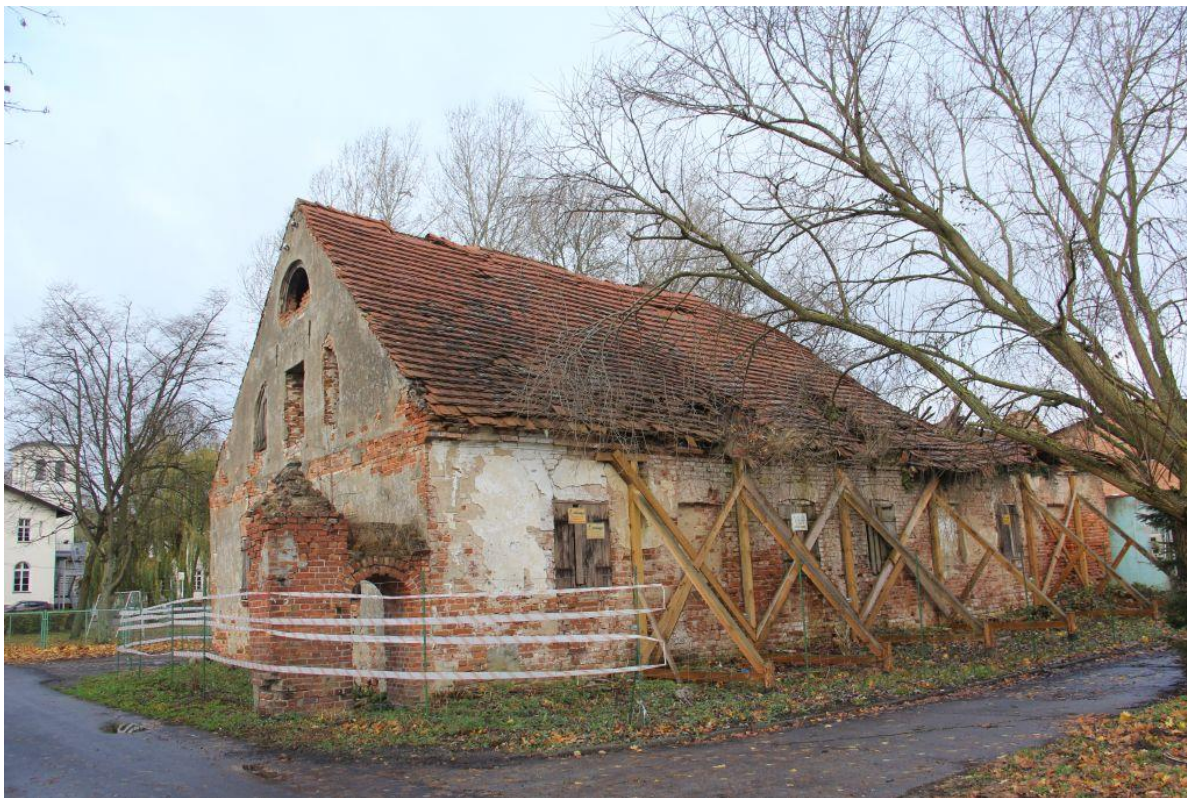
Fot. 1. Budynek dawnego spichlerza jest w stanie katastrofalnym, grozi zawaleniem. Na elewacji znajduje się tynk w złej kondycji, który odspaja się i odpada od lica muru. Dach z dachówki karpieńki wraz z więźbą dachową jest w bardzo stanie, liczne są ubytki w dachówkach. Od strony północnej dach się zawalił.
