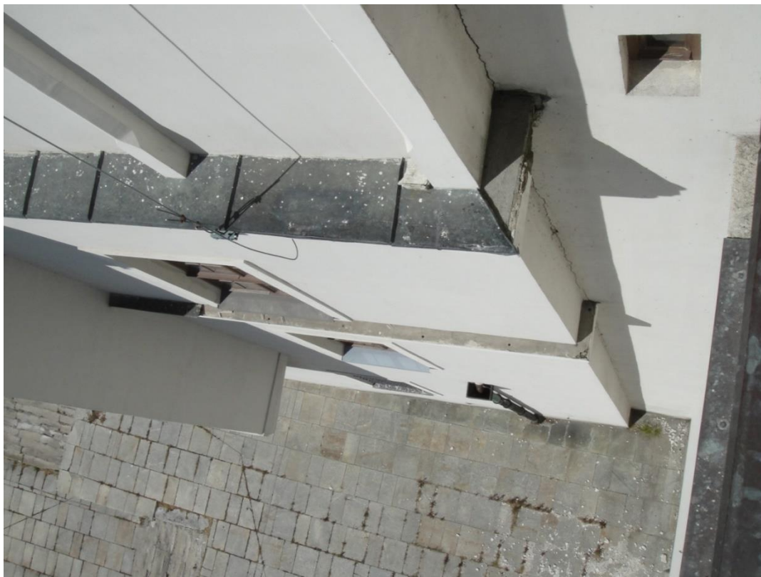
Brak parapetu na odcinku 5 metrów-ściana wschodnia
