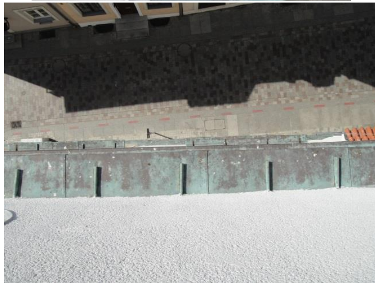
Brak osłon z blachy na prętach - dolny poziom ściany pd skrzydło zachodnie
