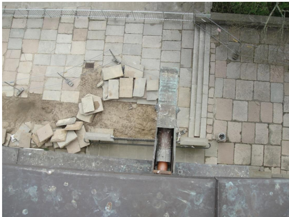
Brak pokrywy „zygacza” na ścianie wschodniej skrzydła wschodniego
