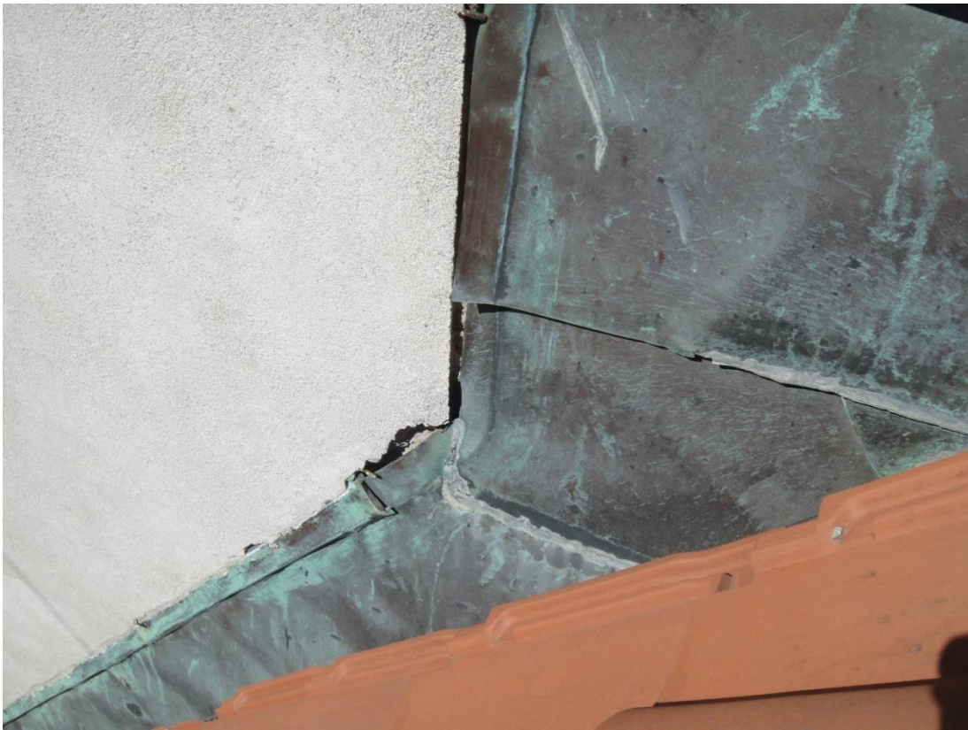
Widoczny brak elementów opierzenia z blachy
