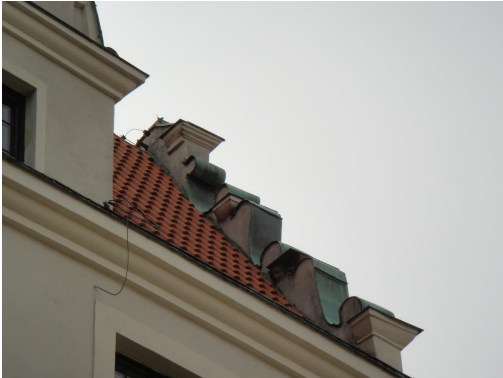
Skrzydło mennicze- widoczna dziura pod blachą
