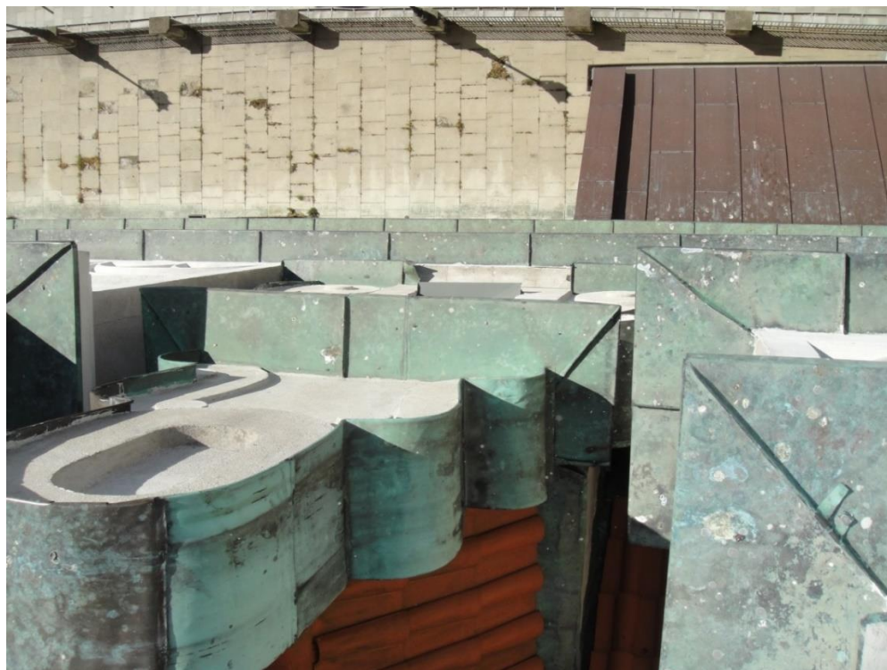
Brak parapetu-ściana południowa skrzydła menniczego
