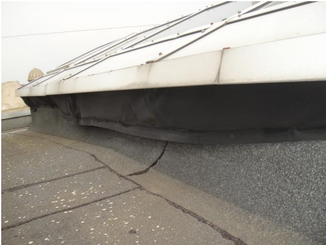
Odklejone gumy na świetlikach skrzydła zachodniego
