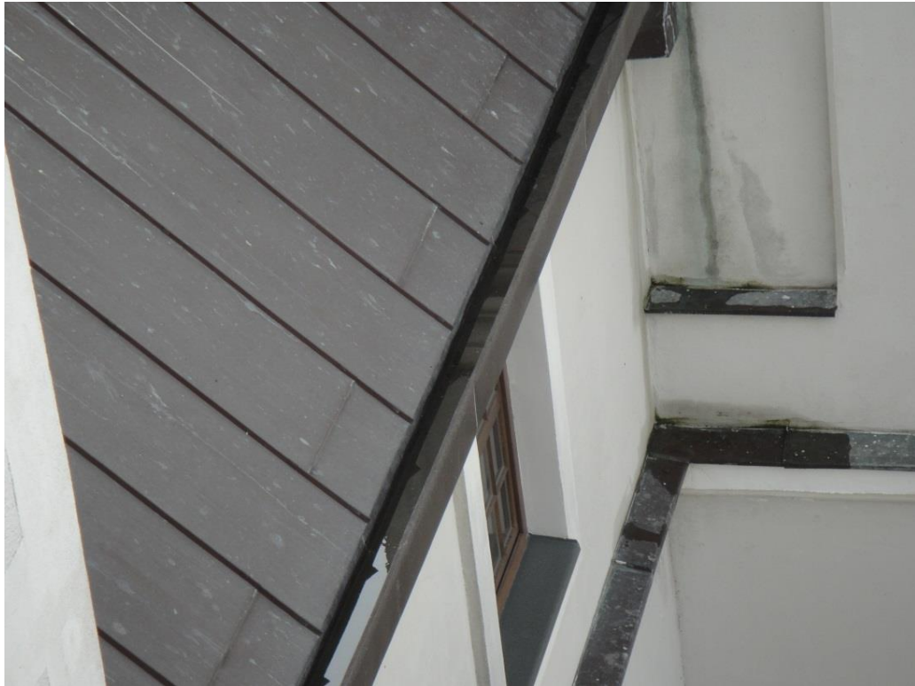
Brak odpływu na łączniku skrzydła południowego z zachodnim
