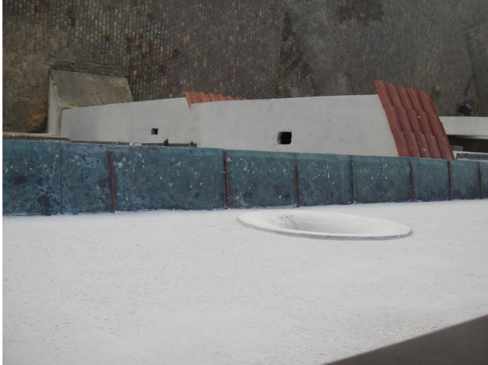
Brak osłon - skrzydło zachodnie
