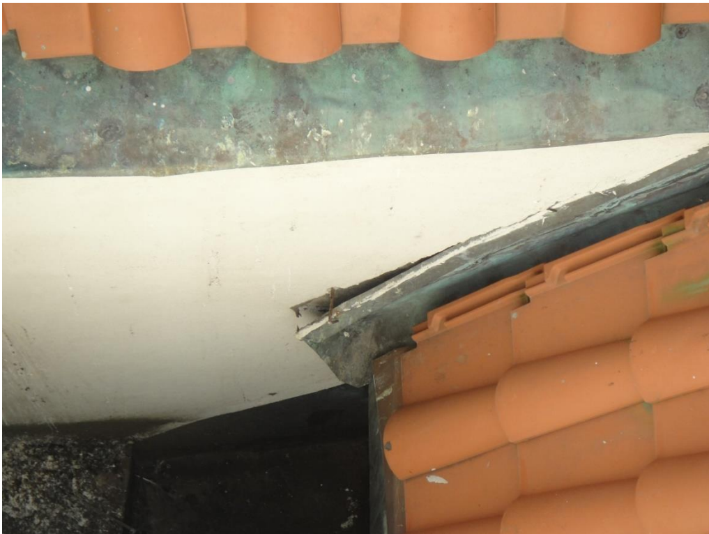
Uszkodzony Opierzenie na styku dachu i ściany
