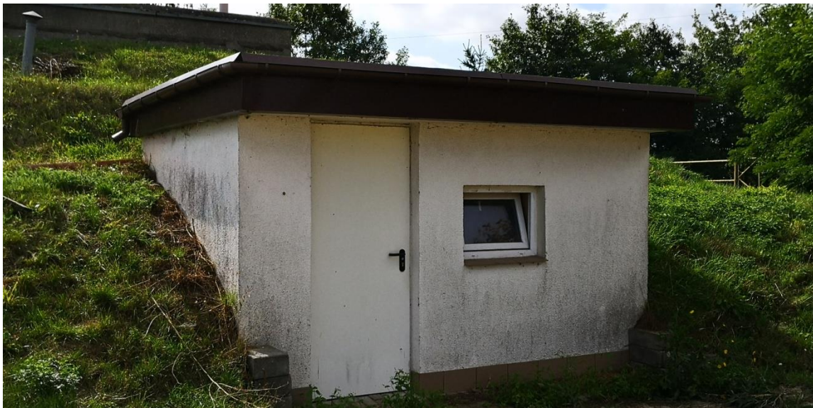
Fot. 11 Punkt pomiarowy ścieków oczyszczonych
