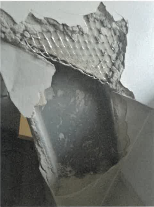
Słup ramy stalowej poddasza – w bardzo dobrym stanie technicznym.
