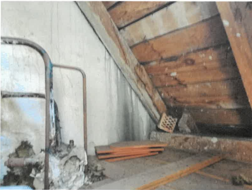
Zawilgocenie (zaciek) ściany i więźby drewnianej widok z poziomu stropu nad poddaszem.
