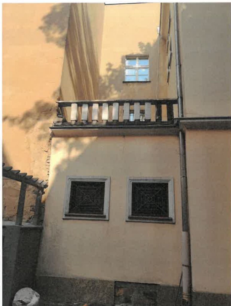
Zawilgocenie ścian na styku z budynkiem sąsiadującym widok od dziedzińca.
