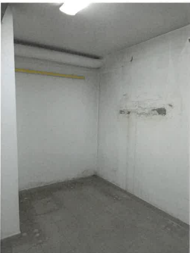
Zawilgocenie ściany piwnicznej w miejscu zamurowanego naświetla od ul. Kramarskiej.
