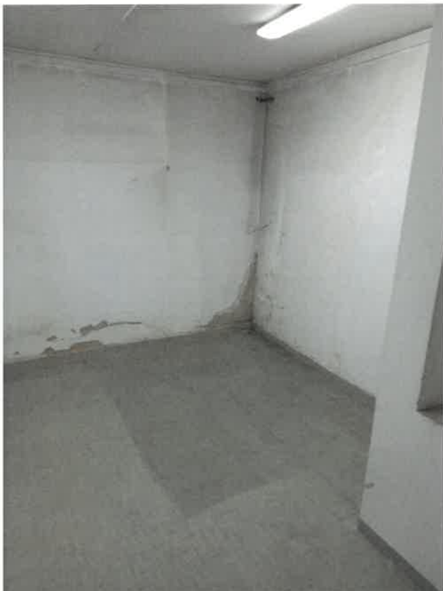
Zawilgocenie narożnika ściany piwnicznej w miejscu zamurowanego naświetla od ul. Kramarskiej.
