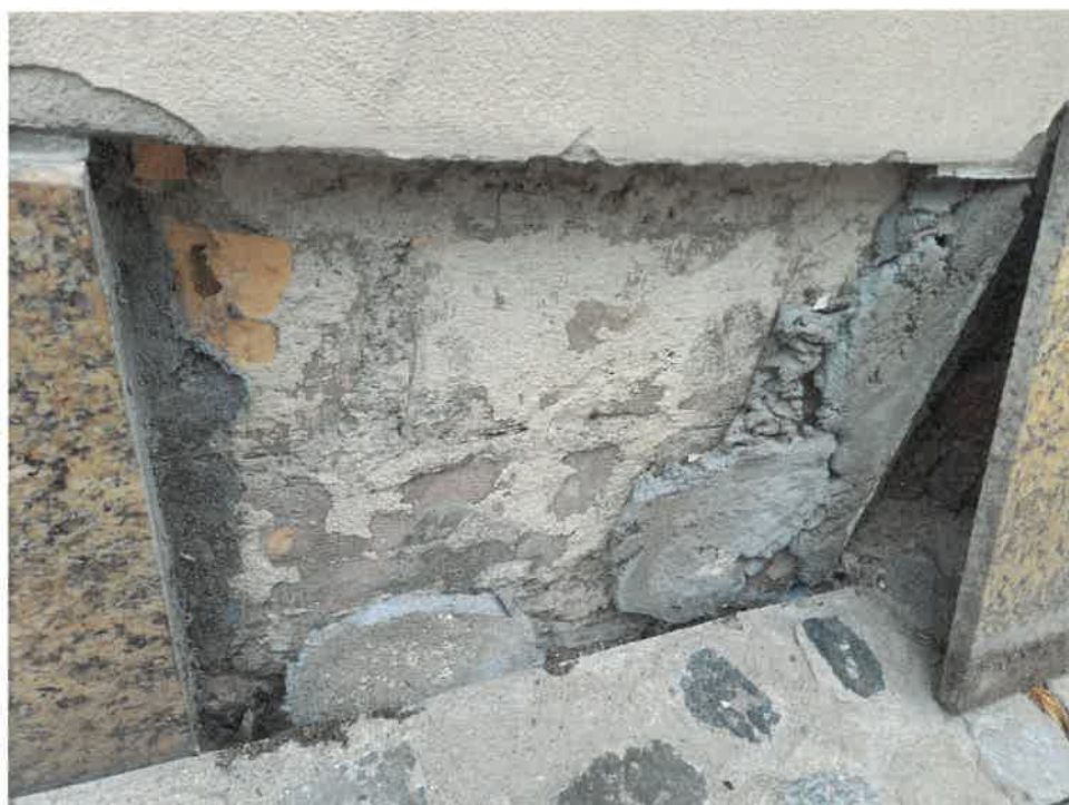
Widok ściany przyziemia (brak izolacji pionowej) od strony dziedzińca.
