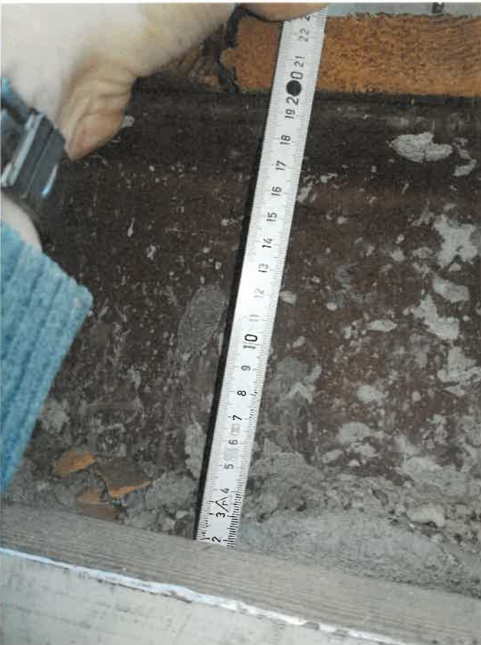
Korozja powierzchniowa rygła stalowego w/w ramy poddasza.
