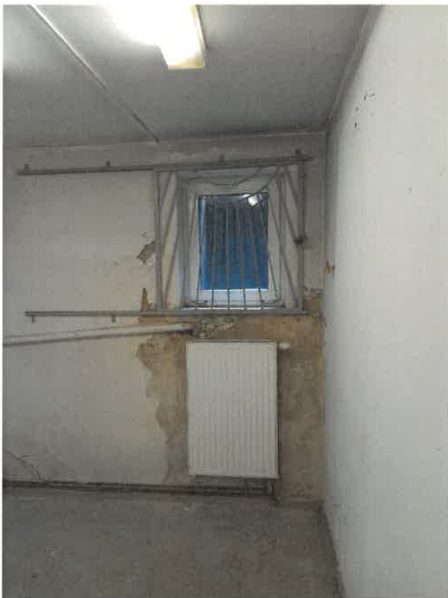
Zawilgocenie i odspojenie tynku wewnętrznego ściany piwnicznej przy naświetlu od dziedzińca.
