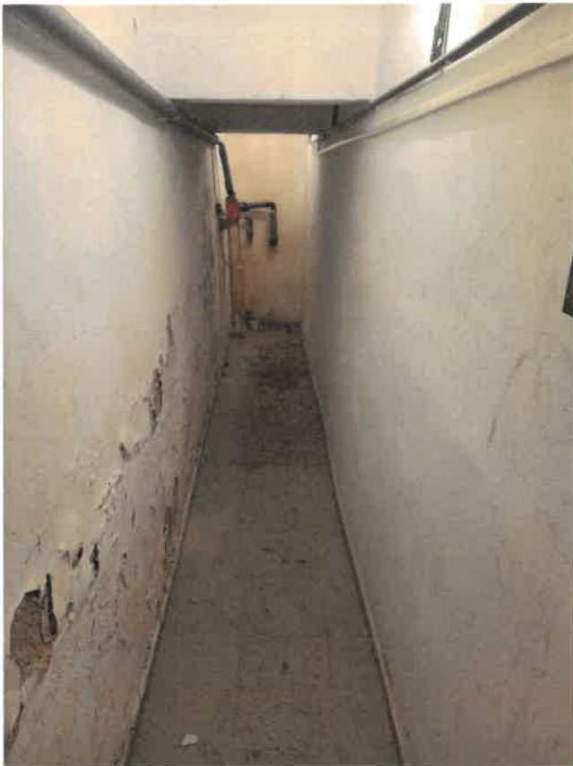
Uszkodzona okładzina tynkowa przy posadzce u góry widoczne dwie belki żelbetowe wewnętrzne.
