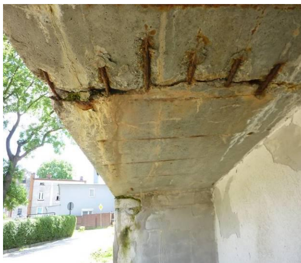
Fot. Pęknięta płyta pochylni w środku rozpiętości przęsła z zaawansowaną korozją zbrojenia
