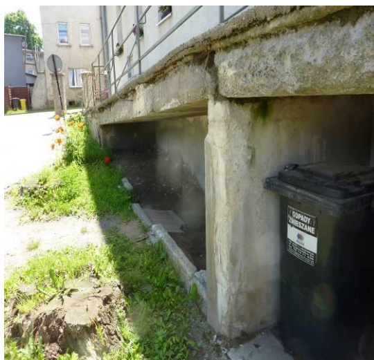
Fot. Widok pochylni. Podpora murowana z blozków. Widoczna deformacja, przecieki i ubytki materiału pomostu.
