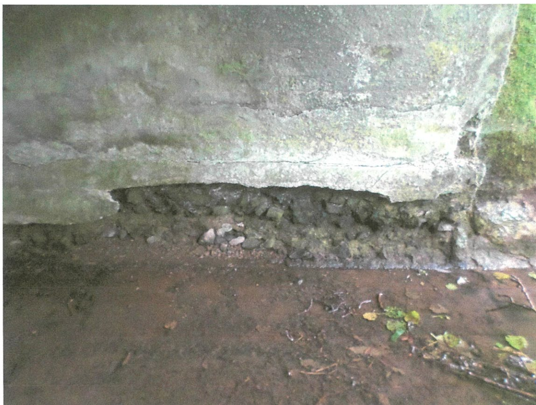
Fot. 3 . Uszkodzenia przyczółka, ubytki i erozja betonu.
