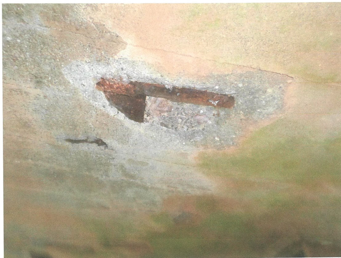
Fot. 4 . Płyta pomostowa, przecieki wody, erozja i ubytki betonu, odsłonięte skorodowane dźwigary stalowe.
