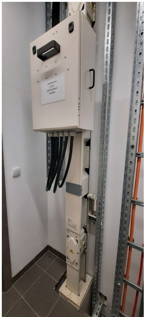
Fotografia – istniejący szynoprzewód, widok z pomieszczenia technicznego na +4.
