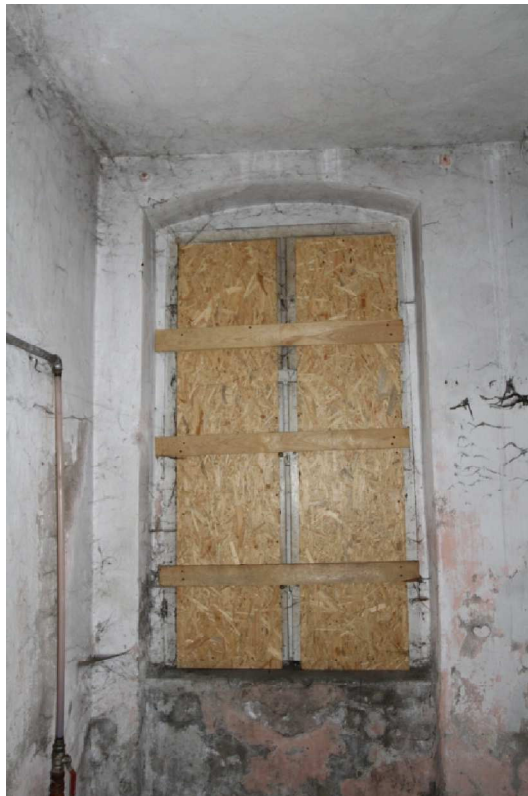
Fot. 26. Parter oficyny budynku przy ul. Spichrzowej 30 w Grudziądzu (fot. Karolina Witkowska)
