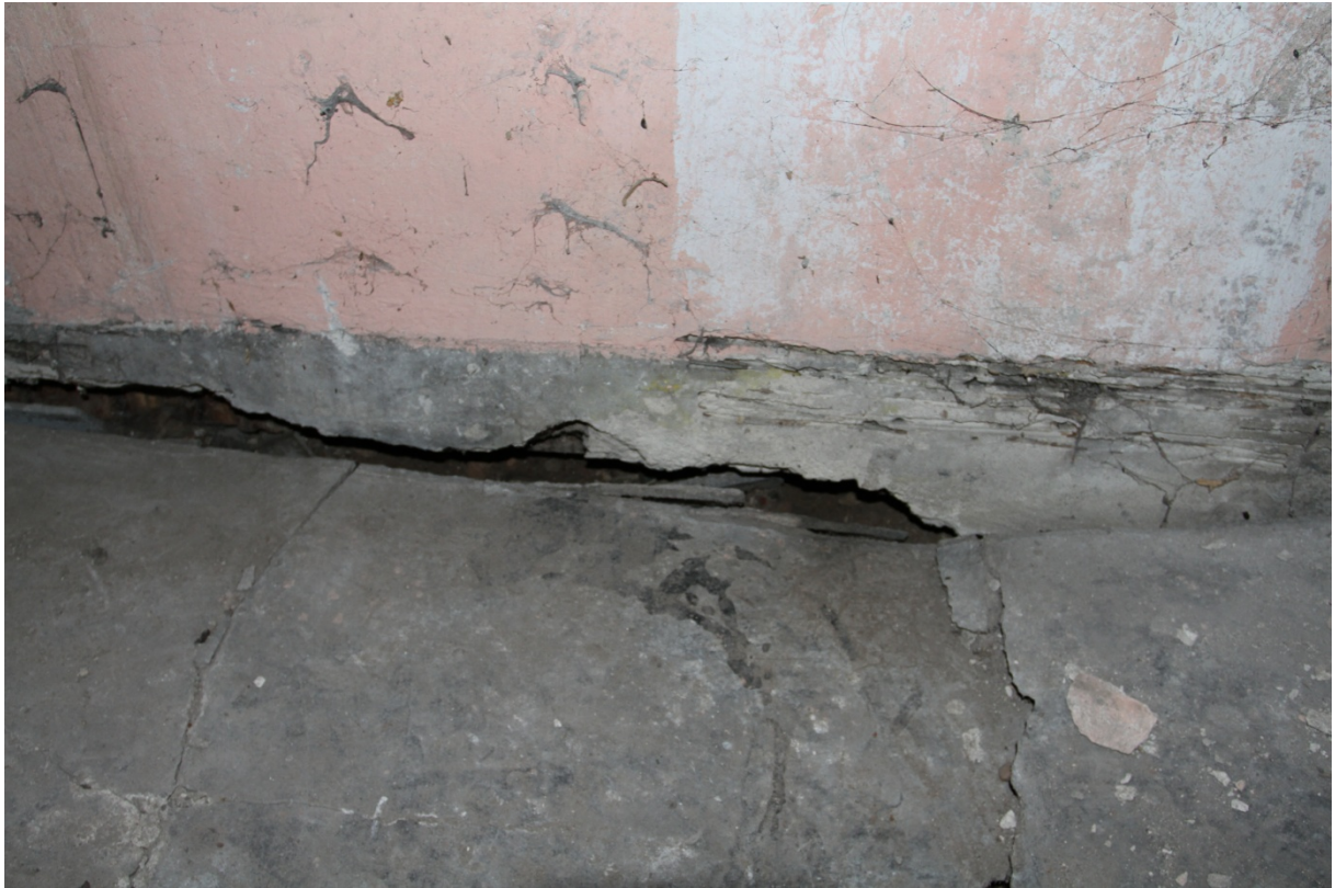
Fot. 27. Wylewka betonowa na parterze oficyny budynku przy ul. Spichrzowej 30 w Grudziądzu (fot. Karolina Witkowska)
