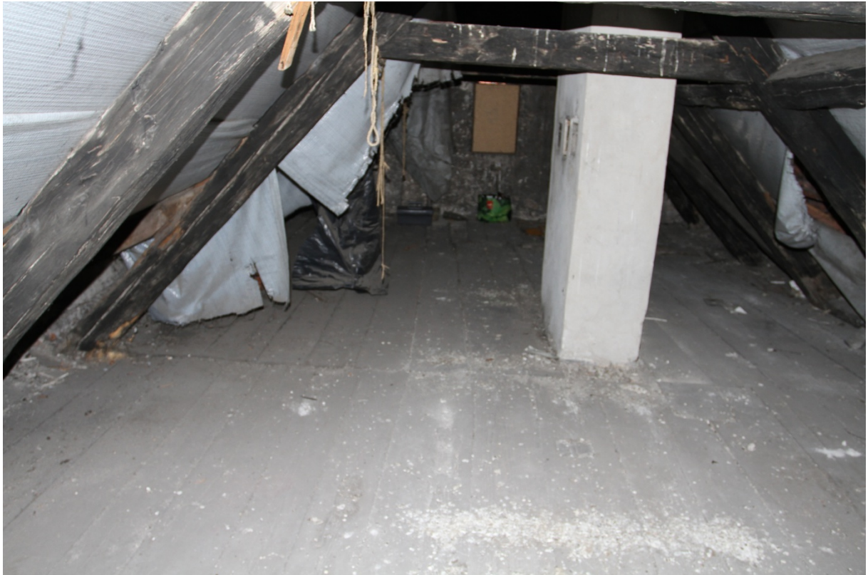
Fot. 7. Poddasze budynku przy ul. Spichrzowej 30 w Grudziądzu, zerwane folie izolacyjne (fot. Karolina Witkowska).
