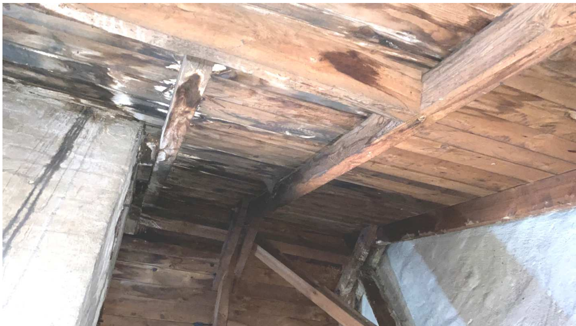
Fot. A. Zacieki dachu przy kominie
