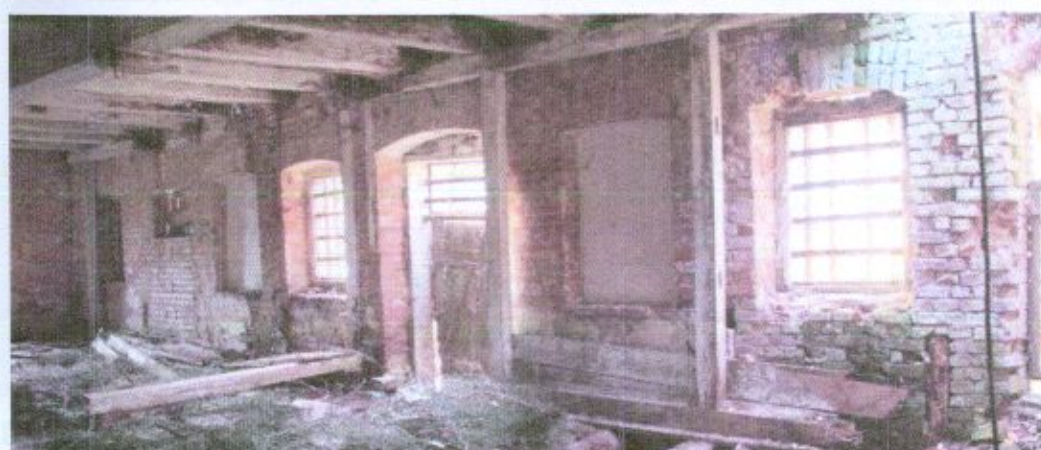
Fot. 19-20. Stan zachowania otworów okiennych w 2021 r.
