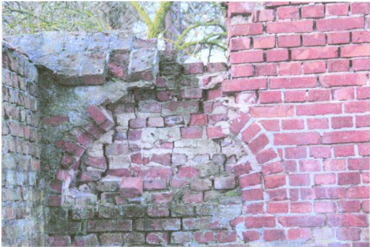
Fot. 45-47. Druga część bramy, słupek oraz pozostałości pierwotnego muru są w bardzo złym stanie zachowania. Widać liczne ubytki w cegle oraz spoinie. Widoczne są wtórne prace naprawcze z zastosowaniem cementowej spoiny, która niekorzystnie wpłynęła na bramę zabytkową. Na powierzchni cegieł widoczna jest zaprawa cementowa, która jest pokryta przez mchy i porosty. Łuk znajdujący się między słupkiem bramy a murem uległ destrukcji.
