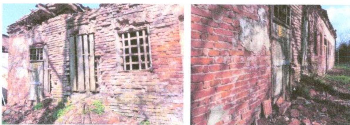
Fot. 24-25. Część północna elewacji zachodniej w najgorszym stanie poprzez zawalony dach. Elewacja z licznymi ubytkami w cegle i spoinie. Pod murami elewacji widoczna dachówka, która spadła podczas zawalenia się dachu.
