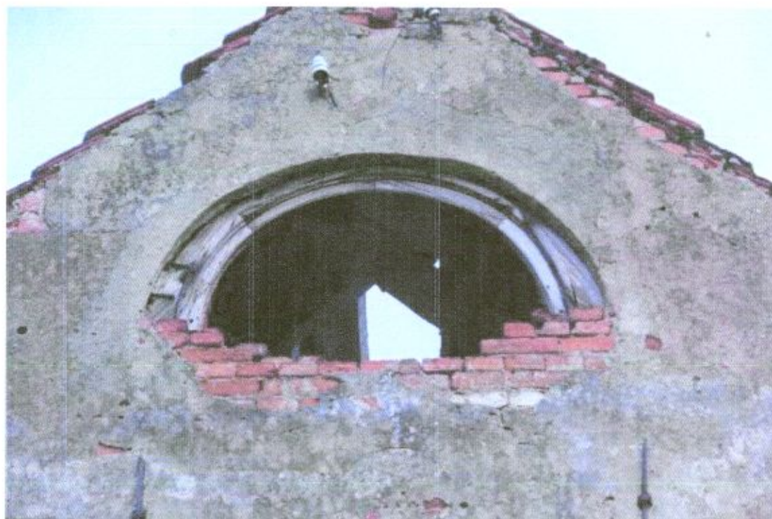
Fot. 33. Na samym szczycie zachowała się oryginalna ościeżnica otworu okiennego.
