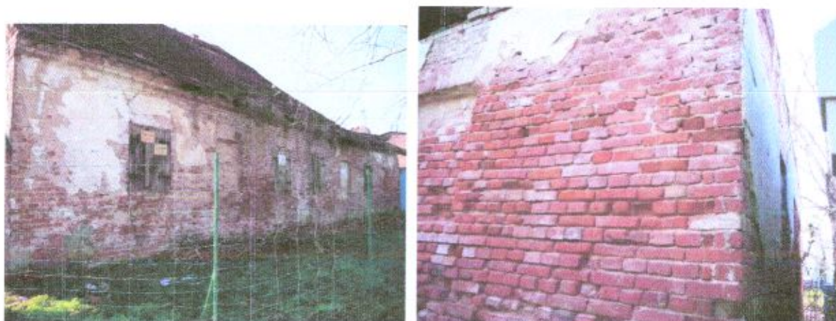
Fot. 2-3. Od wschodniej strony mury spichrza są w bardzo złym stanie. W części, gdzie dach się zawalił cegły sypią się i pudrują, pozbawione są oryginalnego spieku. Widoczne pozostałości po dawnym tynku i boniach. W większości tynk odpadł od powierzchni lica ściany.
