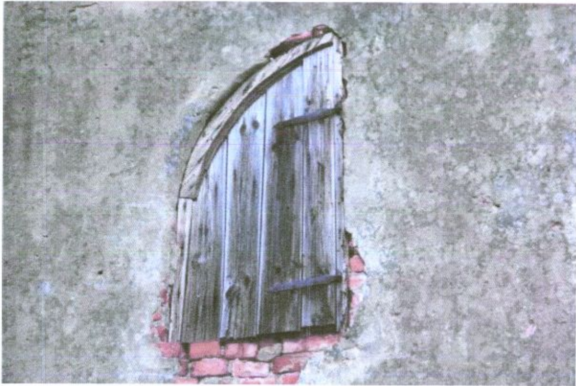
Fot. 34. Po lewej stronie elewacji zachowała się ościeżnica ze skrzydłem okienicy założona na zawiasy.
