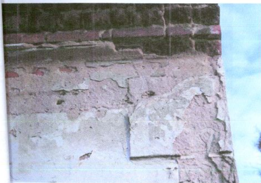
66-67. Szczątkowe pozostałości gzymsu w 2021 r.
