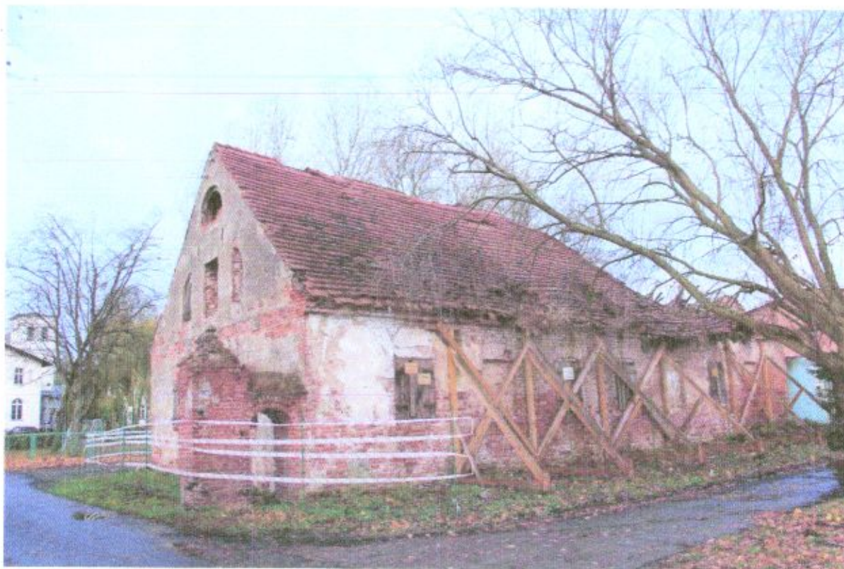
Fot. 1. Budynek dawnego spichlerza jest w stanie katastrofalnym, grozi zawaleniem. Na elewacji znajduje się tynk w złej kondycji, który odspaja się i odpada od lica muru. Dach z dachówki karpiówki wraz z więźbą dachową jest w bardzo stanie, liczne są ubytki w dachówkach. Od strony północnej dach się zawalił.
