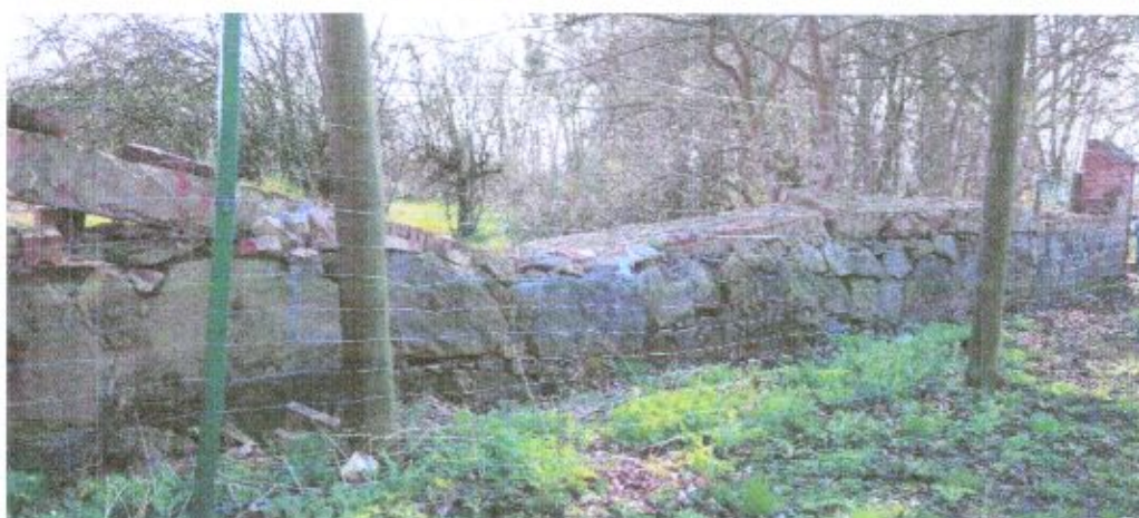
Fot. 52-53. Mur ceglany na fundamencie kamiennym (mur cyklopowy) oddziela drogę dojazdową do pałacu od sadu. Mur uległ zawaleniu, prawdopodobnie jest to spowodowane zastosowaniem zaprawy cementowej w poprzednich pracach remontowych. Zaprawa ta widoczna jest pomiędzy ceglami jak również pomiędzy kamieniami polnymi.
