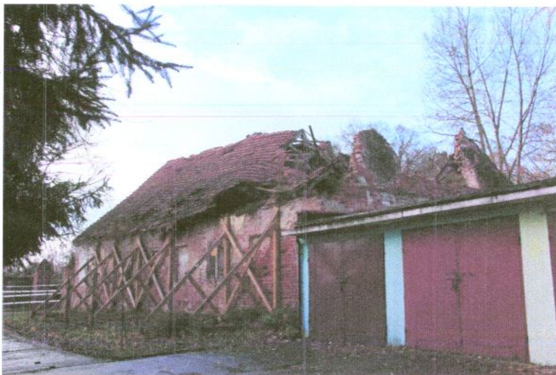
Fot. 37. Elewacja północna od strony garaży jest w najgorszym stanie. Konstrukcja elewacji uległa destrukcji za sprawą zawalenia się dachu. Szczyt spichrza w większości wpadł do środka. Mur jest przechylony i grozi zawaleniem.
