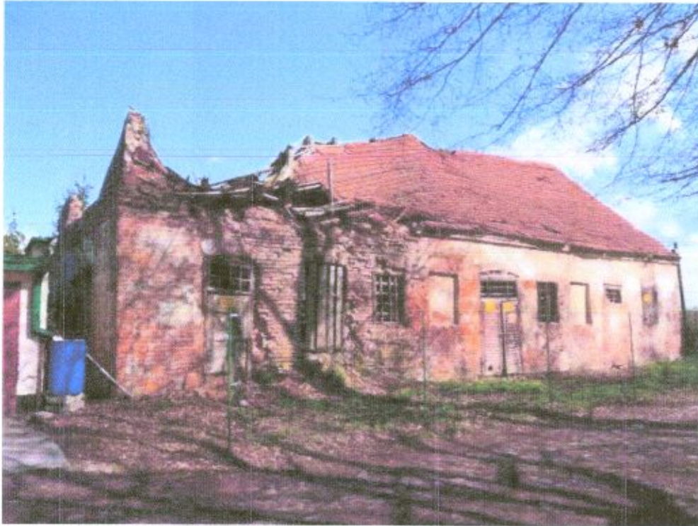
Fot. 15. Od strony elewacji zachodniej widoczny jest zawalony dach. Ściany poniżej zawalonego dachu w bardzo złej kondycji. Cegły sypią się i pudrują, pozbawione są oryginalnego spieku. Gzyms jest uszkodzony. Pomiędzy ceglami brak spoiny, ponieważ została wypłukana.
