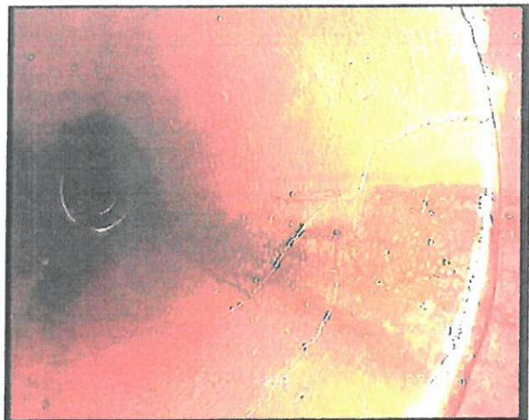
27.51 m - [RC-R] rysa, złącze rur, z prawej
