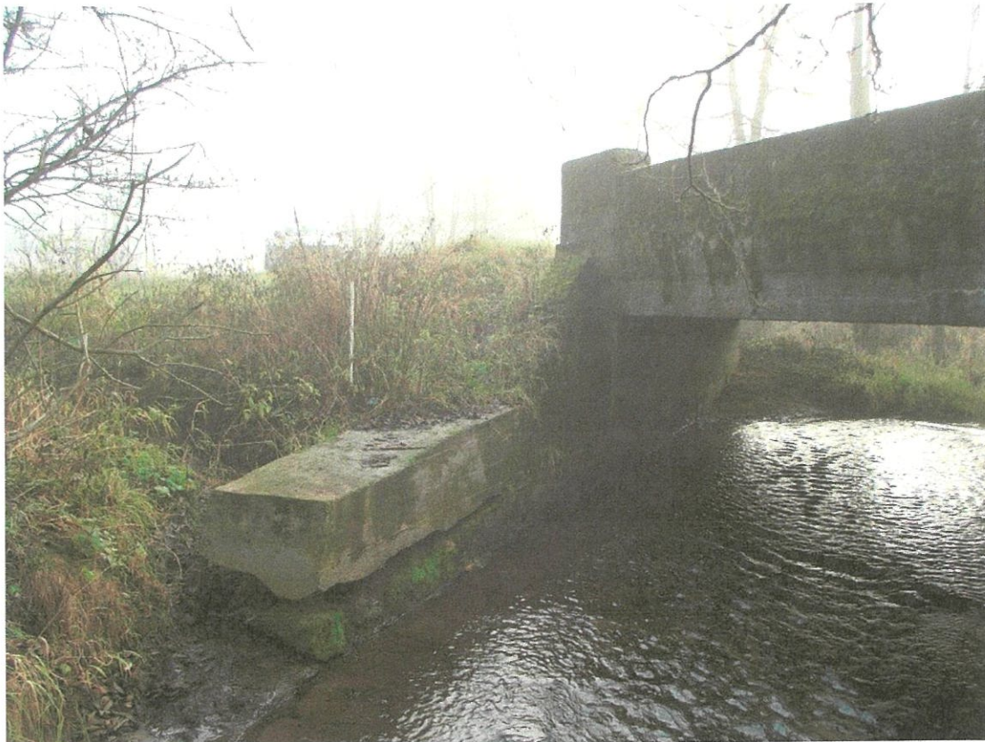
Fot. 3 . Uszkodzenia skrzydełka, erozja i ubytki betonu.
