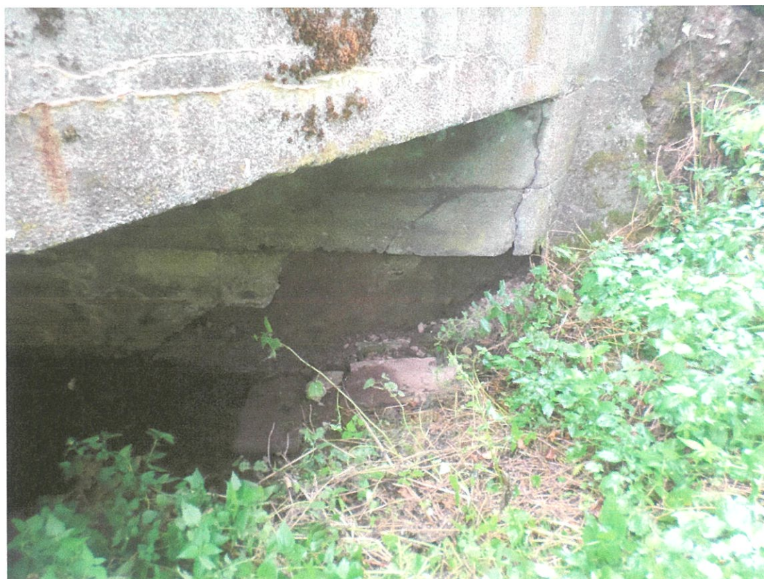
Fot. 2 . Erozja betonowego przyczółka prawobrzeżnego, zarysowania i ubytki betonu.
