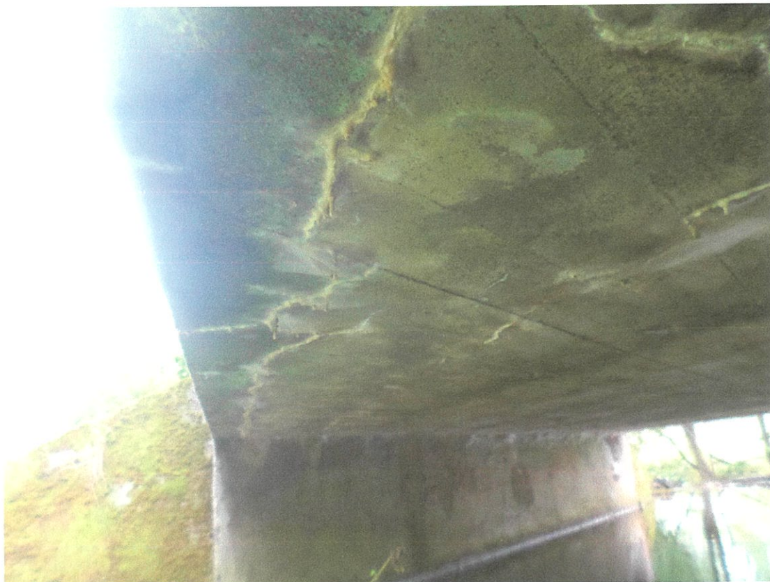
Fot. 4 . Zarysowanie płyty pomostowej, przecieki wody, wykwity na powierzchni betonu.
