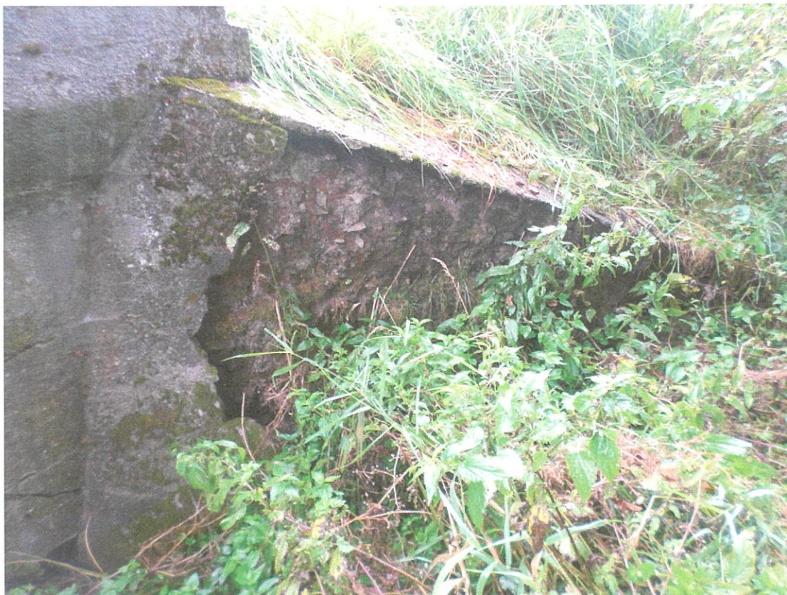
Fot. 1 . Erozja betonu skrzydełka – zniszczenie struktury materiału.
