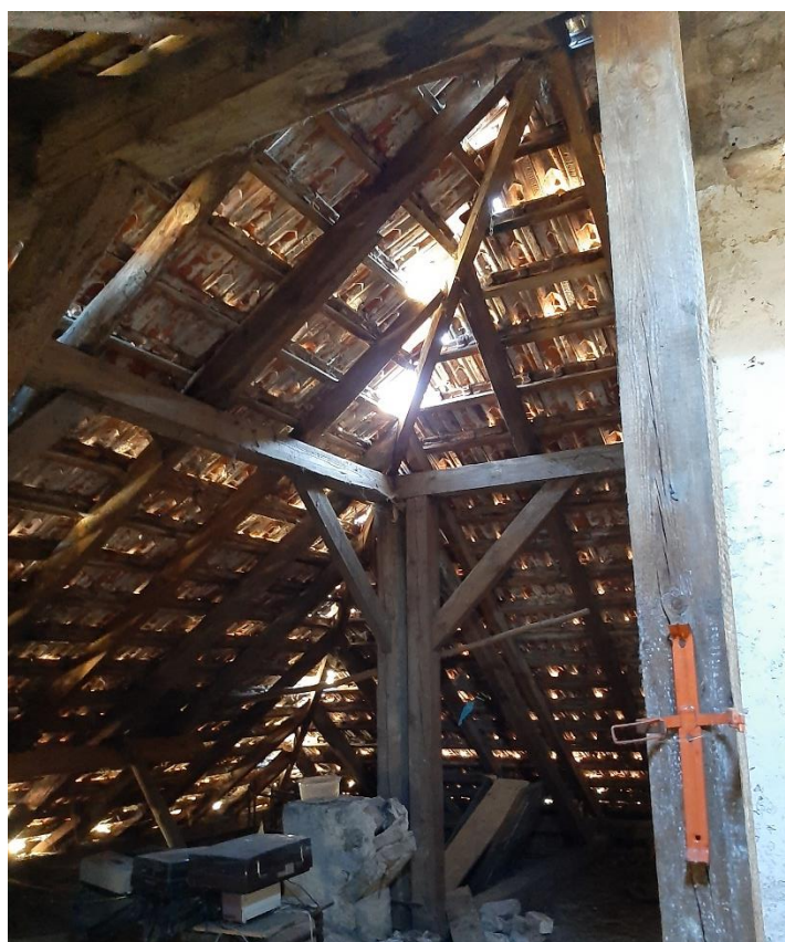
Widok konstrukcji dachu (widoczne ubytki w pokryciu)
