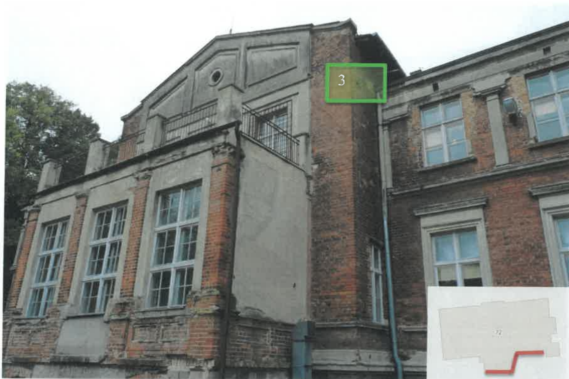
Fot. 2 – Elewacja południowa, zaznaczono opuszczone siedlisko ptaków.
