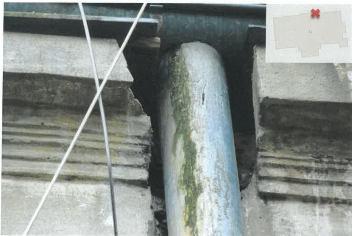
Fot. 15 – Potencjalne siedlisko ptaków w przestrzeni za przewodem spustowym rynny.
