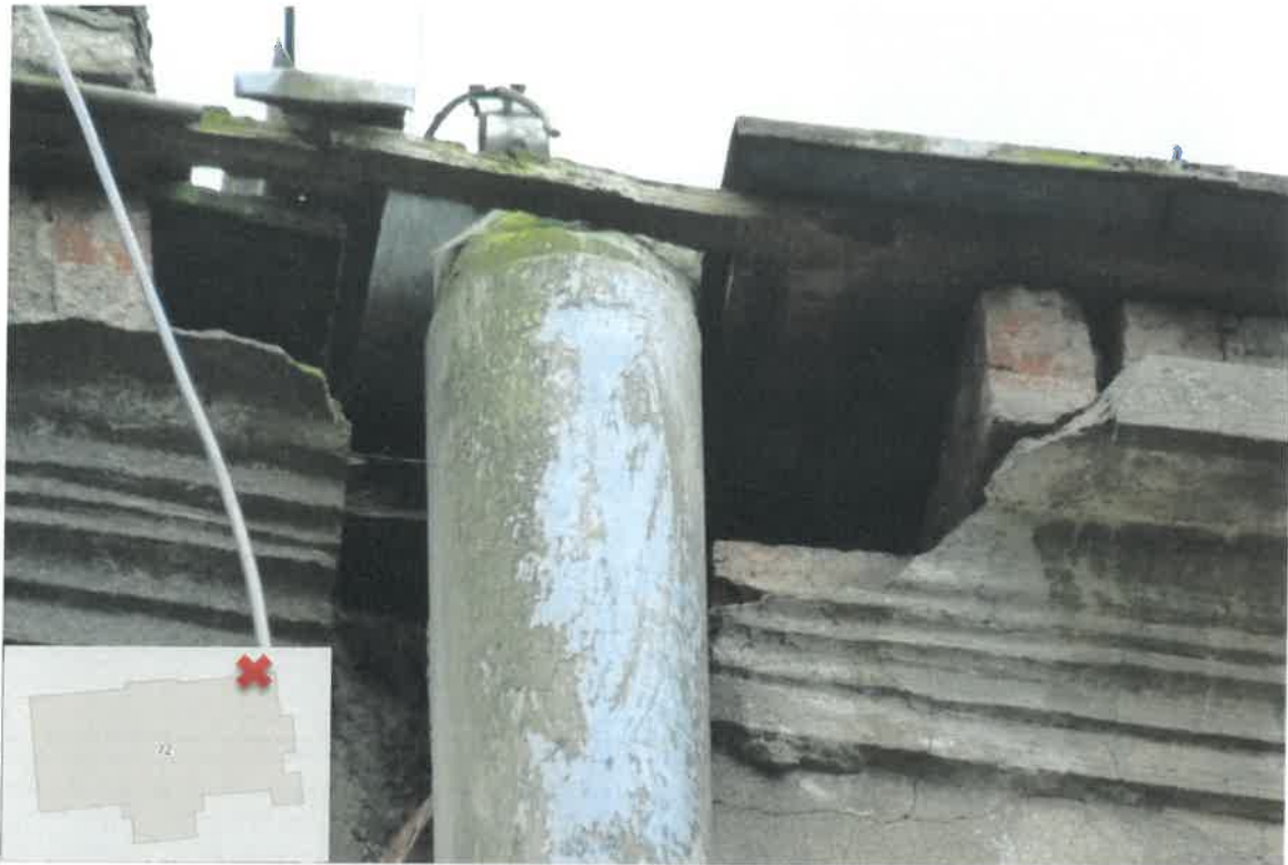
Fot. 14 – Potencjalne siedlisko ptaków w przestrzeni za przewodem spustowym rynny.
