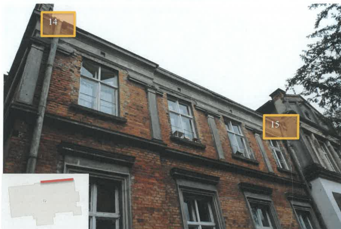
Fot. 13 – Elewacja północna, wskazano potencjalne siedliska ptaków.
