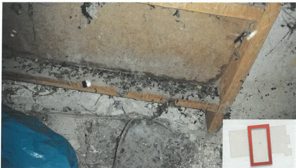
Fot. 28 – Odchody nietoperzy pod ścianą.
