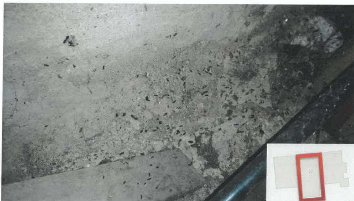
Fot. 27 – Odchody nietoperzy pod ścianą.
