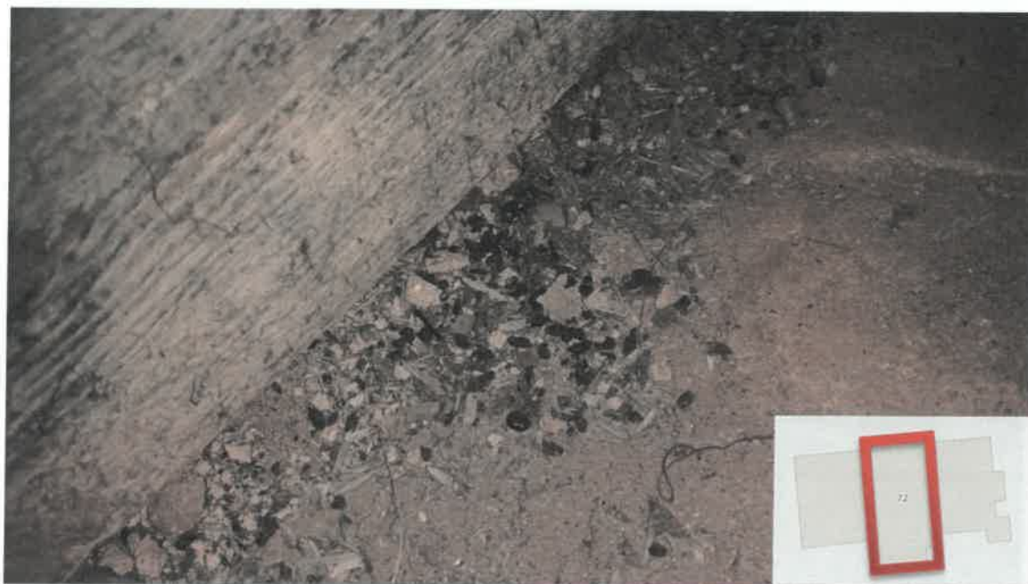
Fot. 23 – Odchody nietoperzy pod ścianą.
