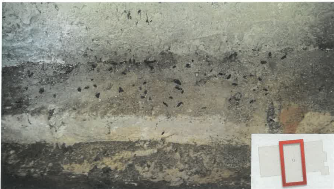
Fot. 24 – Odchody nietoperzy pod ścianą.
