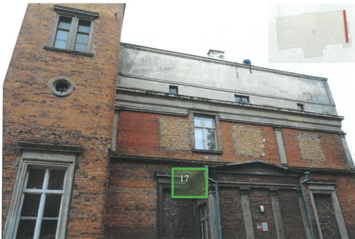
Fot. 16 – Elewacja wschodnia, wskazano siedlisko nietoperzy.
