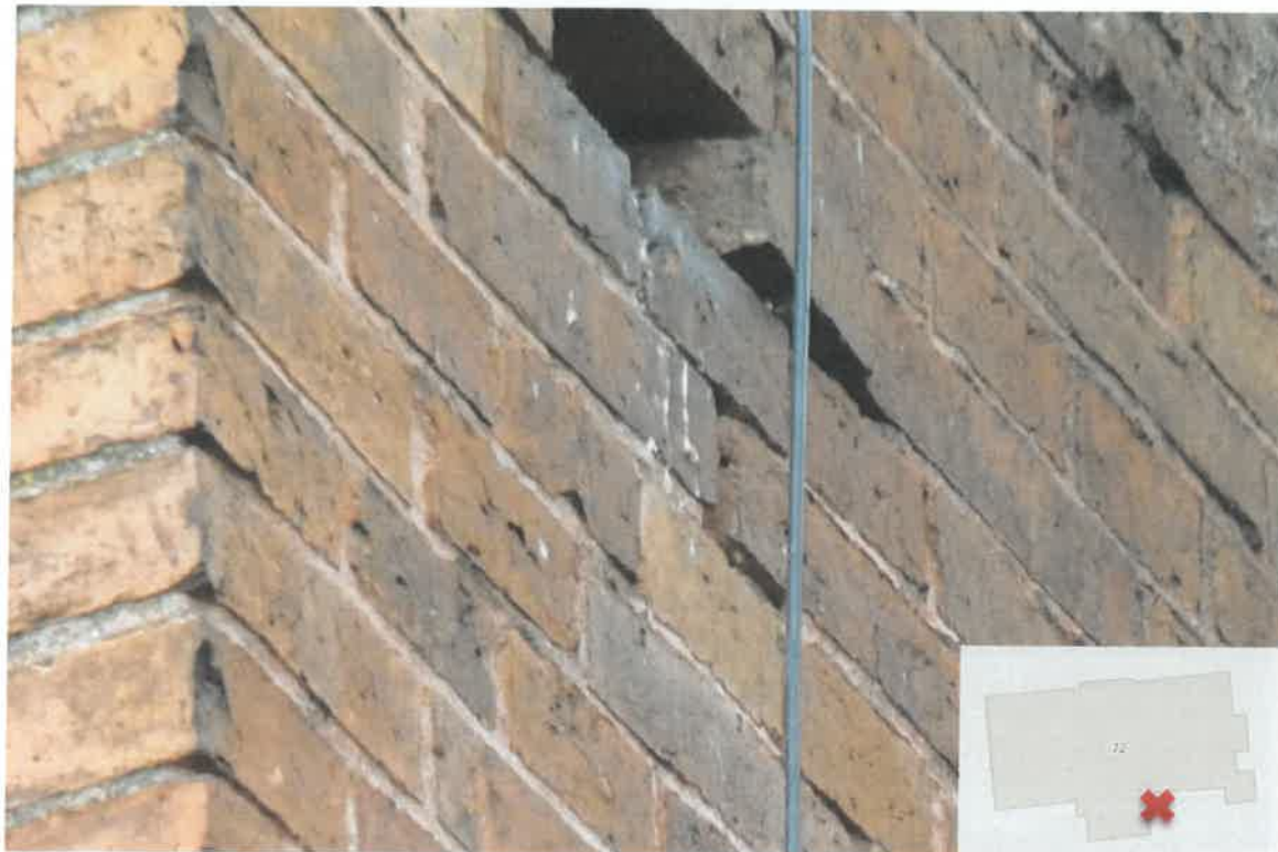
Fot. 3 – Szczelina w ścianie ze śladami kału ptasiego pod spodem. Siedlisko ptaków, potencjalne miejsce gniazdowania.
