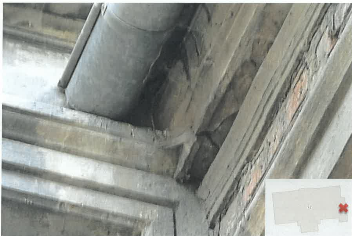
Fot. 17 – Zimowisko nietoperzy w szczelinie elewacji przy rynnie.
