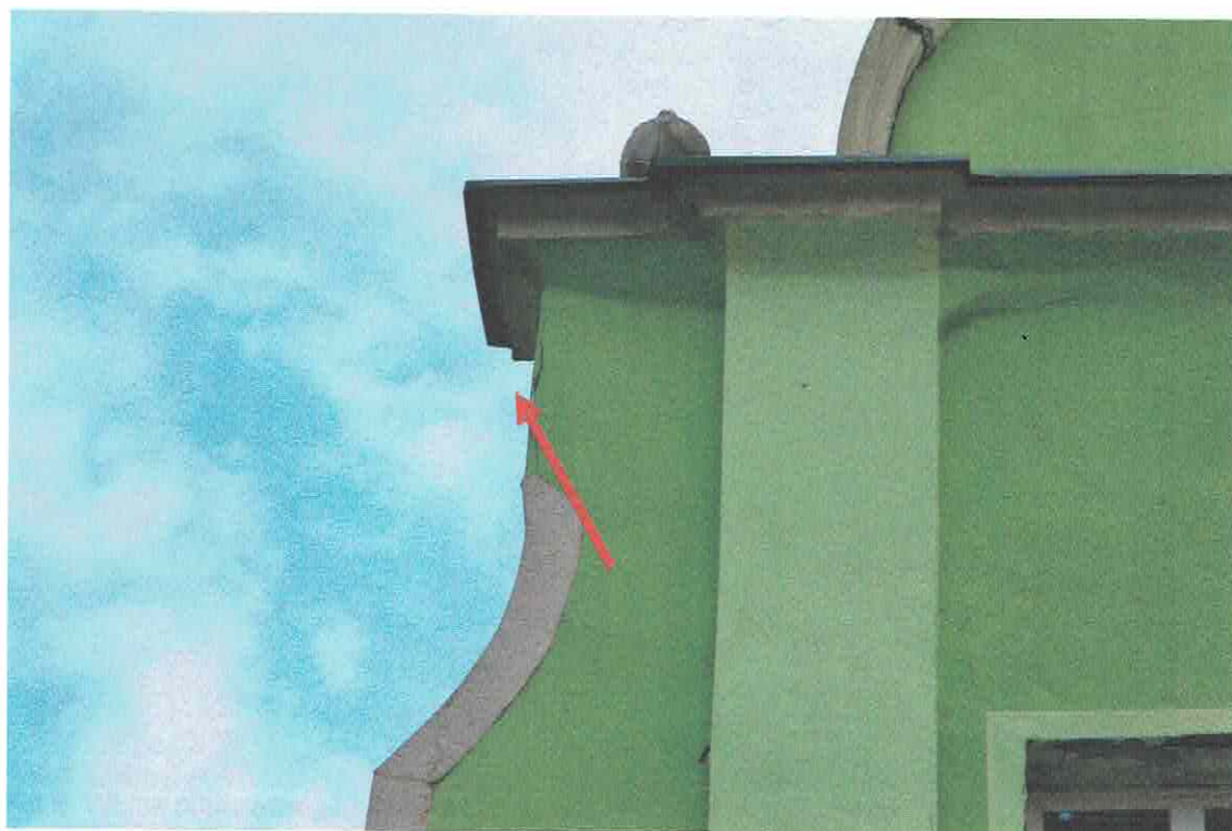
Fot.4. Gzyms nad II piętrzem budynku. Kolejne odspojenie tynku stanowiące zagrożenie dla bezpieczeństwa.
