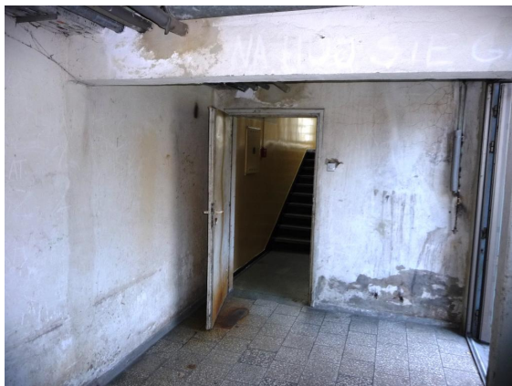
Fot. 11. Zawężone wyjście z klatki KL6
