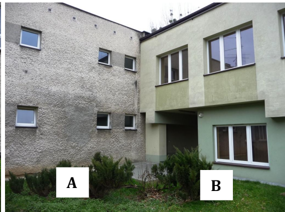
Fot. 14. Ściany segmentu A i B
