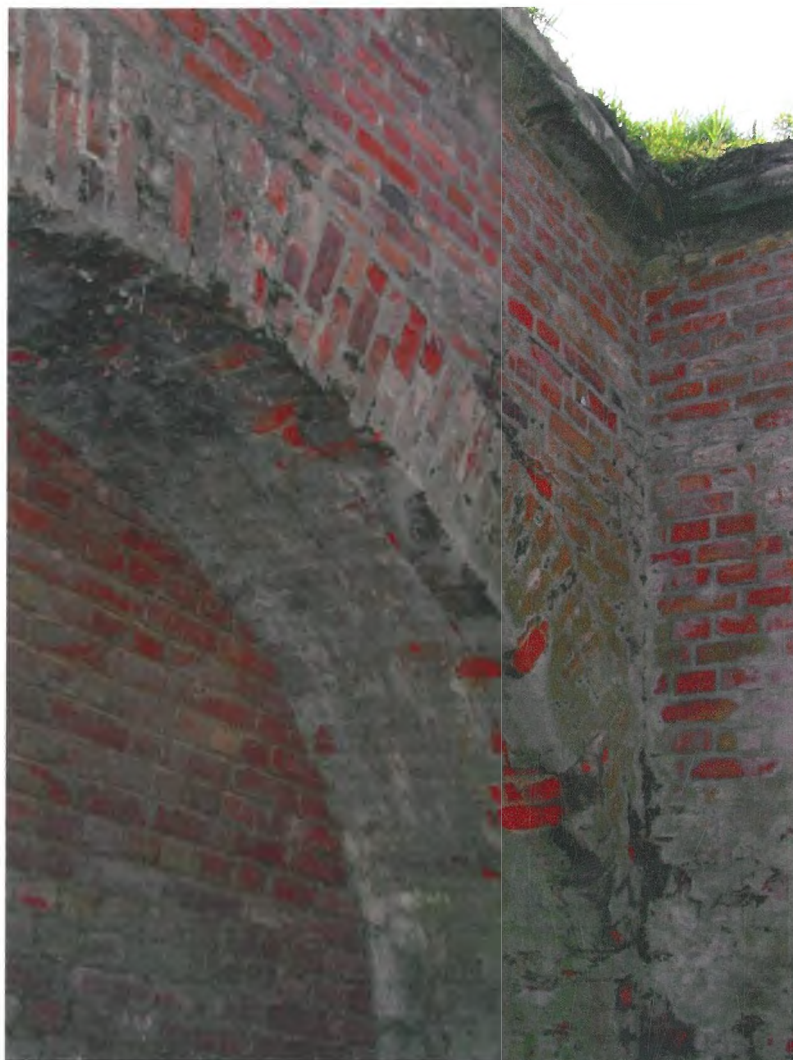
Zdj. 10 Rozwarstwienia licówki na łukach w działobitni Bastionu Południowo-Wschodniego
