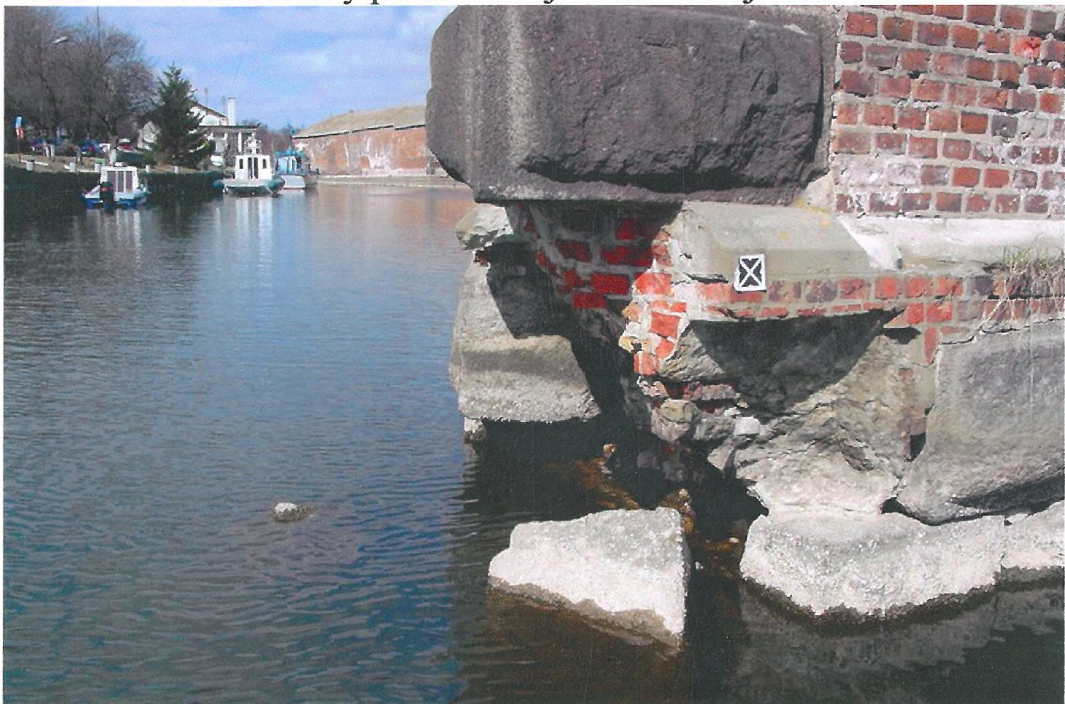
Fot. 4 Szczegół zniszczonego narożnika ścian południowej i wschodniej bastionu
