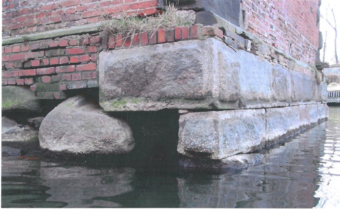
Fot. 7 Wnęki pomiędzy kamieniami w fundamencie Bastionu Południowo-Wschodniego
