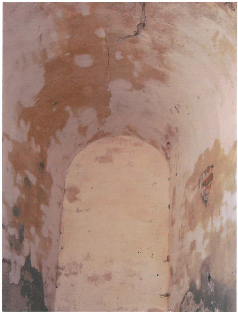
Zdj. 9 Spękania sklepień w pomieszczeniach Bastionu Południowo- Wschodniego
