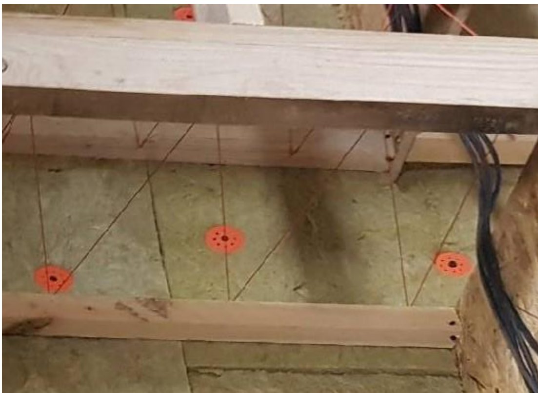
Rys. 38: Plecionka ze sznurka do podtrzymywania luźnej wełny mineralnej wypełniającej przestrzeń za płytą akustyczną.
