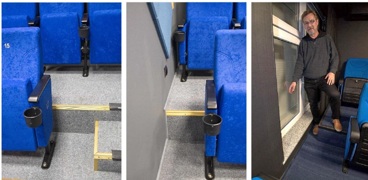
Rys. 51: Przykłady nieprawidłowego zabezpieczenia przejść. Nogi foteli powinny dotykać do krawędzi stopnia. Każda wolna przestrzeń musi być oświetlona listwą krawędziową, a przy różnicy poziomów >50 cm zabezpieczona barierką. Cała wnęka okienna musi być zabezpieczona podwójną poziomą barierką biegnącą na krawędzi najwyższego poziomu podestu.
