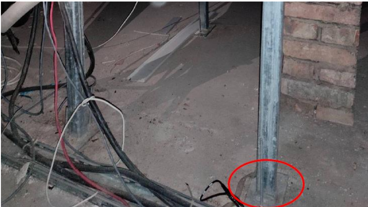
Rys. 8.2: Konstrukcja wsporcza urządzenia klimatyzacyjnego w przestrzeni międzystropia.
