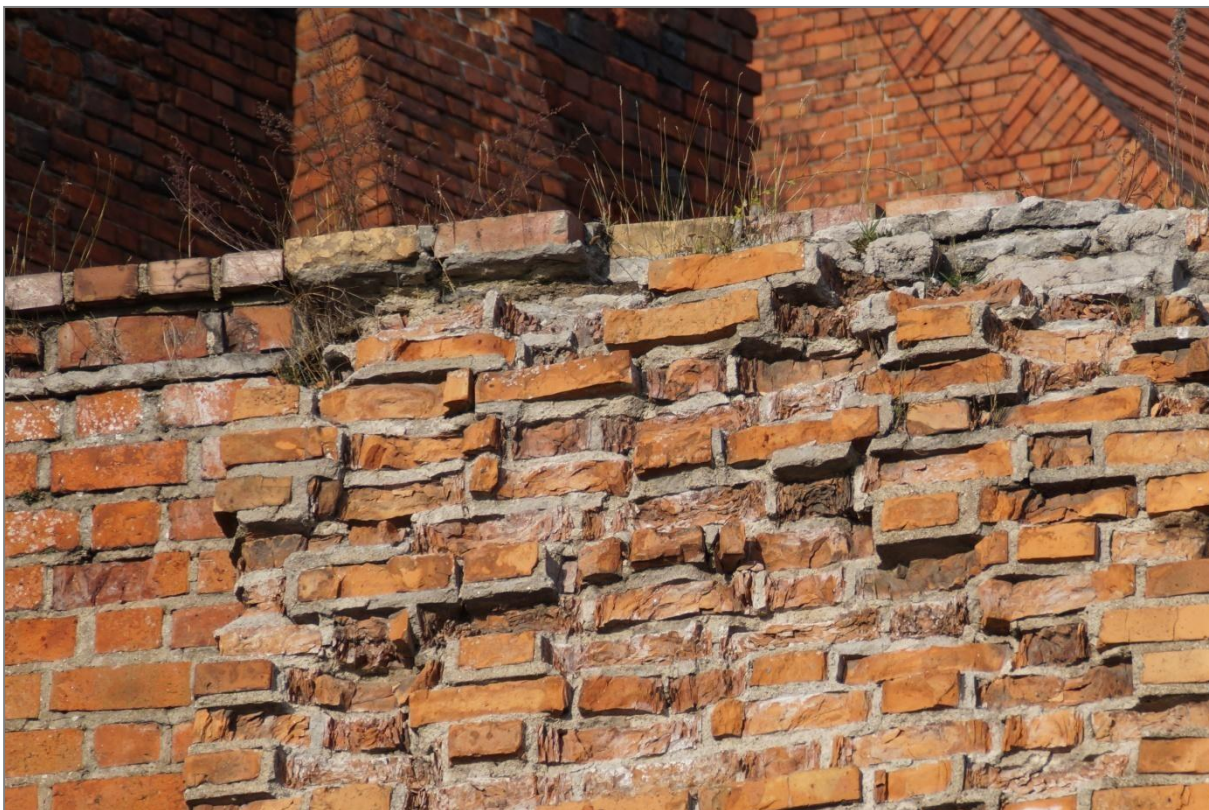
28. Zniszczona korona muru i zwieńczenie jednej z przypór .
