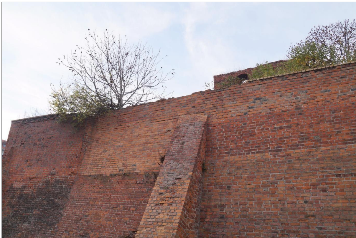
34. Uszkodzona korona we wschodniej części muru. Krzew rosnący po zachodniej stronie muru ekspansywnie rozrasta się w kierunku muru, jego gałęzie pokładają się na koronie muru.
