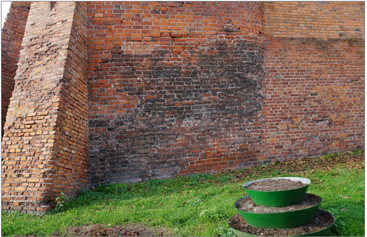
32. Obszar muru pokryty czarnymi nawarstwieniami korozyjnymi.
