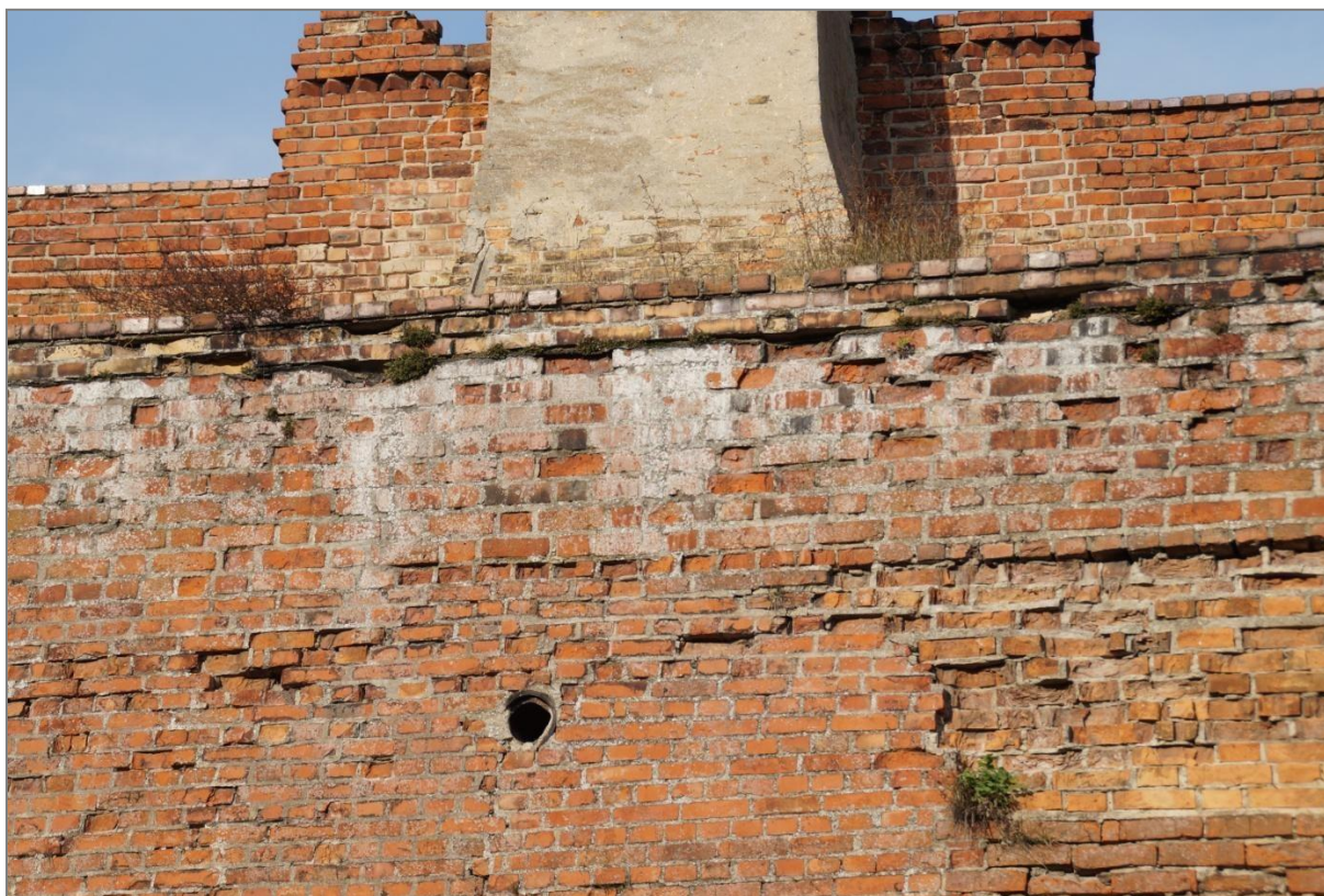
22. Górne partie muru - białe naloty naniesione przez wodę spływającą z uszkodzonej korony muru.
