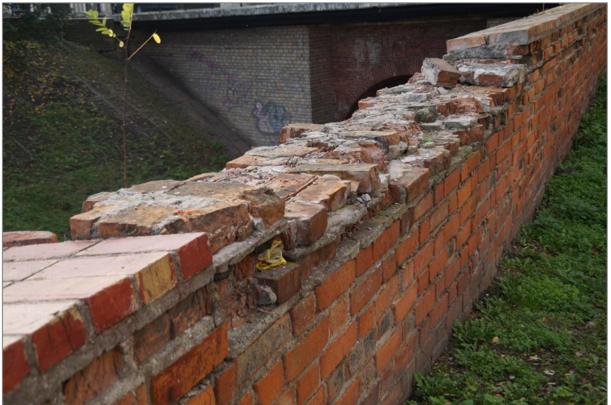
44., 45. Zniszczenia południowej korony muru - widok od strony północnej.
