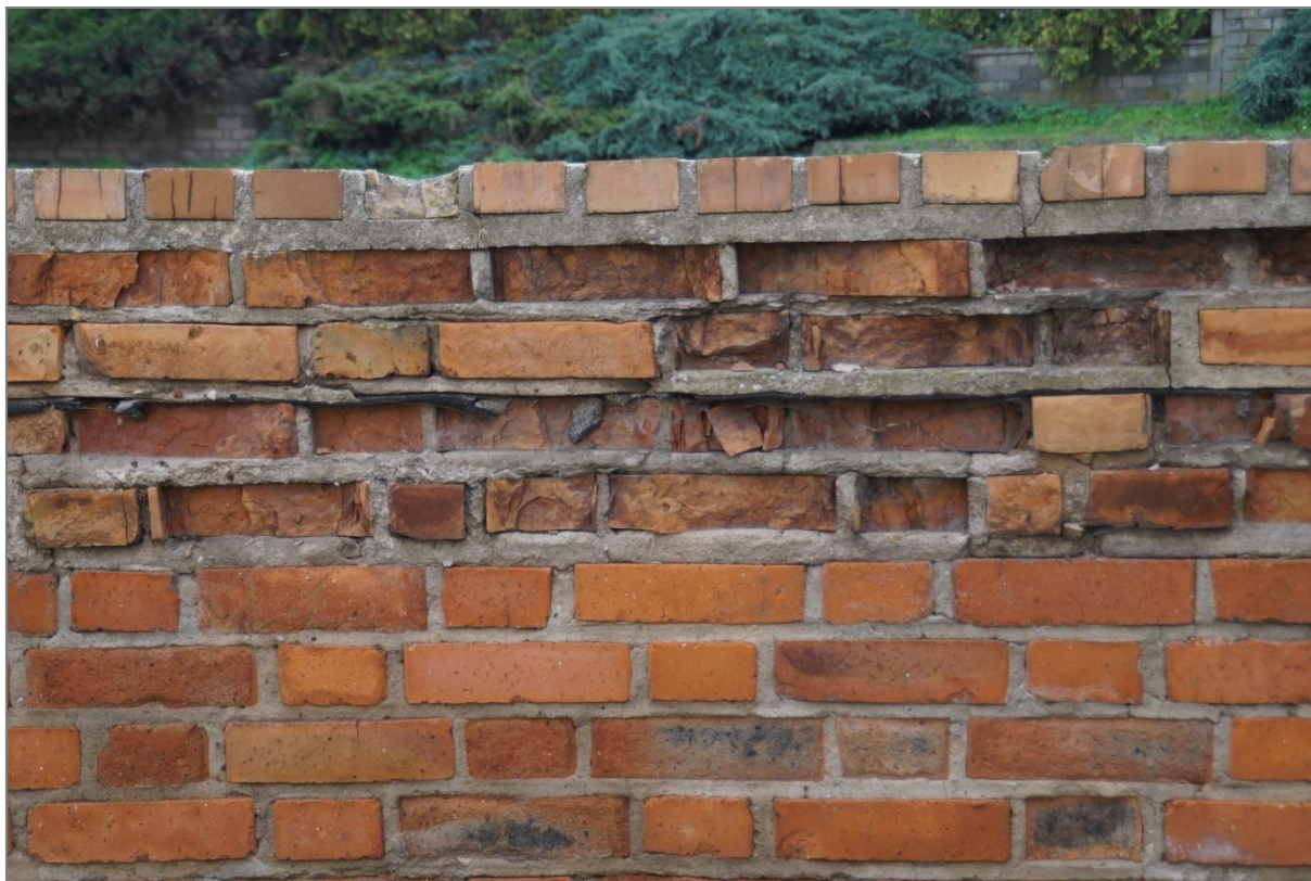
46. Zniszczenia południowej korony muru sięgające czterech warstw w głąb muru
