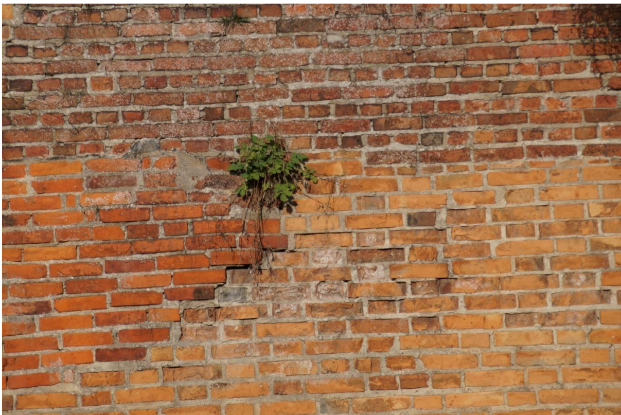
19., 20. Lico muru wymurowane cegłą różniącą się kolorem i rozmiarami, układaną w wążku gotyckim, wozówkowym i krzyżowym. Ubytki w ceglach i spoinach zasiedlają kępy roślin.
