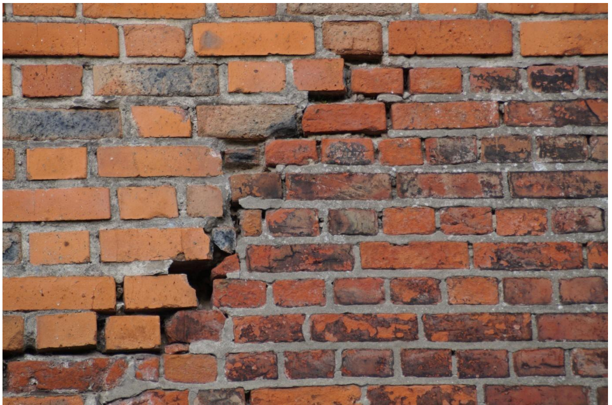
16. Pęknięcie muru na styku dwóch rodzajów oblicowania różniących się wymiarami cegieł i sposobem ich układania.
