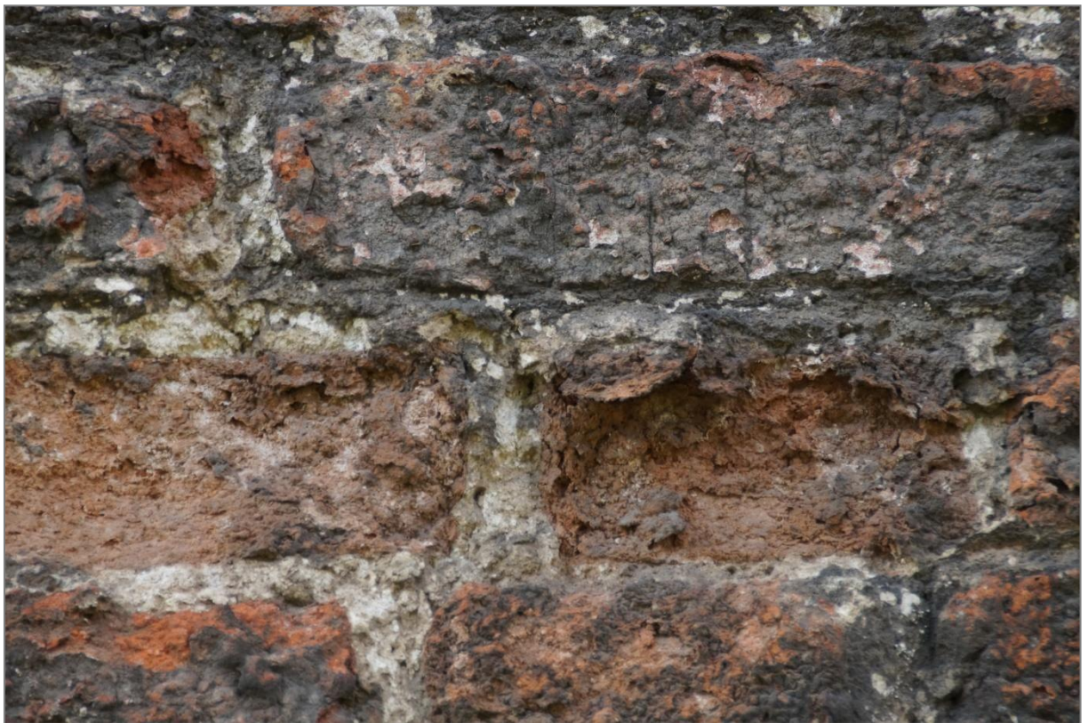
33. Skorupiate , szczelne nawarstwienia, które przyczyniają się do destrukcji cegieł.
