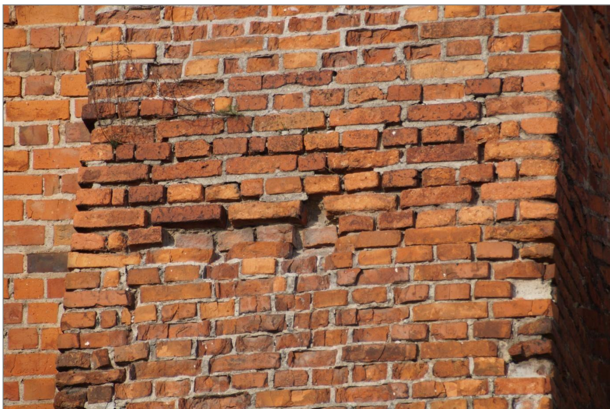
29. Środkowa partia przypory z licem uszkodzonym i częściowo pozbawionym spoin. Miejsca po ceglach w krawędzi przypory wypełnione zaprawą.
