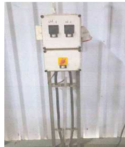
d) Hala magazynowa B5 – rozdzielnia główna
