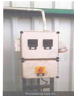
b) Hala magazynowa A1 – rozdzielnia główna
