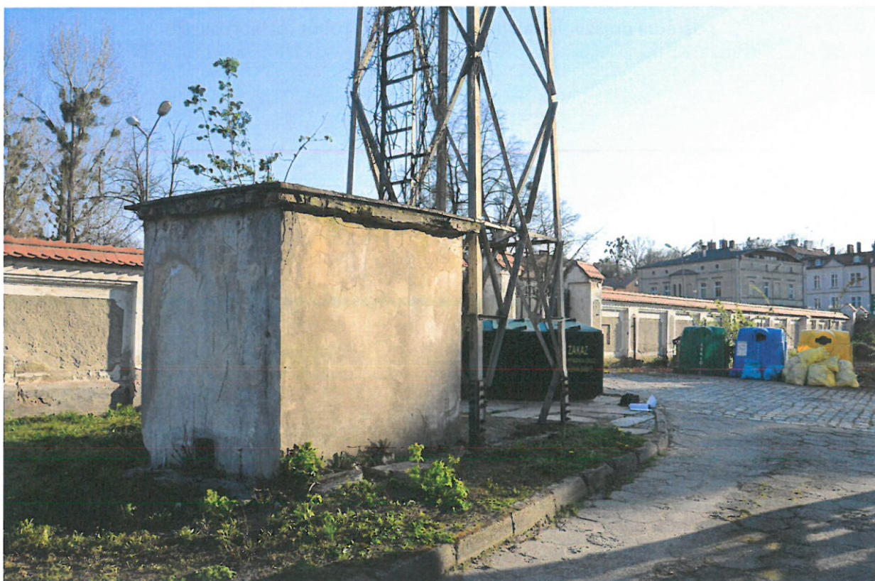
Fot. 4. Podstawa wieży i kabina techniczna
