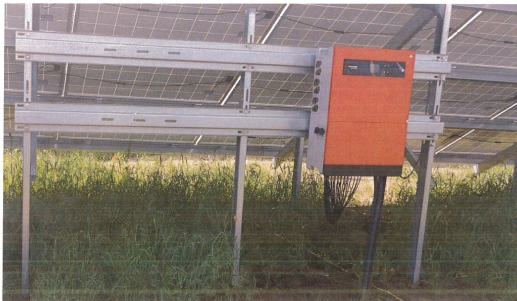
[Fot.3] inwerter zamontowany do konstrukcji nośnej, z podłączonymi przewodami DC (panelami PV) i podłączony do sieci nn AC 50Hz i DC.
