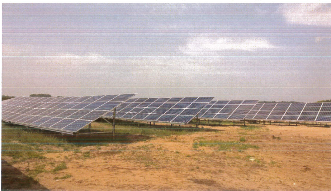
[Fot.2] konstrukcja nośna z zamontowanymi panelami fotowoltaicznymi.
