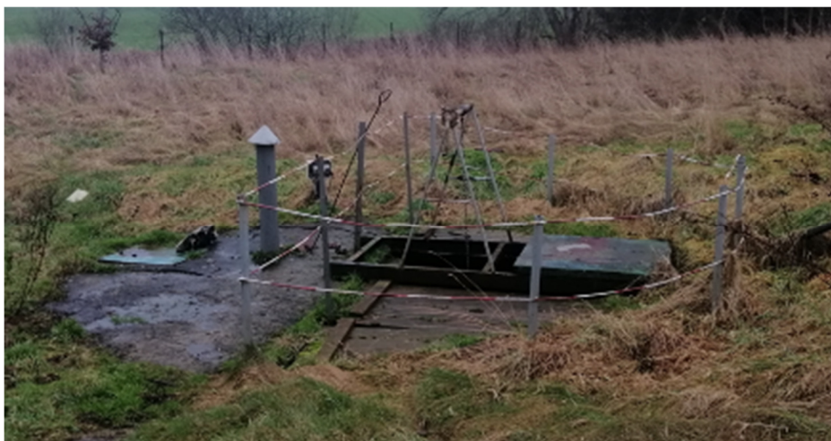
Fot. 3 – Pompownia główna
