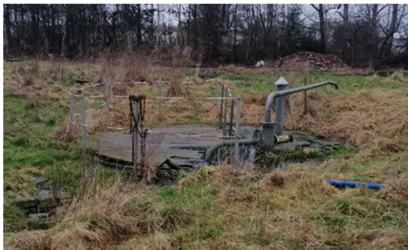
Fot. 6 – Przepompownia osadu nadmiernego
