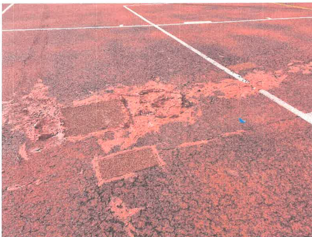
Fot. 3 Uszkodzenia nawierzchni boiska
