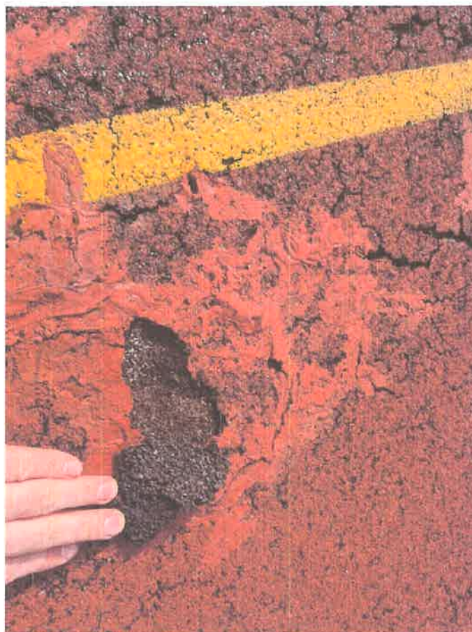
Fot. 4 Uszkodzenia nawierzchni boiska
