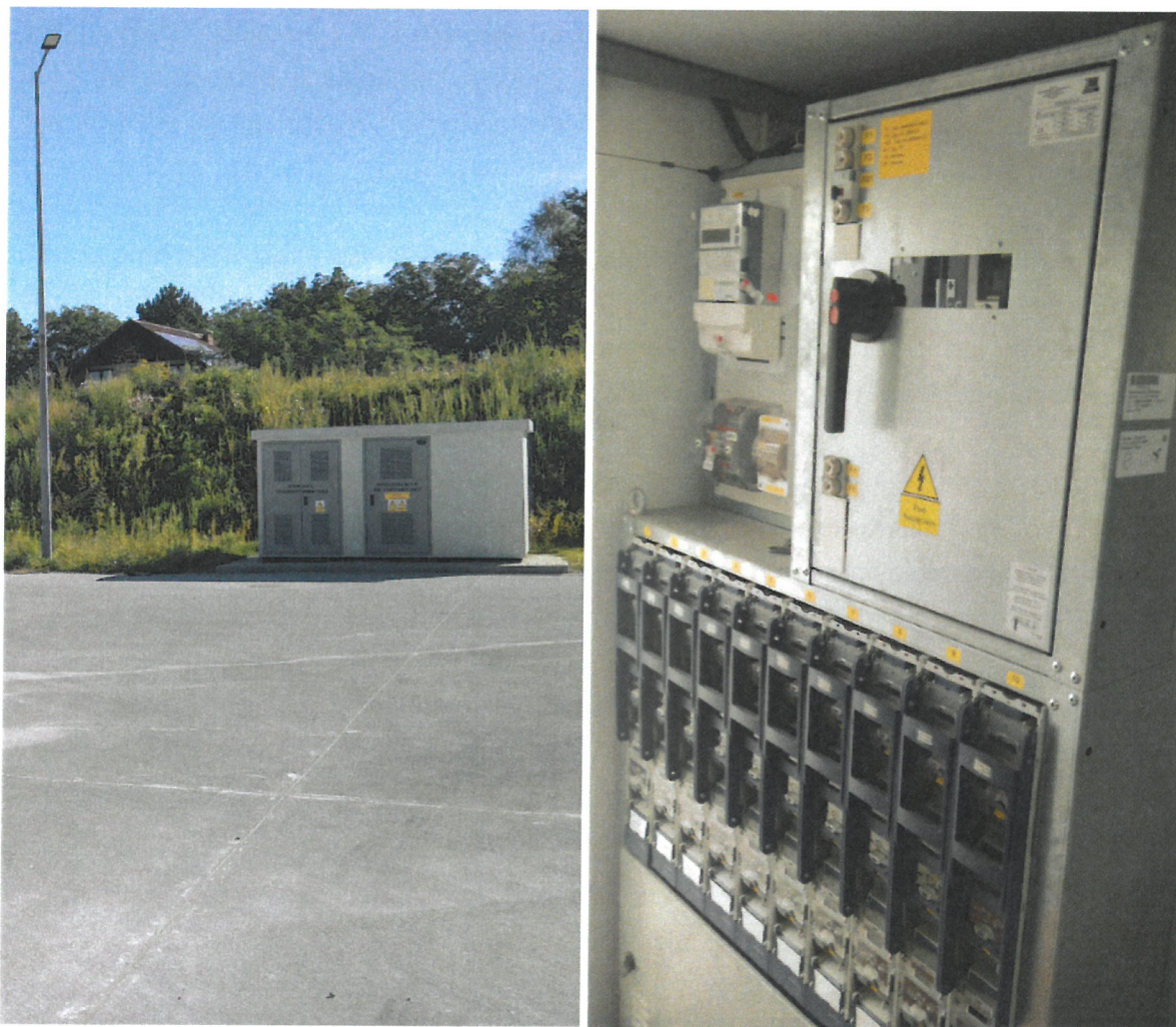
Rys. 4. Zdjęcia stacji transformatorowej w tle nasypu pod mikroinstalację oraz rozdzielnicy nN [oprac. wł.].
