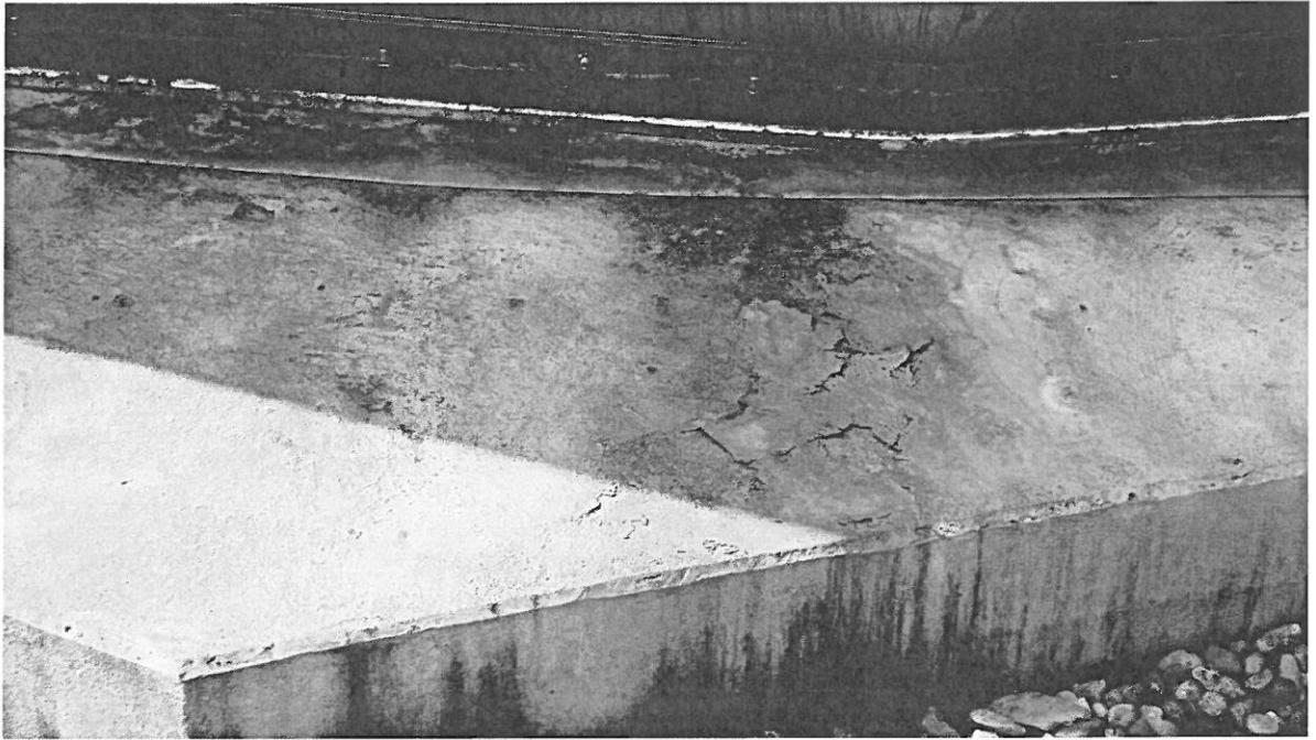
Fot. nr14 – Zbiornik biogazu OB.28 uszkodzenie powłoki
