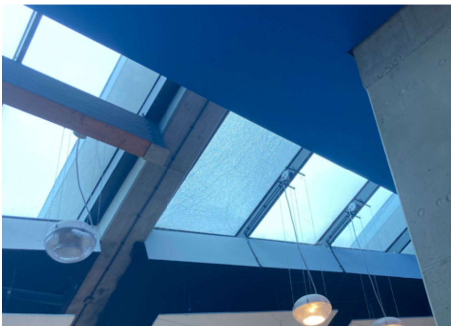
Zdjęcie nr 2. Pęknięta szyba świetlika fasady frontowej
