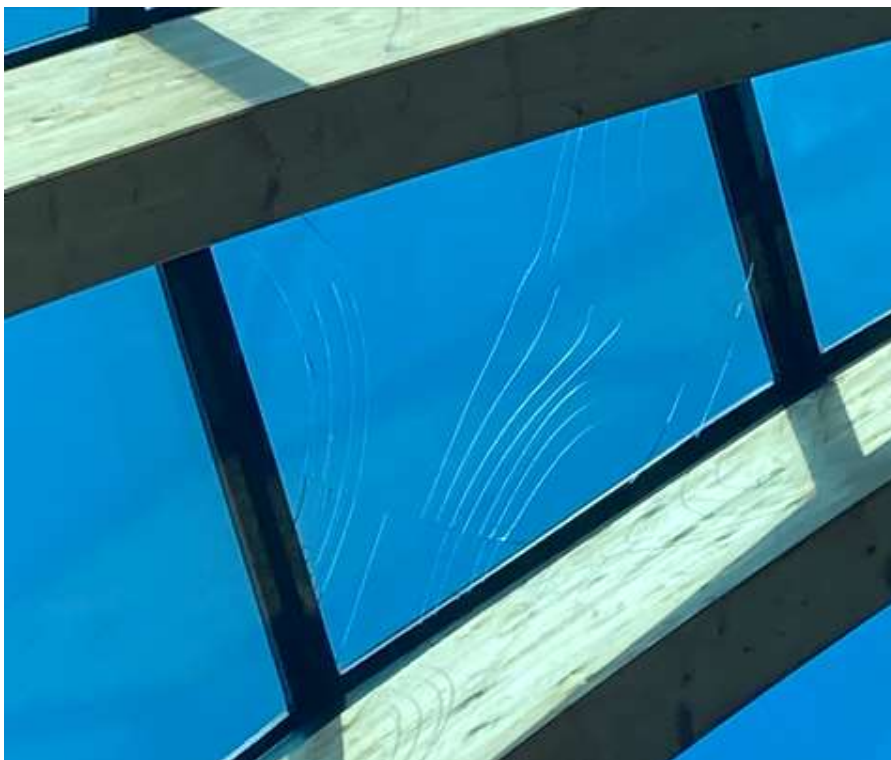
Zdjęcie nr 1. Pęknięta szyba „szklanej kuli”
