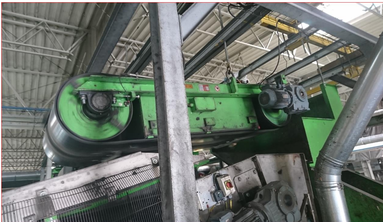
3. Rys. 3 Separator metali żelaznych.
