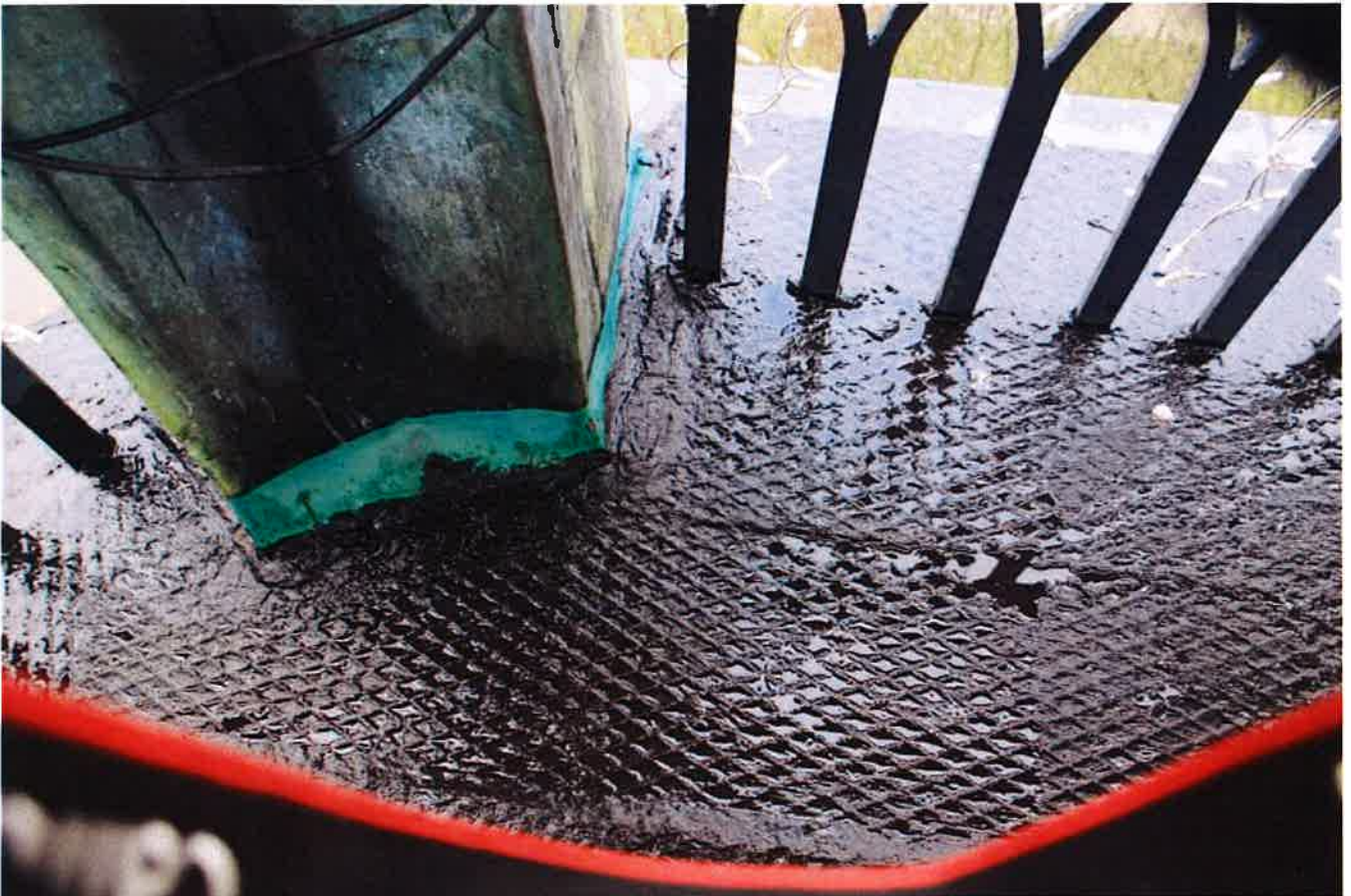
Fot. 30, 31. Pomost na najwyższym poziomie komunikacyjnym. Blacha żeberkowa pomalowana masą bitumiczną wrażliwą na zmiany temperatury. W temperaturze wysokiej nie będzie możliwości wejścia na pomost. Warstwę należy usunąć i blachę pomalować farbą odpowiednią do zastosowań zewnętrznych, niewrażliwą na zmiany temperatury.
