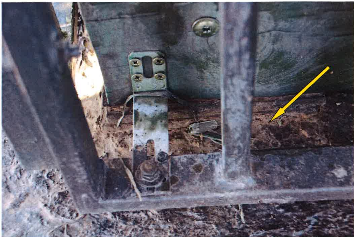
Fot. 35. Korozja stali schodów na poziom widokowy.
