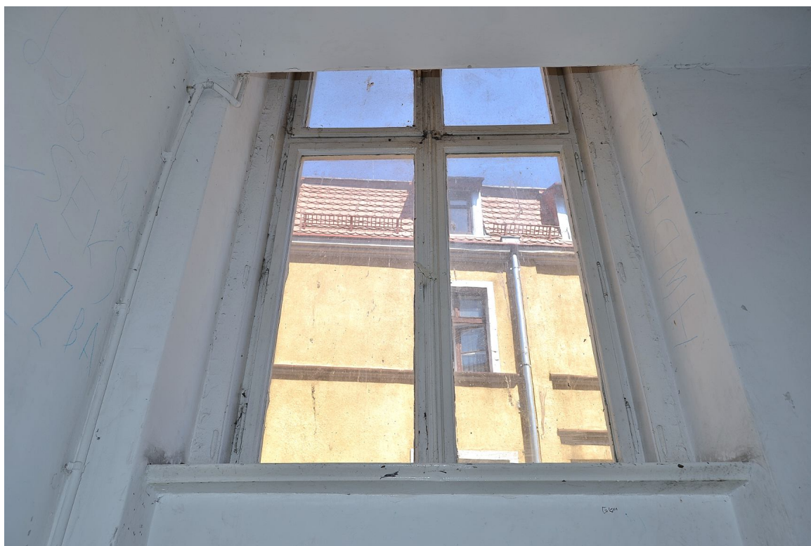
Il. 32 Grudziądz, Kamienica przy ul. Pańskiej 2/ ul. Reja 1- elewacja północna (klatka schodowa) - pierwotna stolarka TYP O/IB – widok na stolarkę okienną - rewers
