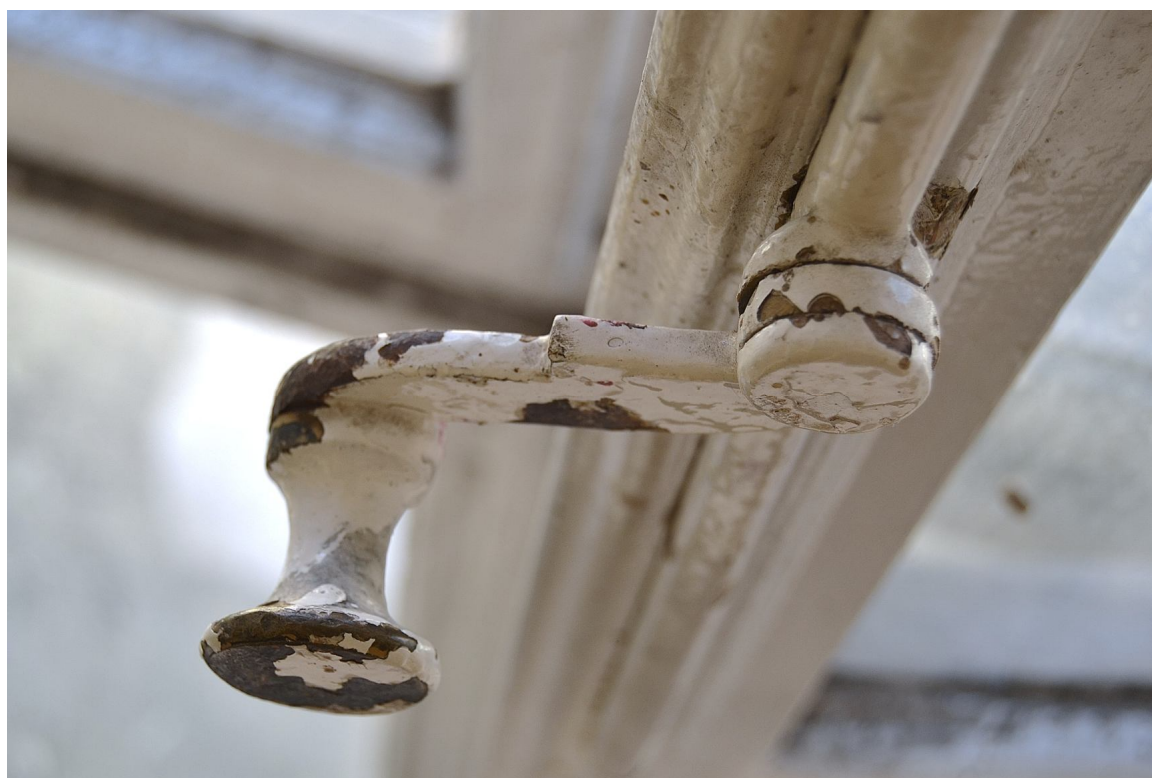
II. 40 Grudziądz, Kamienica przy ul. Pańskiej 2/ ul. Reja 1- elewacja północna (klatka schodowa) - pierwotna stolarka TYP O/IB – widok na fragment zawrotnicy z zakrętką dźwigniową z hakiem fot. Ewa Bożejewicz 2018 r.
