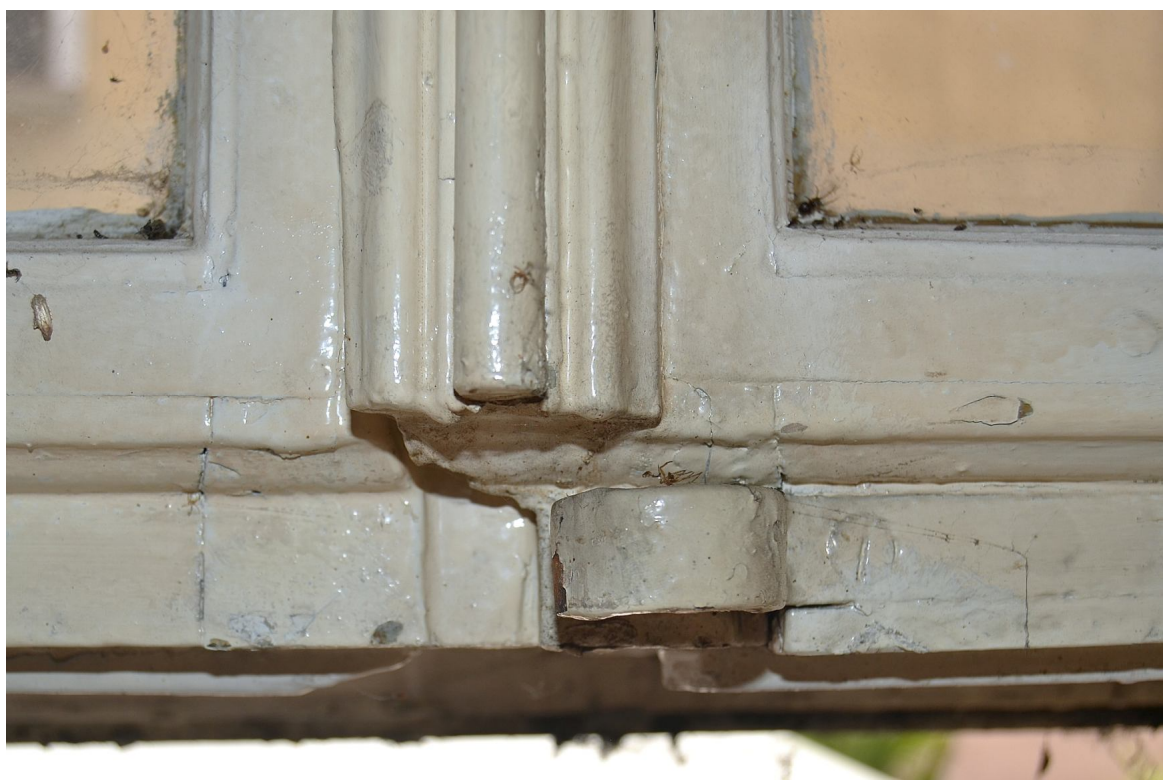
Il. 20 Grudziądz, Kamienica przy ul. Pańskiej 2/ ul. Reja 1- elewacja północna (parter) - pierwotna stolarka TYP O/IA – widok na fragment uszkodzonej zawrotnicy oraz hak fot. Ewa Bożejewicz 2018 r.
