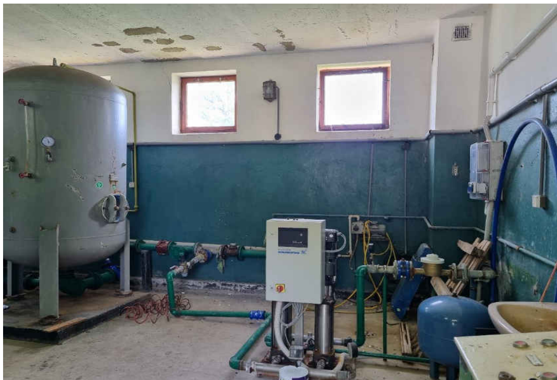
Rys.2 Zdjęcia stanu istniejącego Hydrofornia w Kołowie
