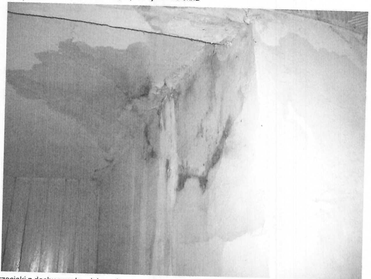
Fot. 8. Przepięki z dachu przy kominie na korytarzu
