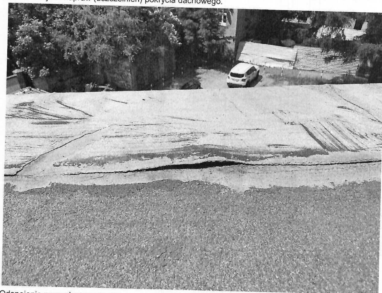
Fot. 12. Odspojenie pasa okapowego papy
