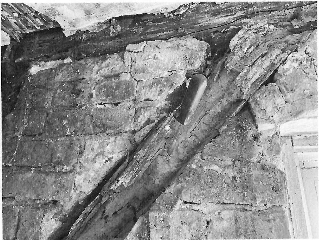
Fot. 6. Szczegół „A” z fot. 4
