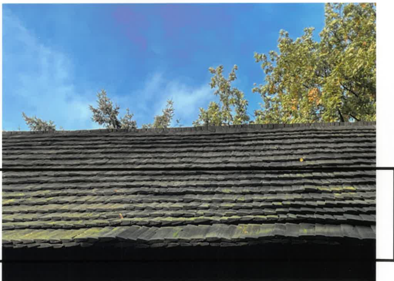
Pokrycie dachu z gontu. Widoczna korozja biologiczna.
