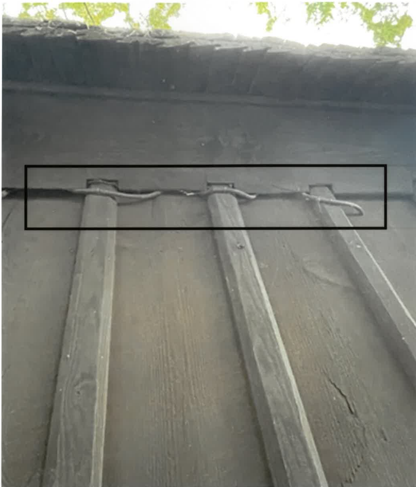
Elewacja wschodnia. Fragment szalowania kościoła z widoczną prowadzoną na zewnątrz instalacją elektryczną.
