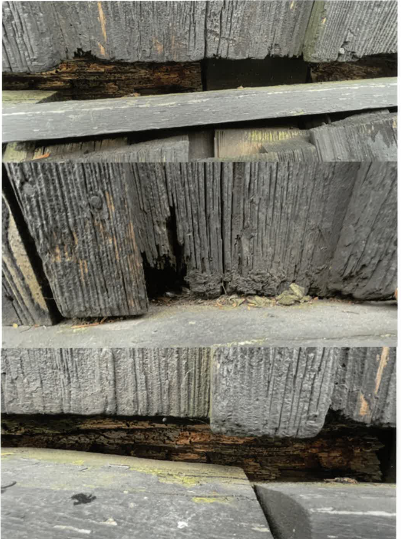
Widoczny fragment spróchniałych belek podwalinowych.
